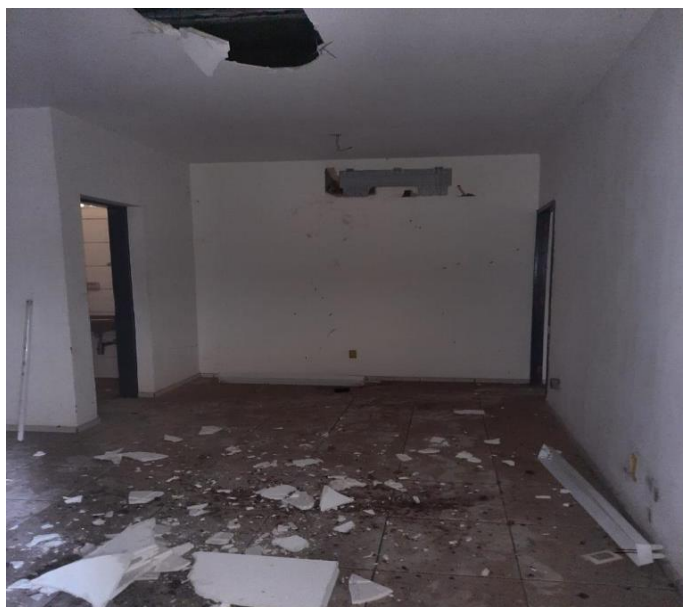
Figura 1 sala/ teto avariado por conta de arrombamentos
