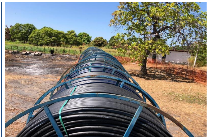
Imagem 64 Duto flexível de telecomunicações em PEAD
