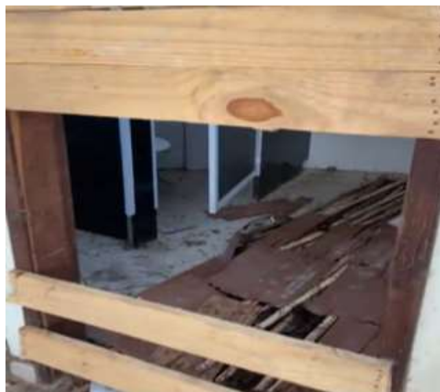
Condições das portas
