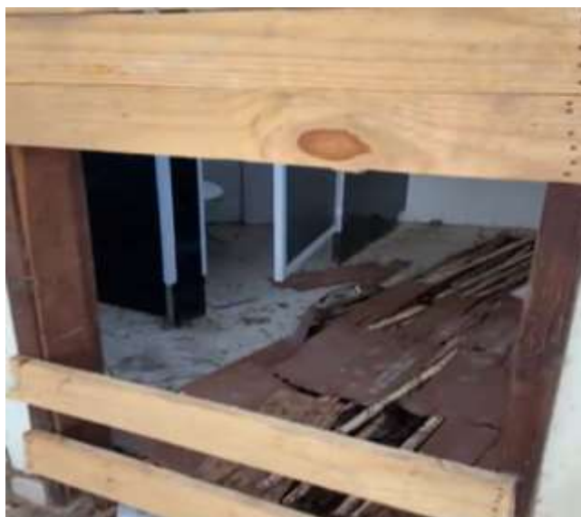
Condições das portas
