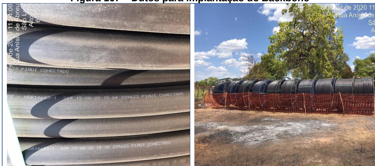
Figura 167 – Dutos para implantação do Backbone
