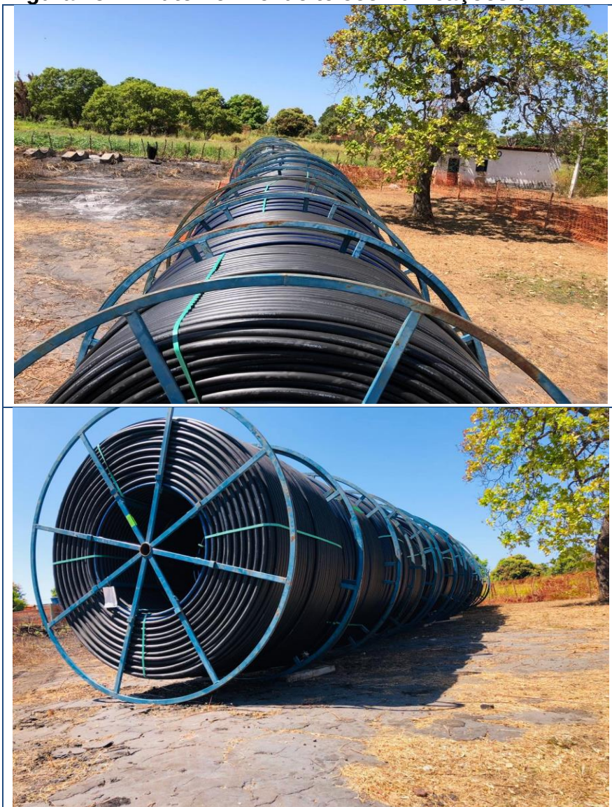
Figura 151 – Duto flexível de telecomunicações em PEAD
