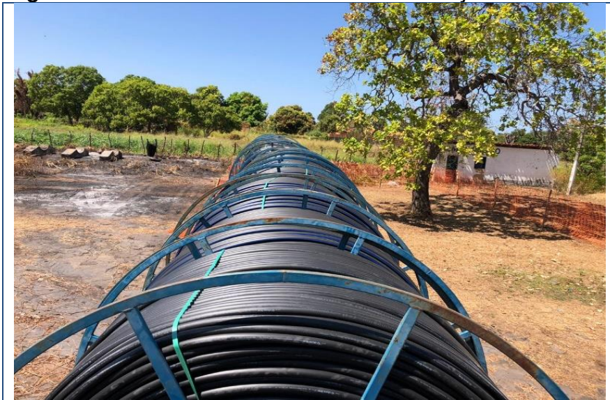
Figura 175 – Duto flexível de telecomunicações em PEAD
