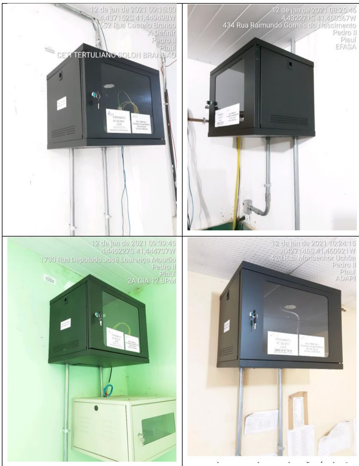
Figura 35 – Registro de inspeção de não conformidades nas instalações das unidades com internet.
