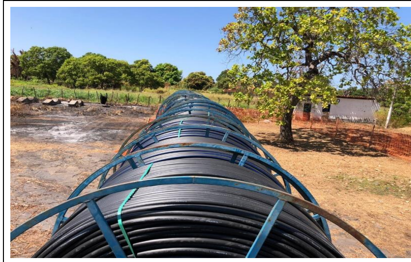
Figura 52 – Duto flexível de telecomunicações em PEAD
