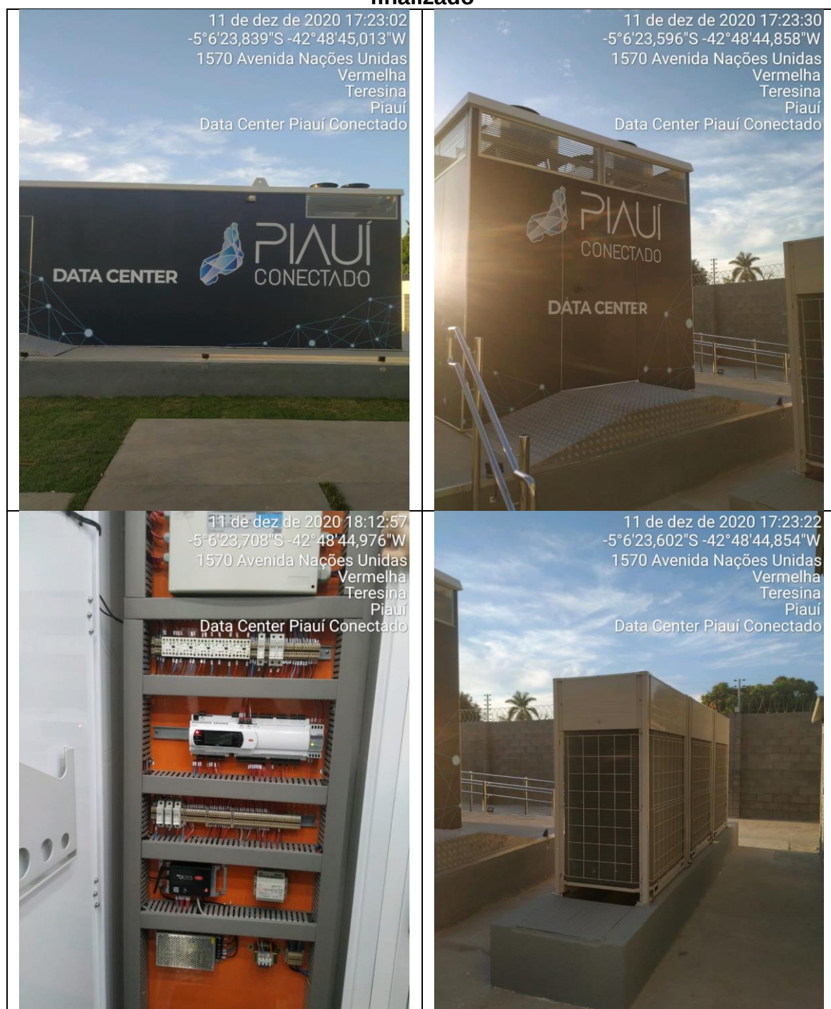
Figura 64 – Centro de Operação e Rede da Piauí Conectado e Datacenter finalizado
