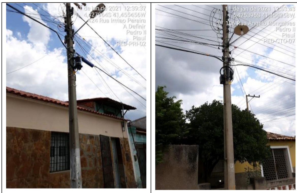
Figura 11 – Inspeção de não conformidades no lançamento da fibra óptica.
