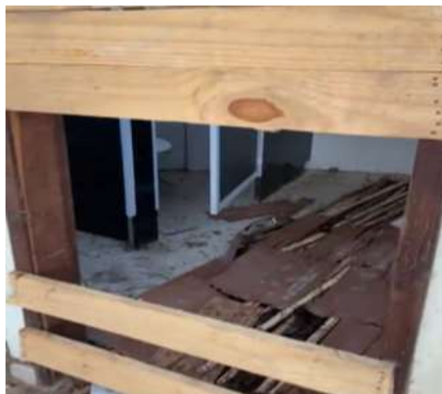
Condições das portas
