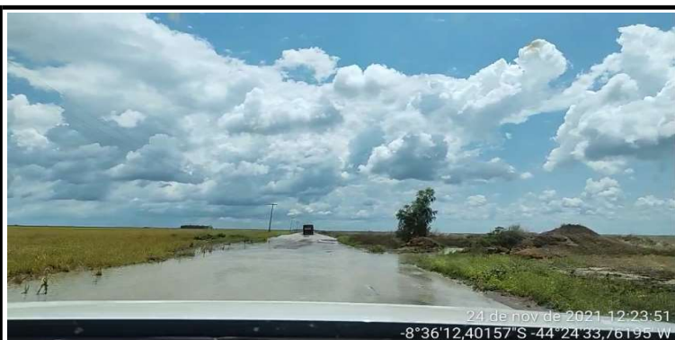
Alagamento comprometendo totalmente a pista.
