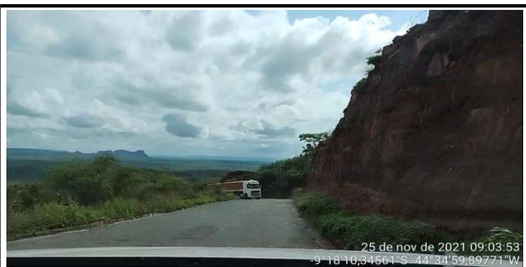
Ausência de guarda-corpo no leito da pista. Ausência de sinalização horizontal e vertical.
