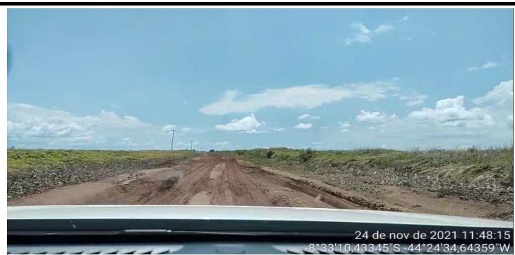
Início do segmento homogêneo 5 - trecho não pavimentado. Dificil acesso para veículos.
