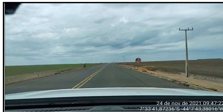
Trecho com a sinalização vertical e horizontal danificados.
