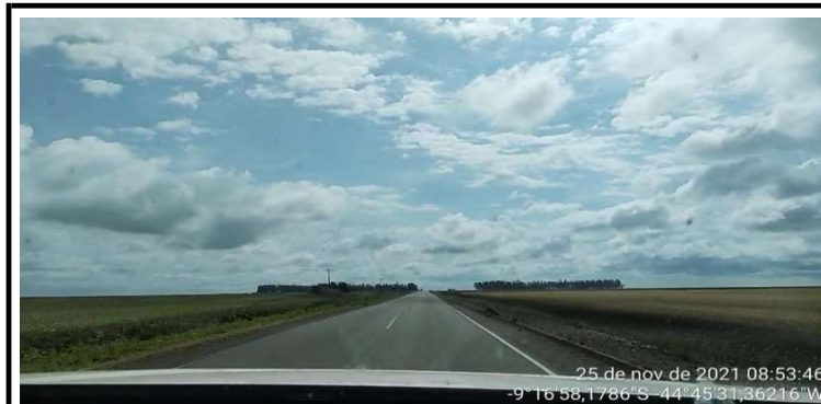
Sinalização horizontal danificada.
