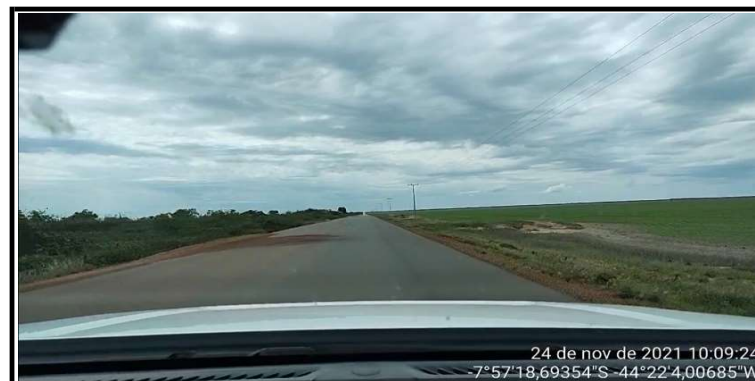
Buraco de grande proporção comprometendo meia pista.
