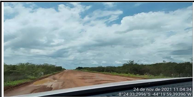
Trecho pavimentado, com buracos e pontos de alagamento comprometendo a pista.
