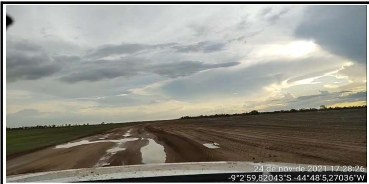
Início do segmento homogêneo 7 - buracos de grande proporção comprometendo boa parte da pista.
