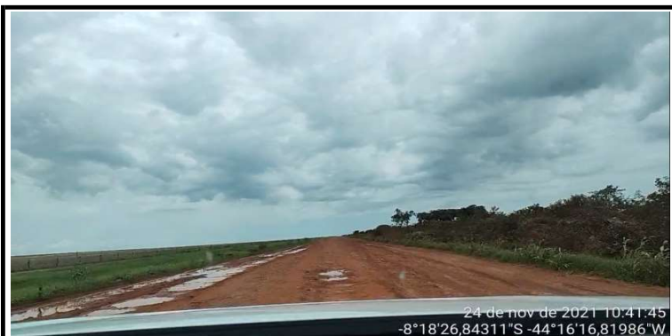
Trecho com pontos de alagamento no leito da pista.
