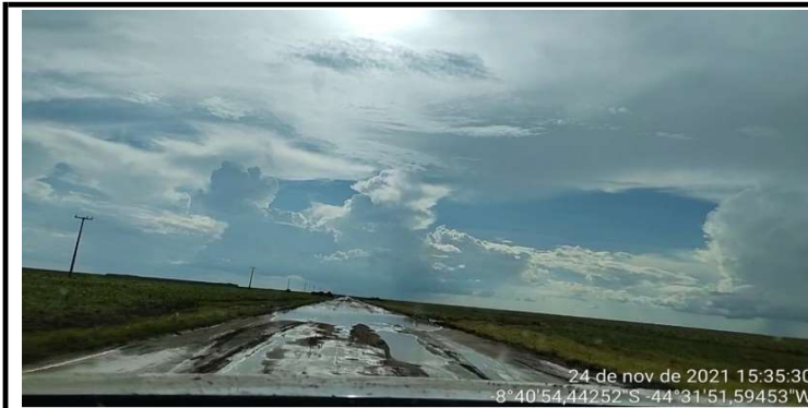
Atoleiro em trecho da pista.
