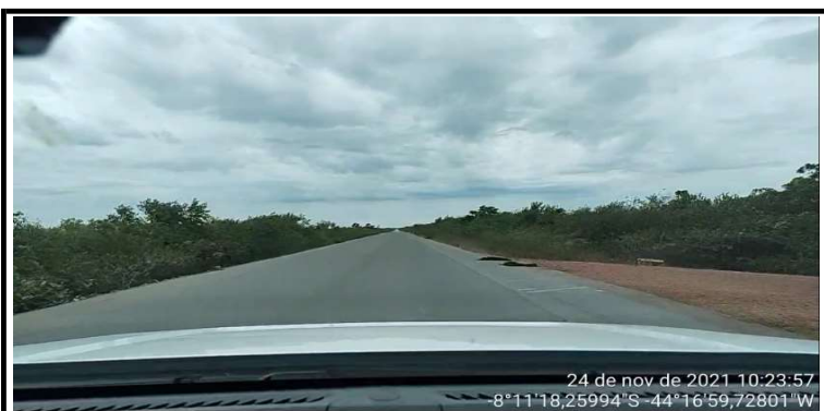
Ausência de sinalização horizontal.
