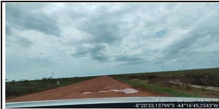
Trecho com buraco de grande proporção comprometendo meia pista.
