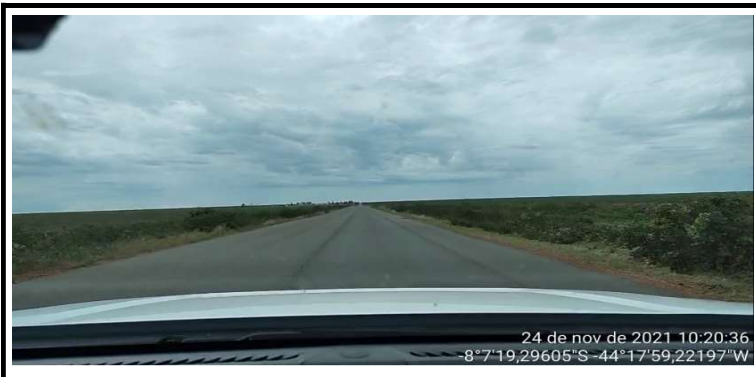
Início do segmento homogêneo 2 - trecho com diferença de nível do pavimento na pista.
