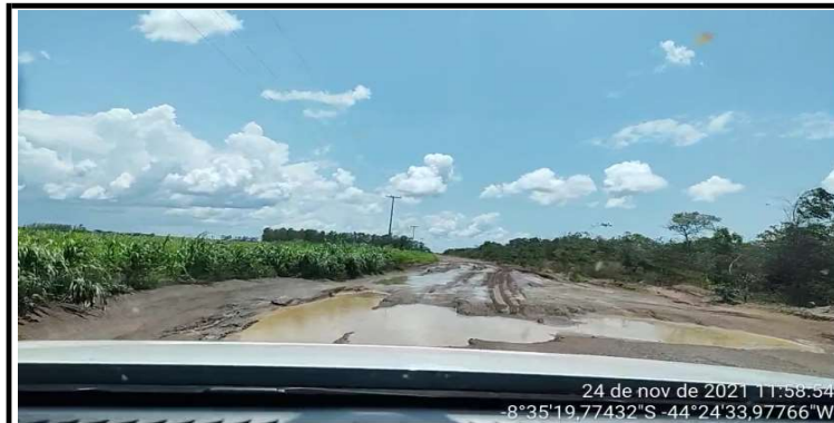
Buracos de grande proporção comprometendo grande parte da pista. Vegetação crescente no leito da pista.
