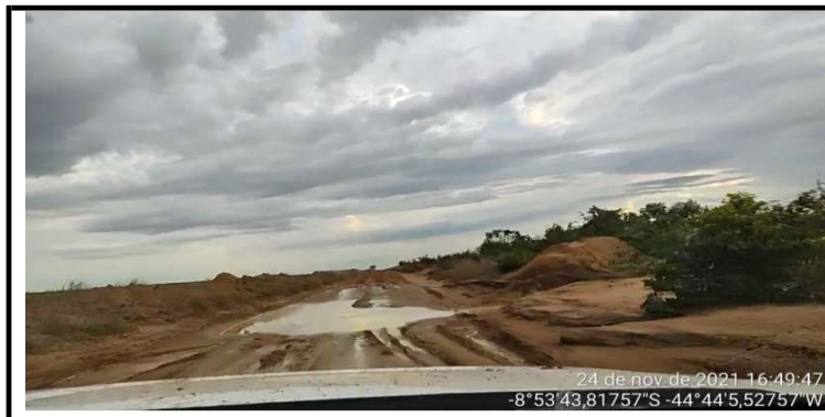
Buraco de grande proporção comprometendo toda a pista.
