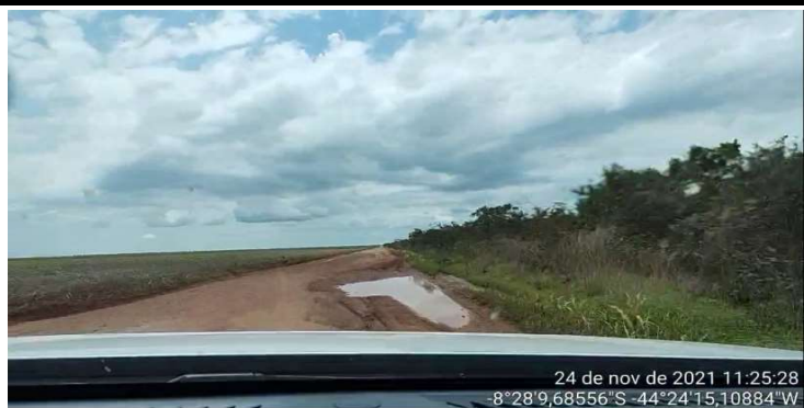
Início do segmento homogêneo 4 – buraco alagado de grande proporção comprometendo meia pista.
