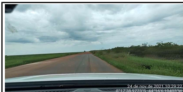
Final do segmento homogêneo 2 - Aumento de vegetação nos leitos da pista. Ainda com a ausência de sinalização horizontal.
