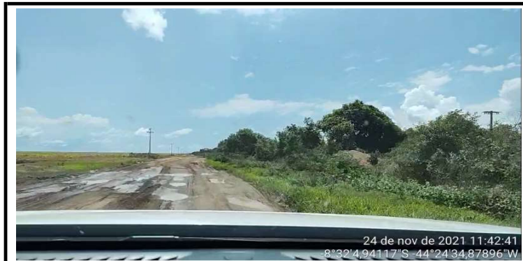
Final do segmento homogêneo 4 – trecho com pontos de alagamento comprometendo a pista.
