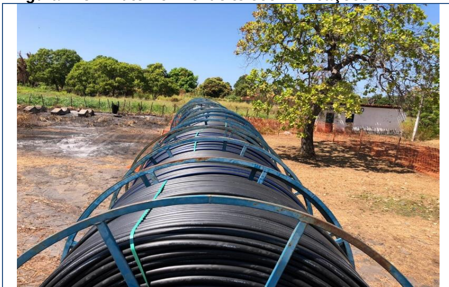
Figura 175 – Duto flexível de telecomunicações em PEAD
