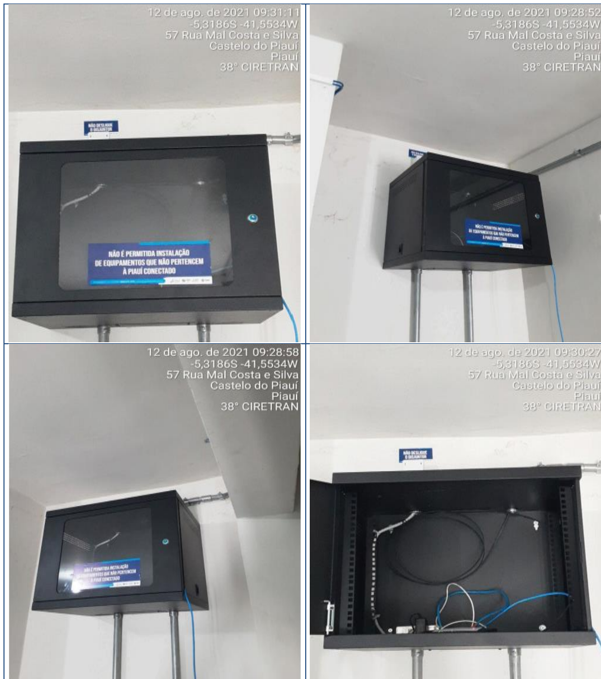
Figura 56 – PAG 38° CIRETRAN: NÃO CONFORME – Ausência de adesivo com identificação do rack – Castelo do Piauí
