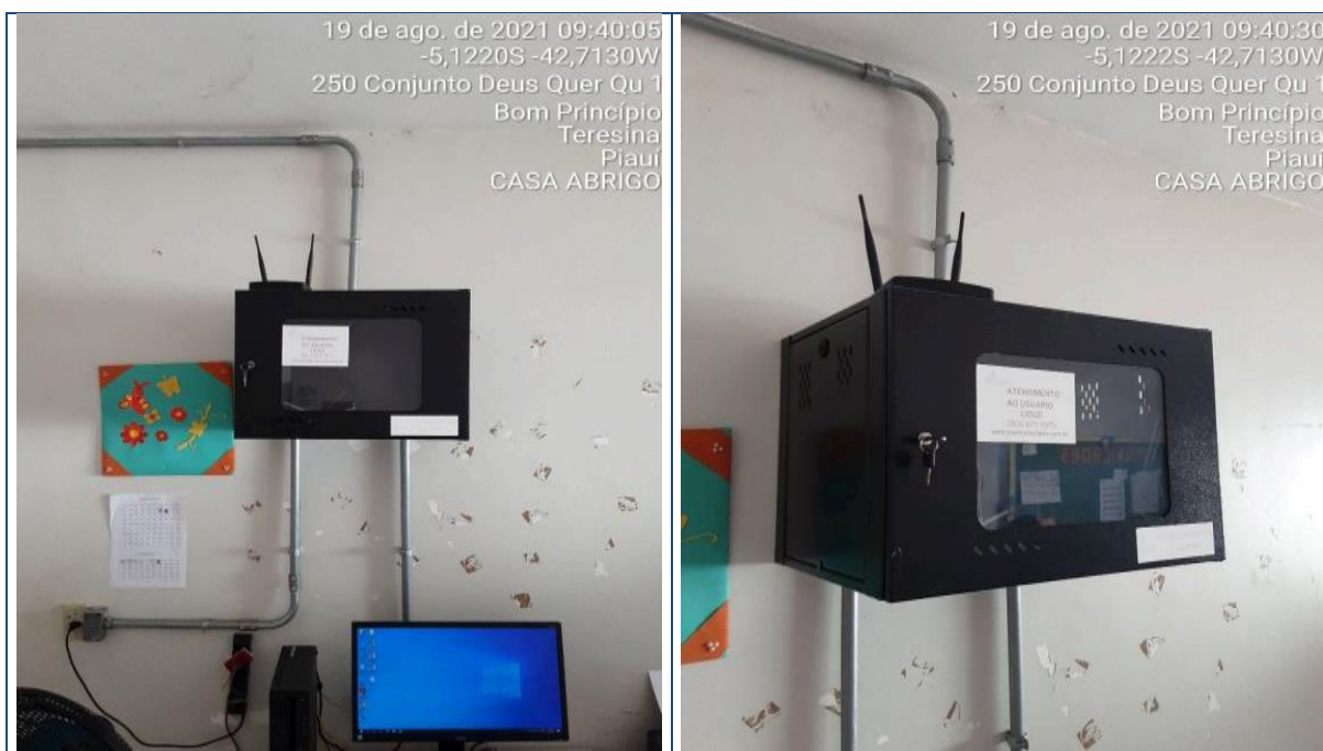
Figura 70 – PAG Casa Abrigo: NÃO CONFORME – Ausência de adesivo com identificação do rack – Teresina
