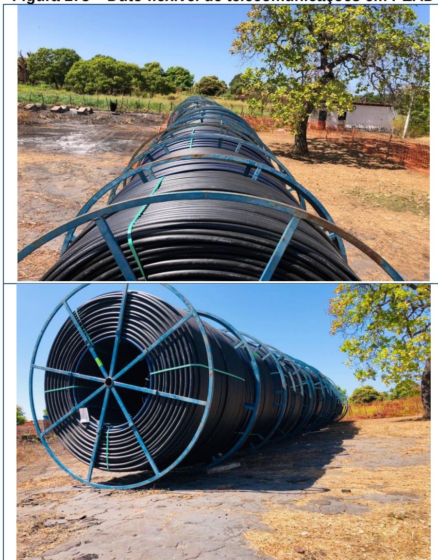
Figura 173 – Duto flexível de telecomunicações em PEAD
