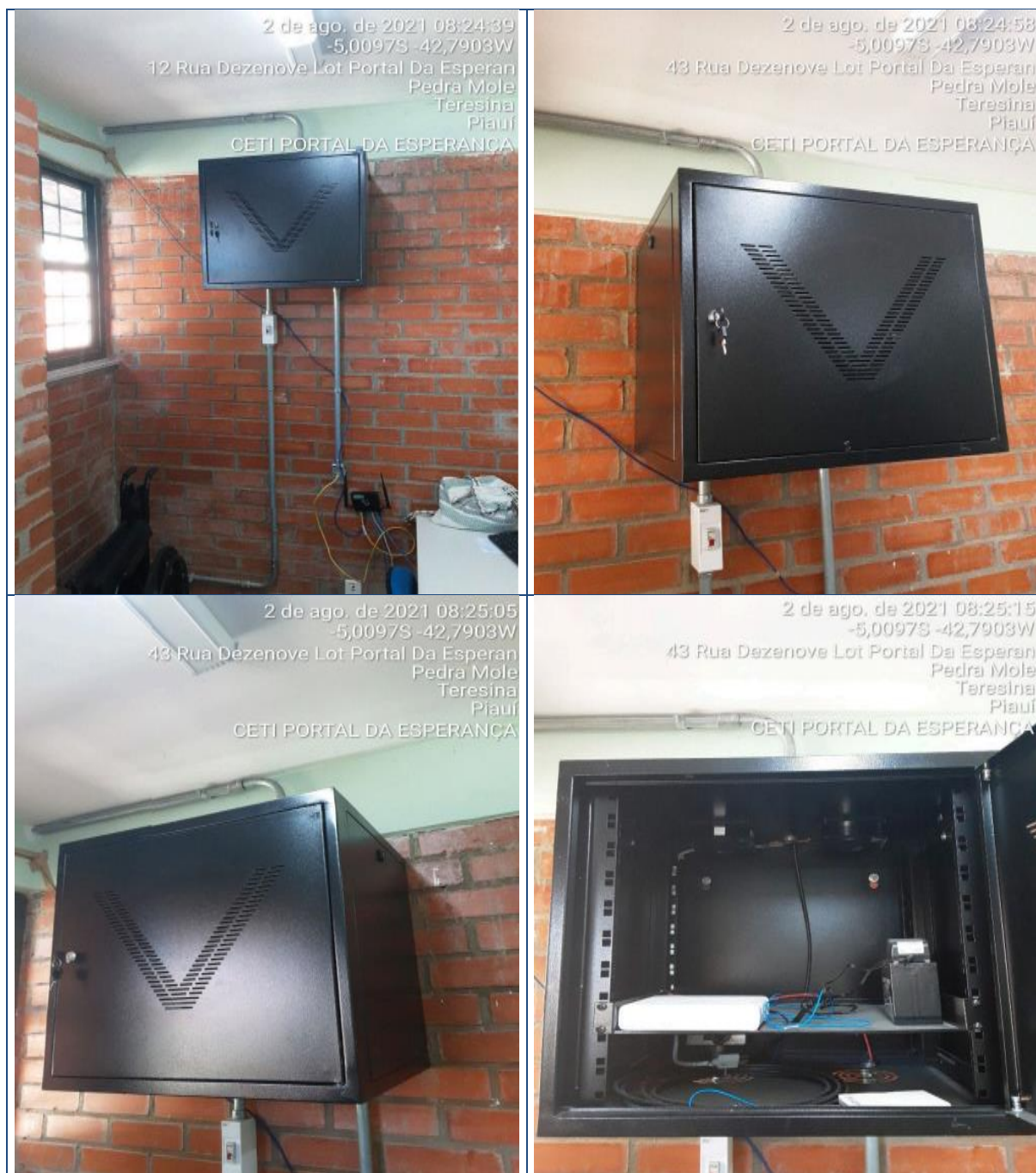
Figura 55 – PAG CETI Portal da Esperança: NÃO CONFORME – Ausência de adesivo com identificação do rack e contato para suporte – Teresina
