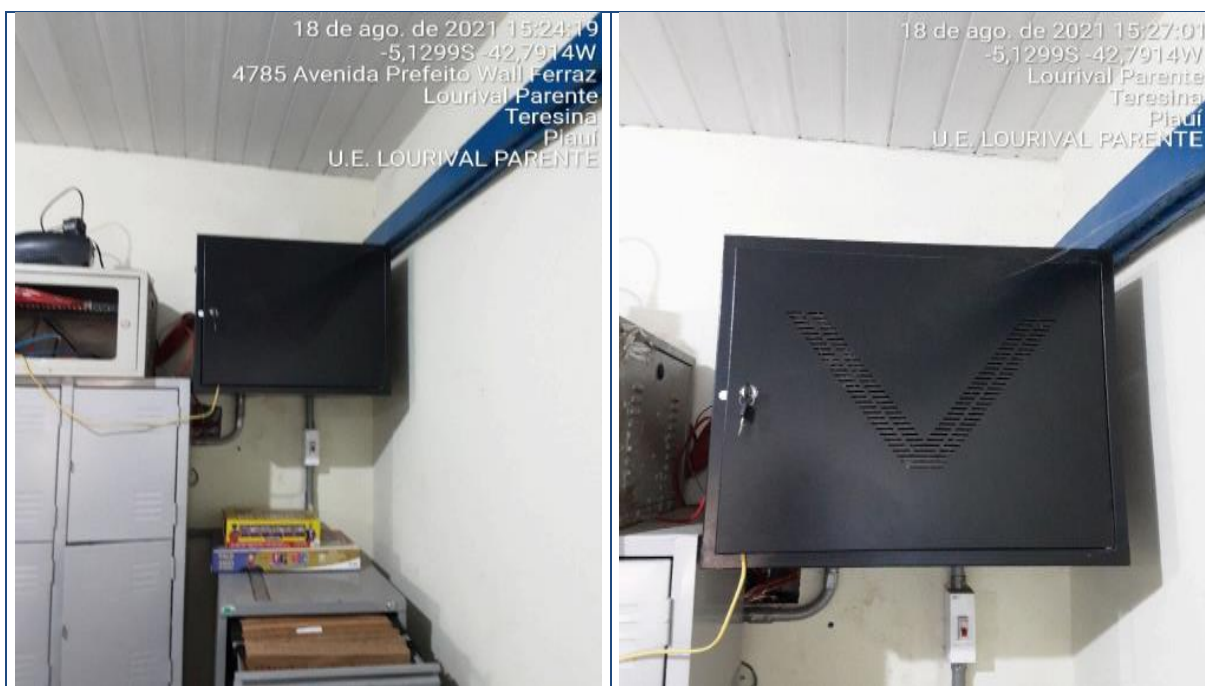
Figura 72 – PAG U.E. Lourival Parente: NÃO CONFORME – Ausência de adesivo com contato para suporte no rack – Teresina
