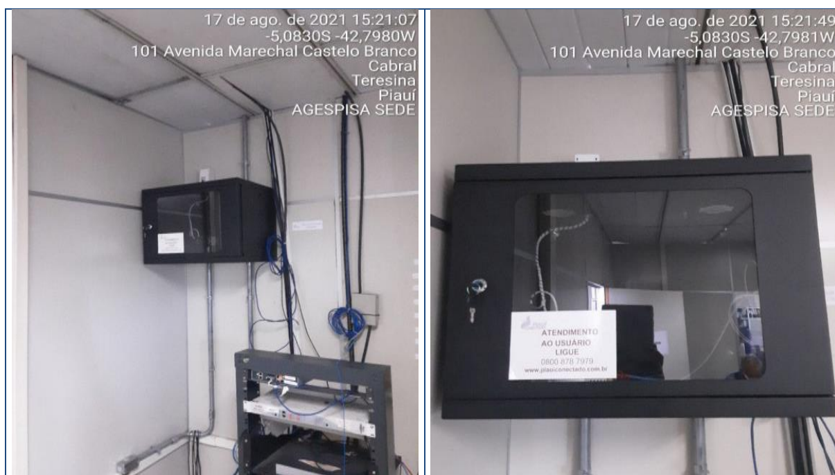
Figura 69 – PAG AGESPISA Sede: NÃO CONFORME – Ausência de adesivo com identificação do rack – Teresina
