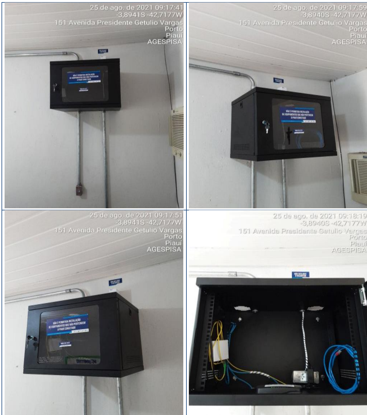
Figura 57 – PAG AGESPISA: NÃO CONFORME – Ausência de adesivo com identificação do rack – Porto
