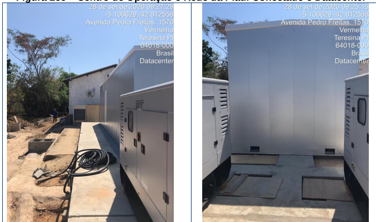
Figura 266 – Centro de Operação e Rede da Piauí Conectado e Datacenter
