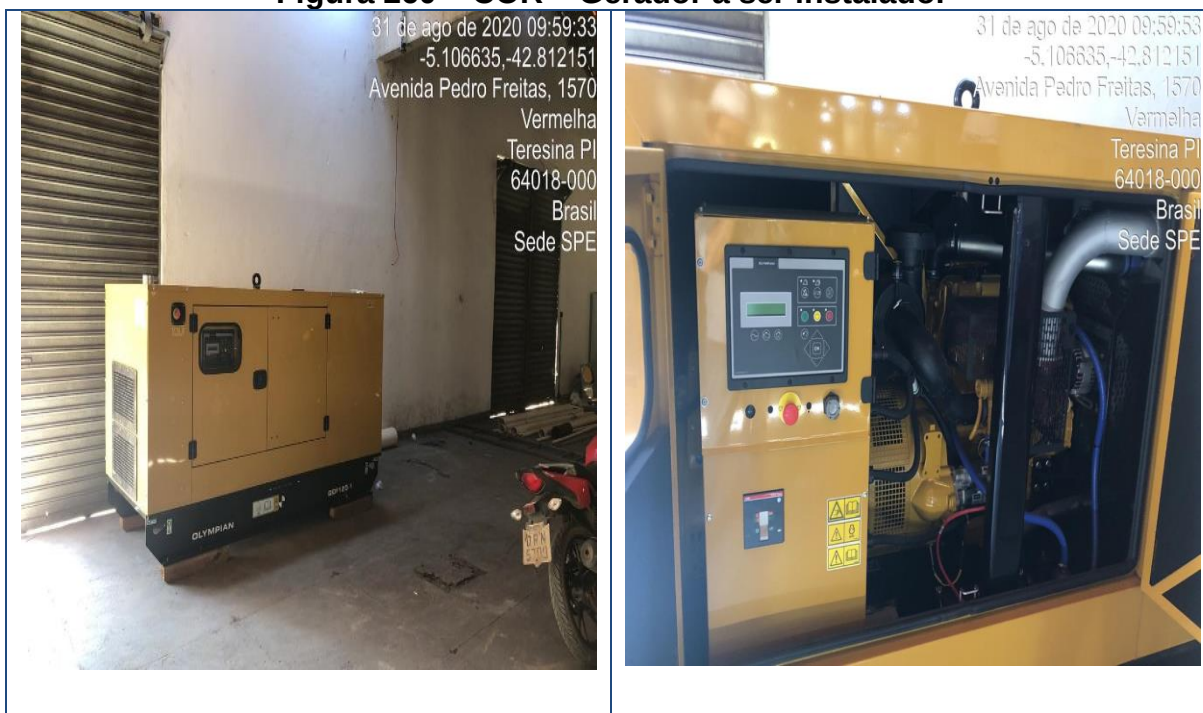
Figura 260 – COR – Gerador a ser instalado.
