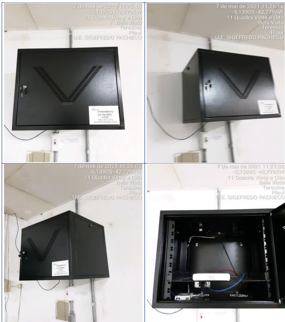
Figura 74 – PAG U.E. Sigfredo Pacheco: NÃO CONFORME – Ausência de adesivo com identificação do rack – Teresina
