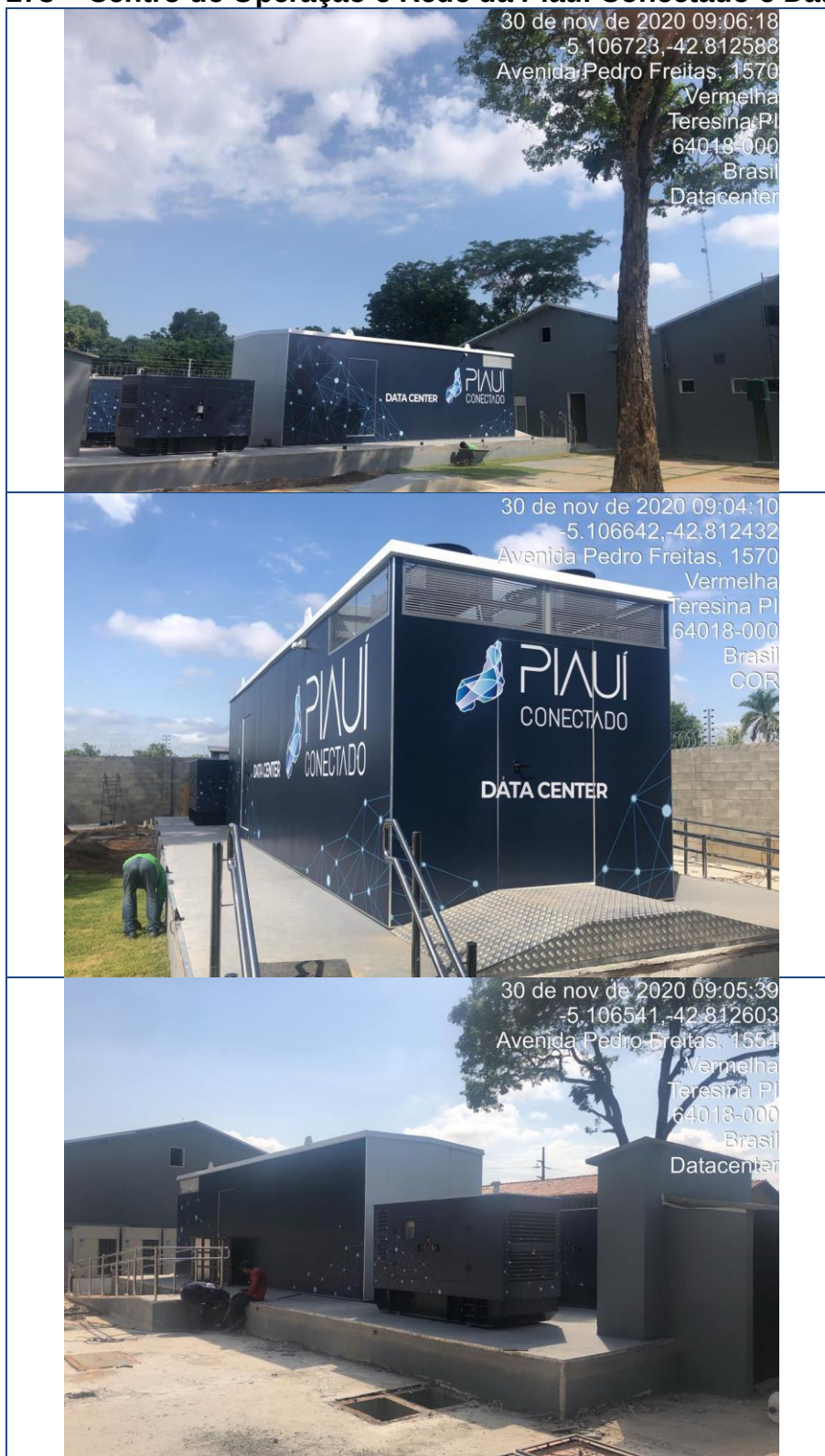
Figura 278 – Centro de Operação e Rede da Piauí Conectado e Datacenter
