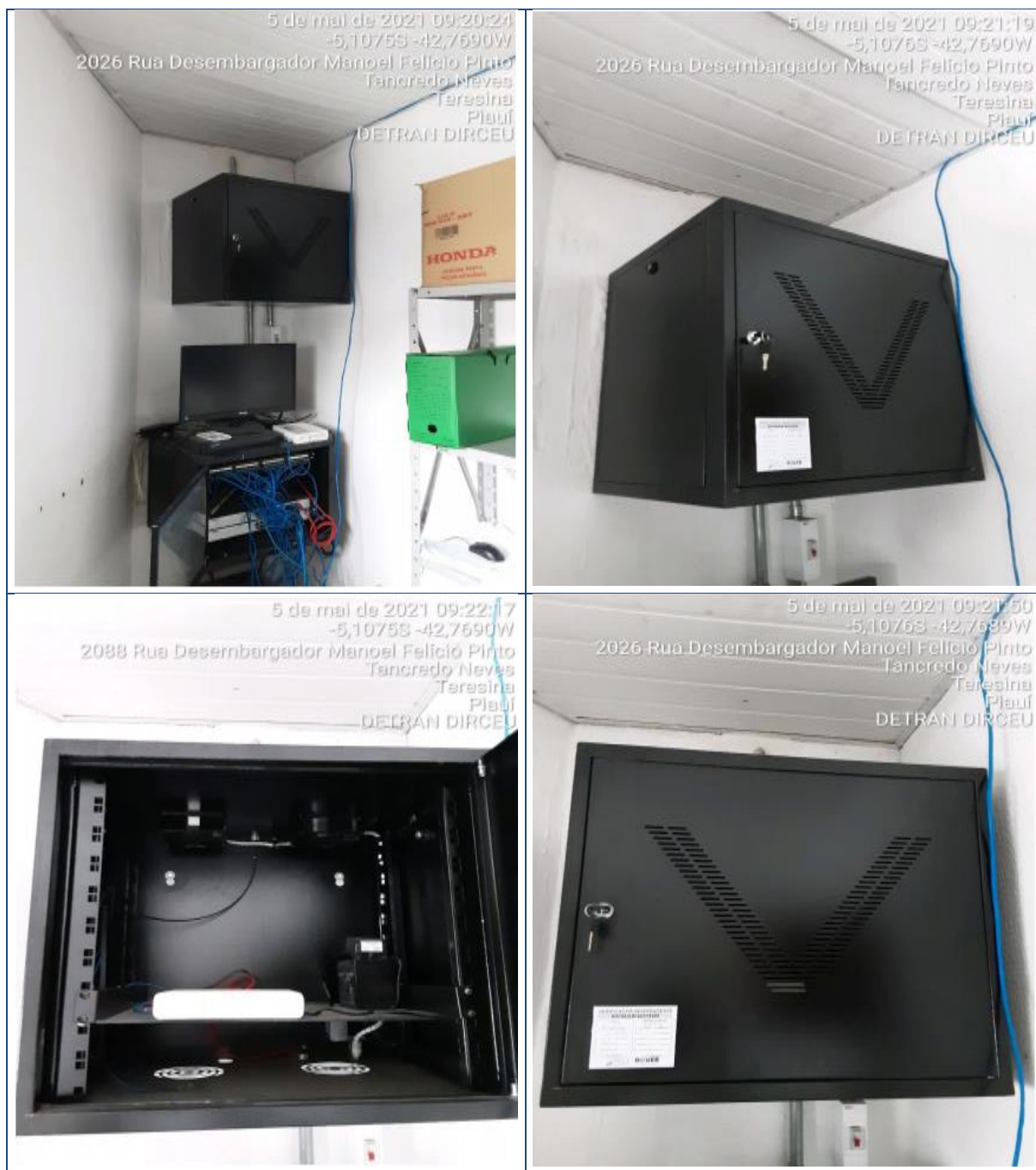
Figura 73 – PAG DETRAN DIRCEU: NÃO CONFORME – Ausência de adesivo com identificação do rack e contato para suporte – Teresina
