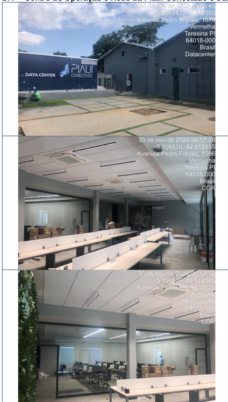
Figura 277 – Centro de Operação e Rede da Piauí Conectado e Datacenter
