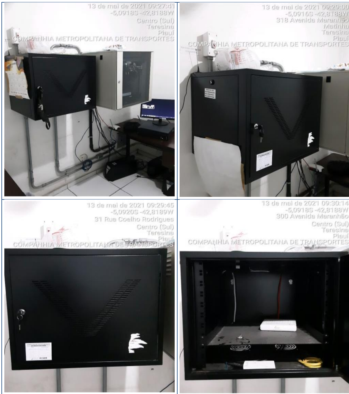
Figura 75 – PAG Companhia Metropolitana de Transportes: NÃO CONFORME – Ausência de adesivo com contato para suporte no rack – Teresina
