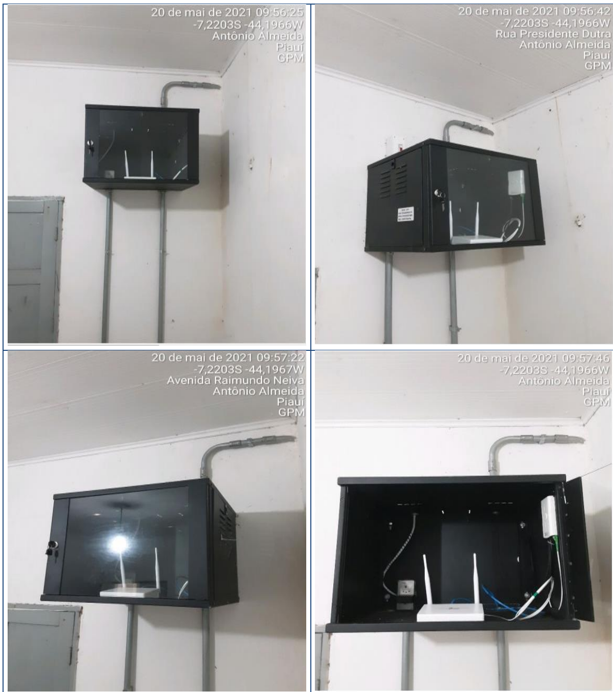
Figura 77 – PAG GPM: NÃO CONFORME – Ausência de adesivo com contato para suporte no rack – Antônio Almeida
