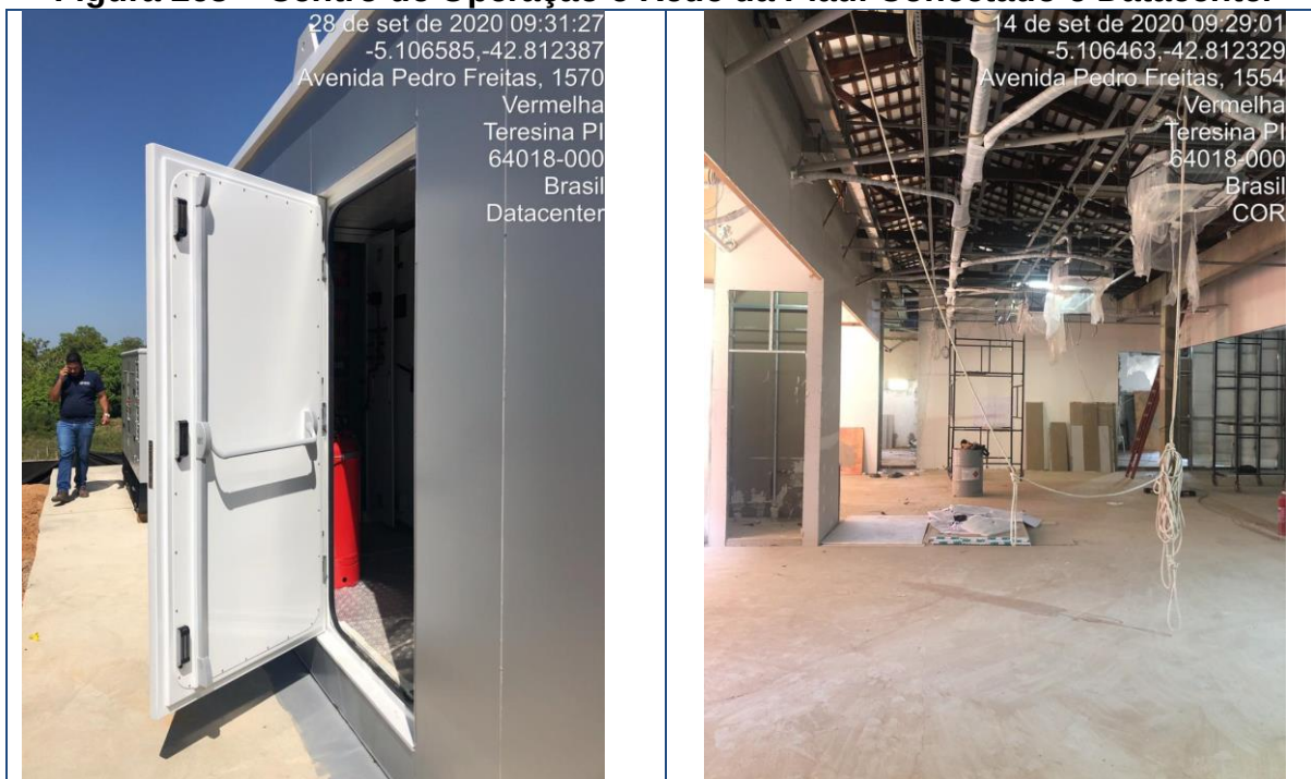
Figura 263 – Centro de Operação e Rede da Piauí Conectado e Datacenter
