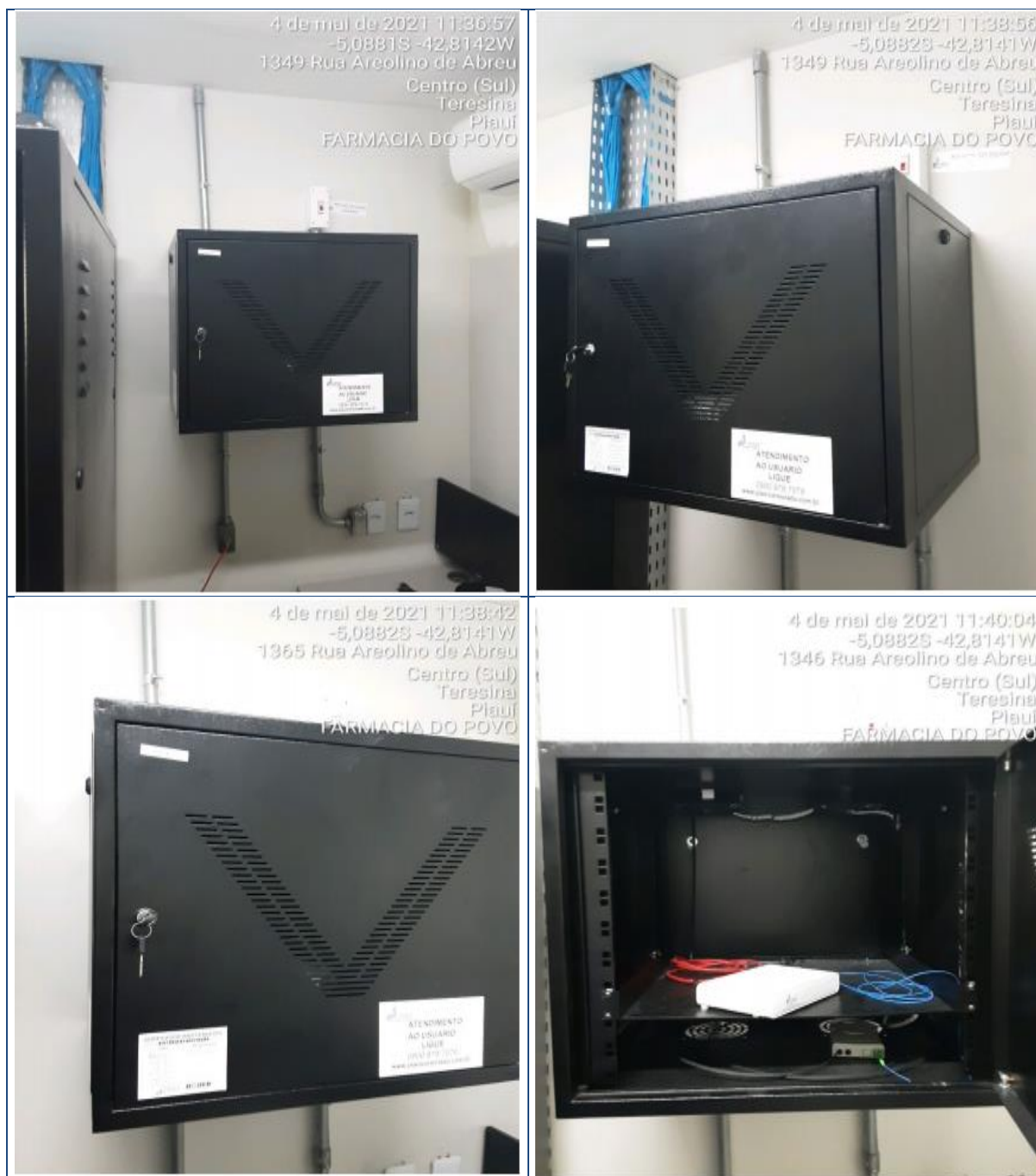
Figura 72 – PAG Farmácia do Povo: NÃO CONFORME – Ausência de adesivo com identificação do rack – Teresina
