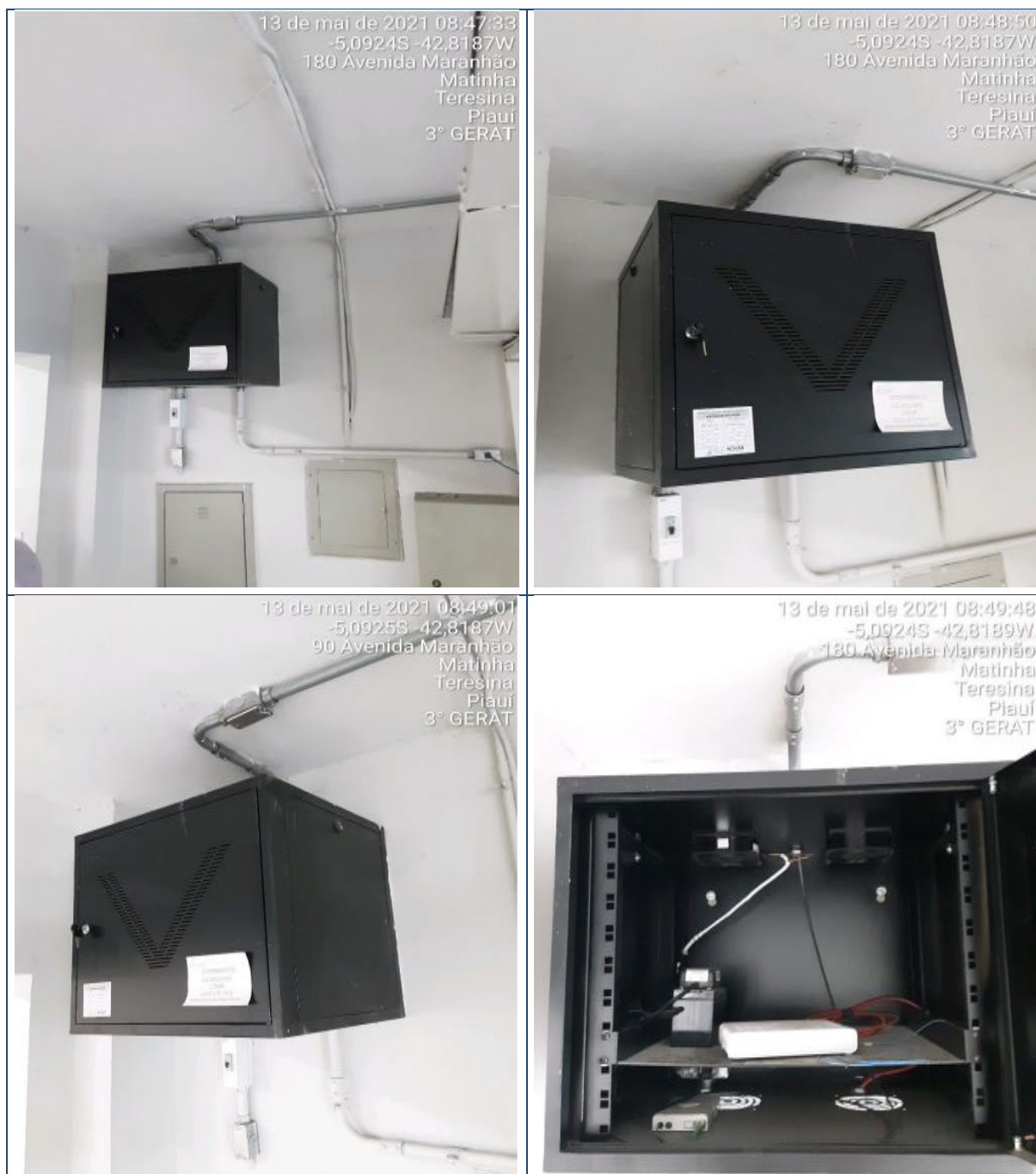
Figura 90 – PAG 3º GERAT: NÃO CONFORME – Ausência de adesivo com identificação do rack – Teresina
