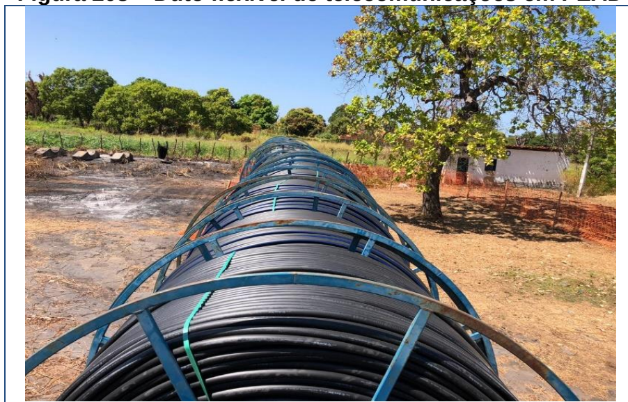
Figura 208 – Duto flexível de telecomunicações em PEAD
