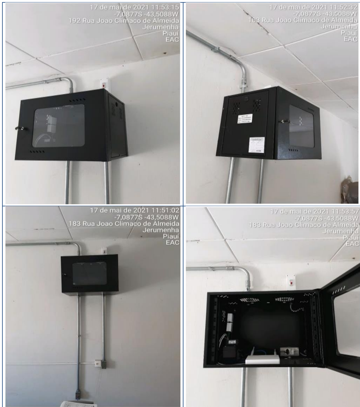
Figura 76 – PAG EAC: NÃO CONFORME – Ausência de adesivo com contato para suporte no rack – Jerumenha
