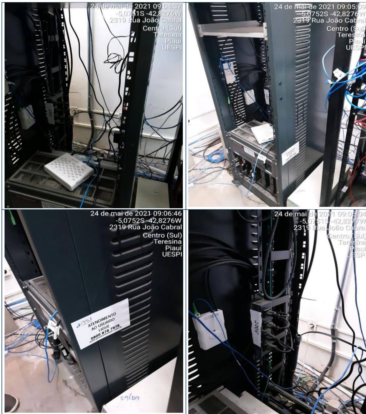
Figura 91 – PAG UESPI: NÃO CONFORME – Ausência de adesivo com identificação do rack e disjuntor de proteção elétrica – Teresina
