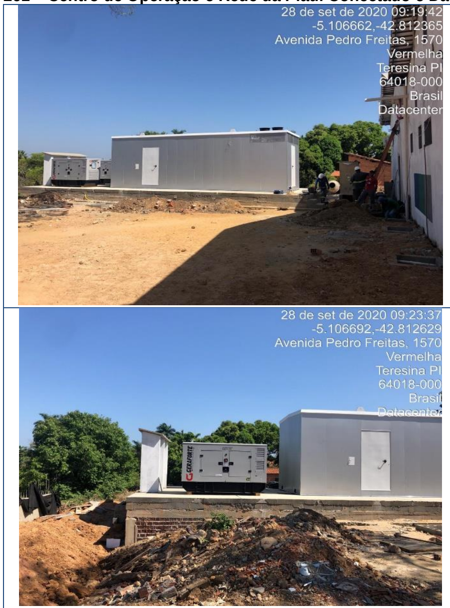
Figura 261 – Centro de Operação e Rede da Piauí Conectado e Datacenter
