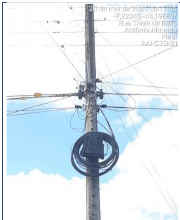
Figura 35 – AAI-CTO-01 – Reserva Técnica aplicada incorretamente: Reserva Técnica sem cruzeta – Antônio Almeida
