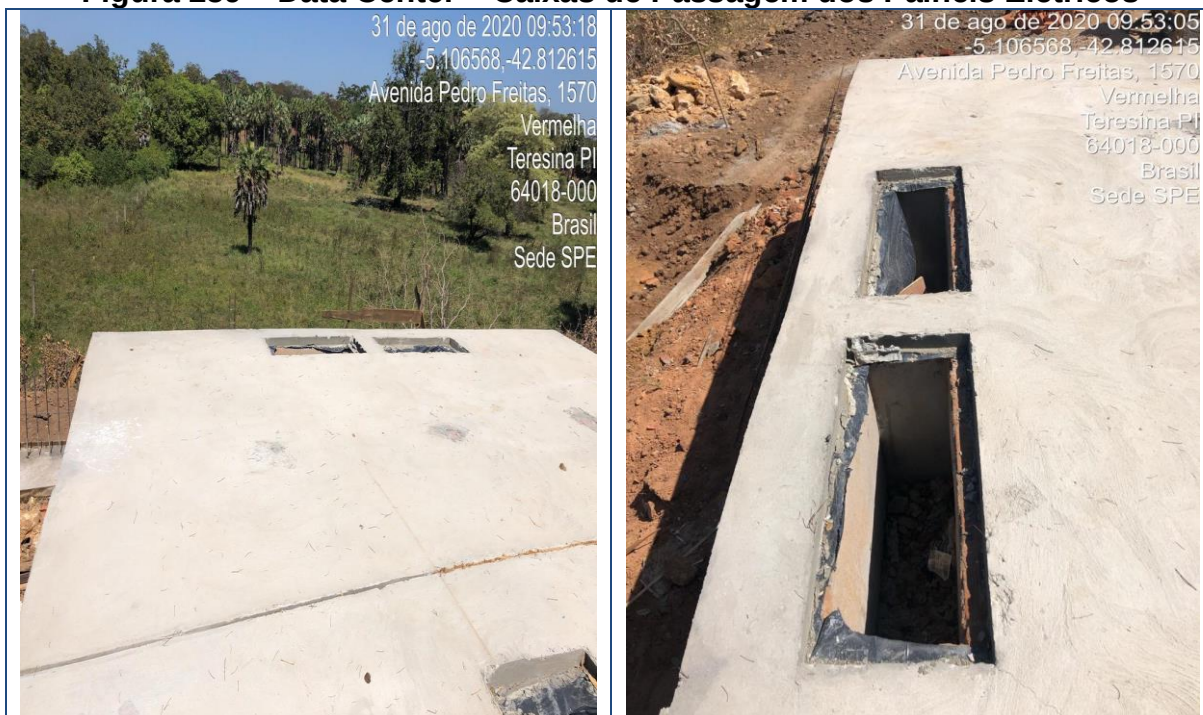
Figura 259 – Data Center – Caixas de Passagem dos Painéis Elétricos
