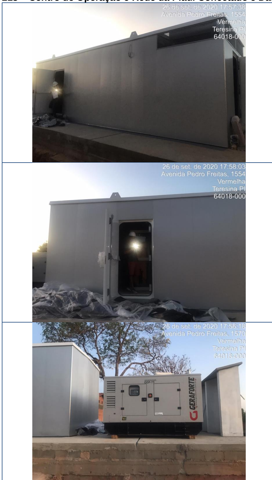
Figura 218 – Centro de Operação e Rede da Piauí Conectado e Datacenter
