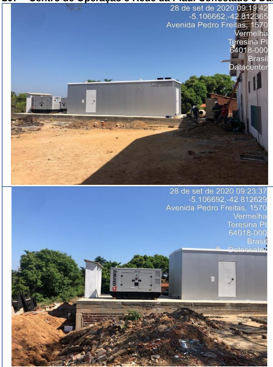
Figura 207 – Centro de Operação e Rede da Piauí Conectado e Datacenter
