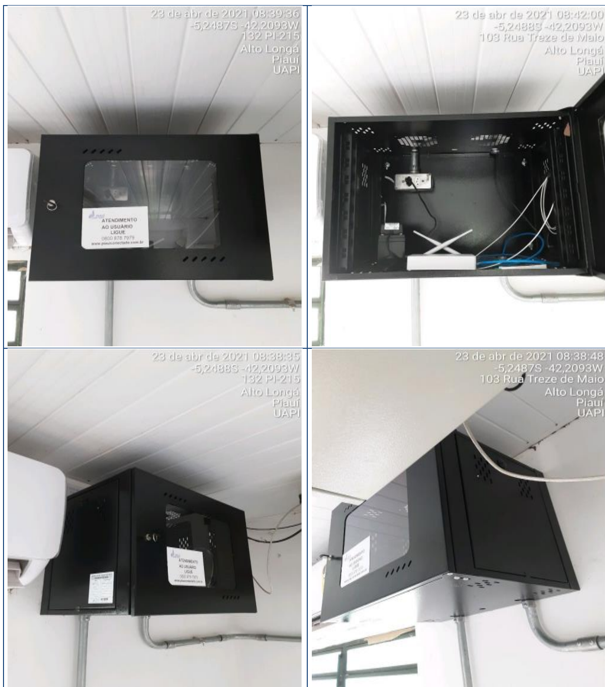
Figura 96 – PAG UAPI: NÃO CONFORME – Ausência de adesivo com identificação do rack – Alto Longá
