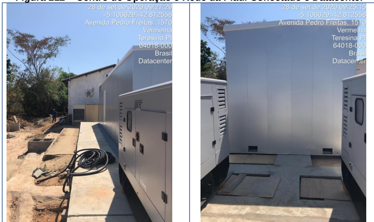
Figura 212 – Centro de Operação e Rede da Piauí Conectado e Datacenter
