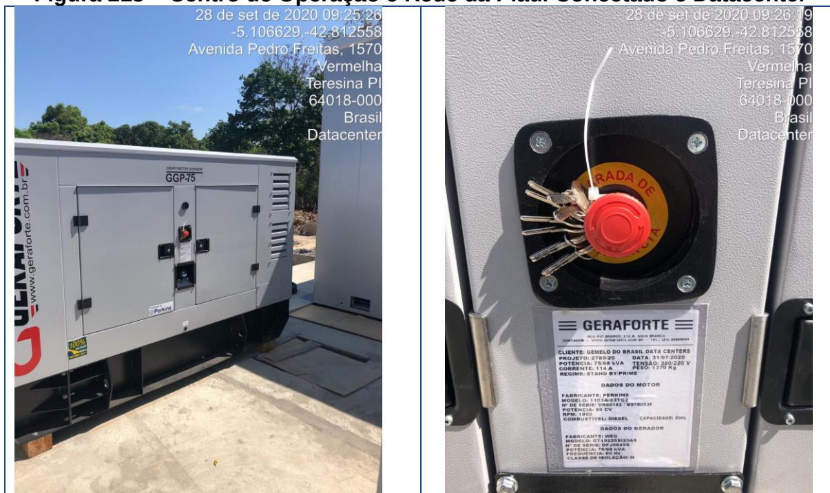
Figura 213 – Centro de Operação e Rede da Piauí Conectado e Datacenter
