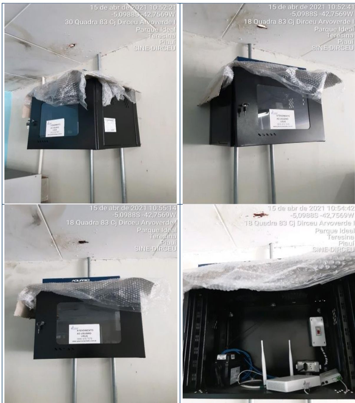
Figura 98 – PAG SINE - Dirceu: NÃO CONFORME – Ausência de adesivo com identificação do rack – Teresina
