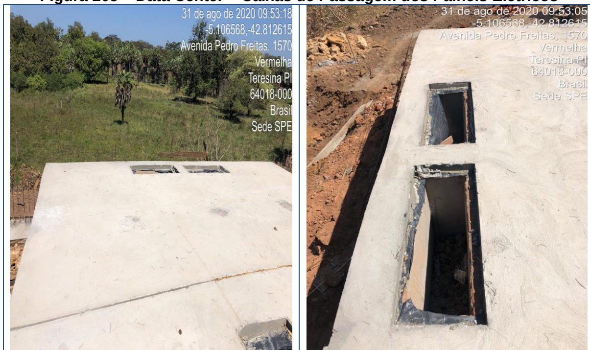
Figura 205 – Data Center – Caixas de Passagem dos Painéis Elétricos
