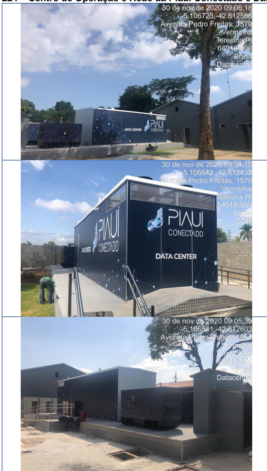
Figura 224 – Centro de Operação e Rede da Piauí Conectado e Datacenter
