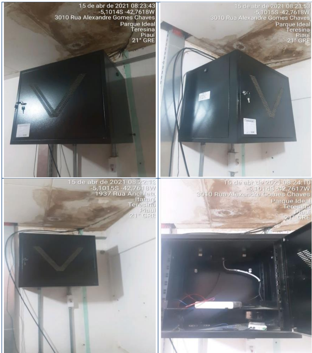
Figura 97 – PAG 21º GRE: NÃO CONFORME – Ausência de adesivo com contato para suporte no rack – Teresina
