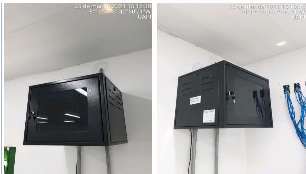
Figura 143 – PAG UAPI: NÃO CONFORME – Ausência de adesivo com contato para suporte no rack – Brejo do Piauí
