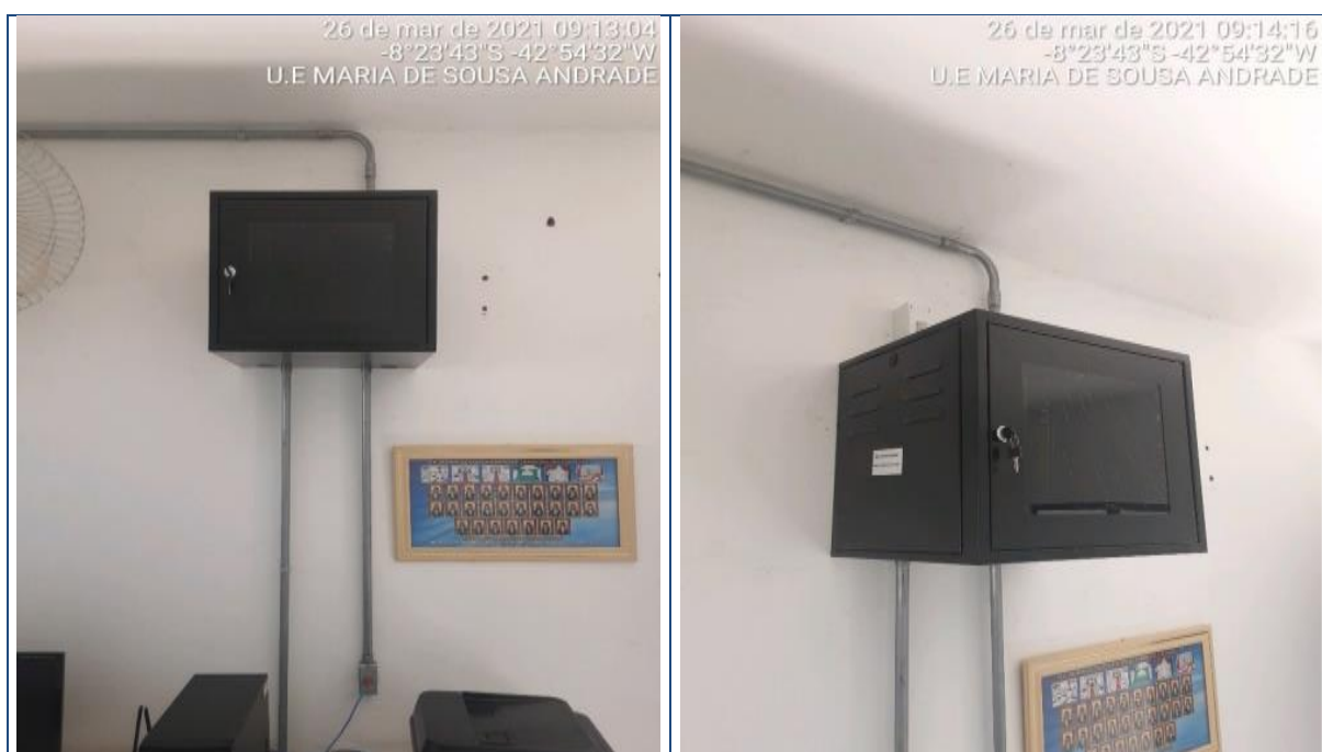
Figura 144 – PAG U.E. Maria de Sousa Andrade: NÃO CONFORME – Ausência de adesivo com contato para suporte no rack – Tamboril do Piauí
