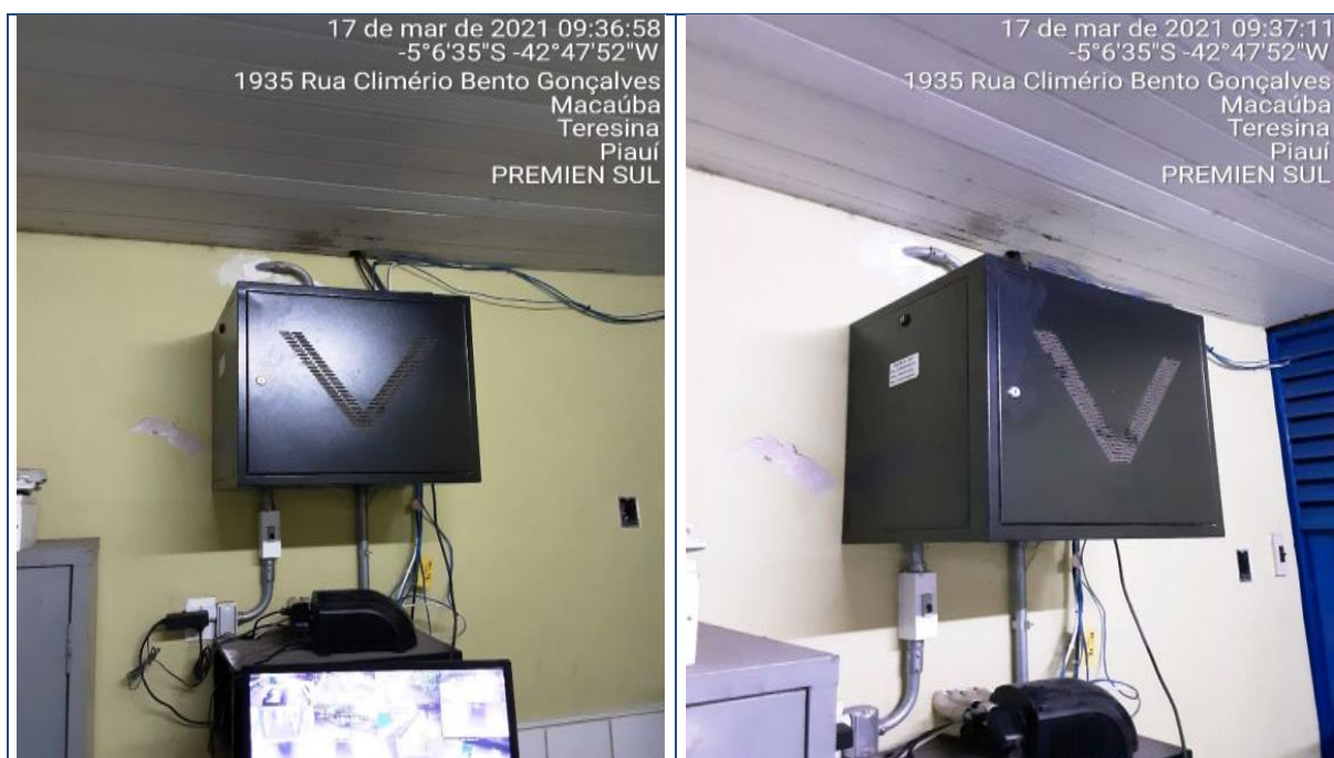
Figura 156 – PAG PREMIEN SUL: NÃO CONFORME – Ausência de adesivo com contato para suporte no rack – Teresina
