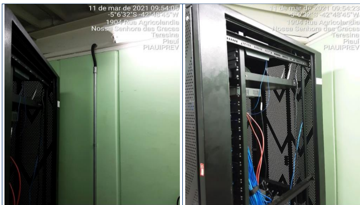
Figura 139 – PAG PIAUIPREV: NÃO CONFORME – Fixação inadequada do rack e ausência de disjuntor de proteção elétrica. – Teresina
