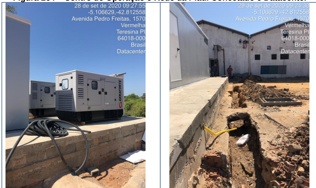
Figura 264 – Centro de Operação e Rede da Piauí Conectado e Datacenter
