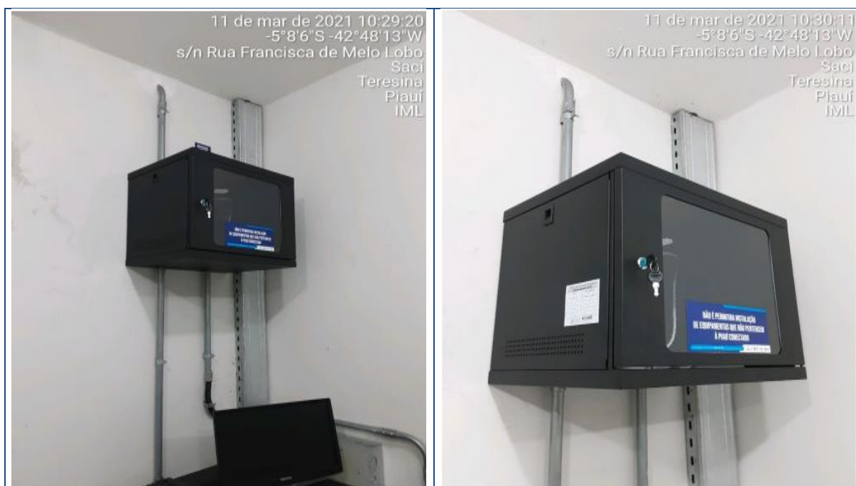
Figura 140 – PAG IML: NÃO CONFORME – Ausência de adesivo com contato para suporte e identificação do rack – Teresina
