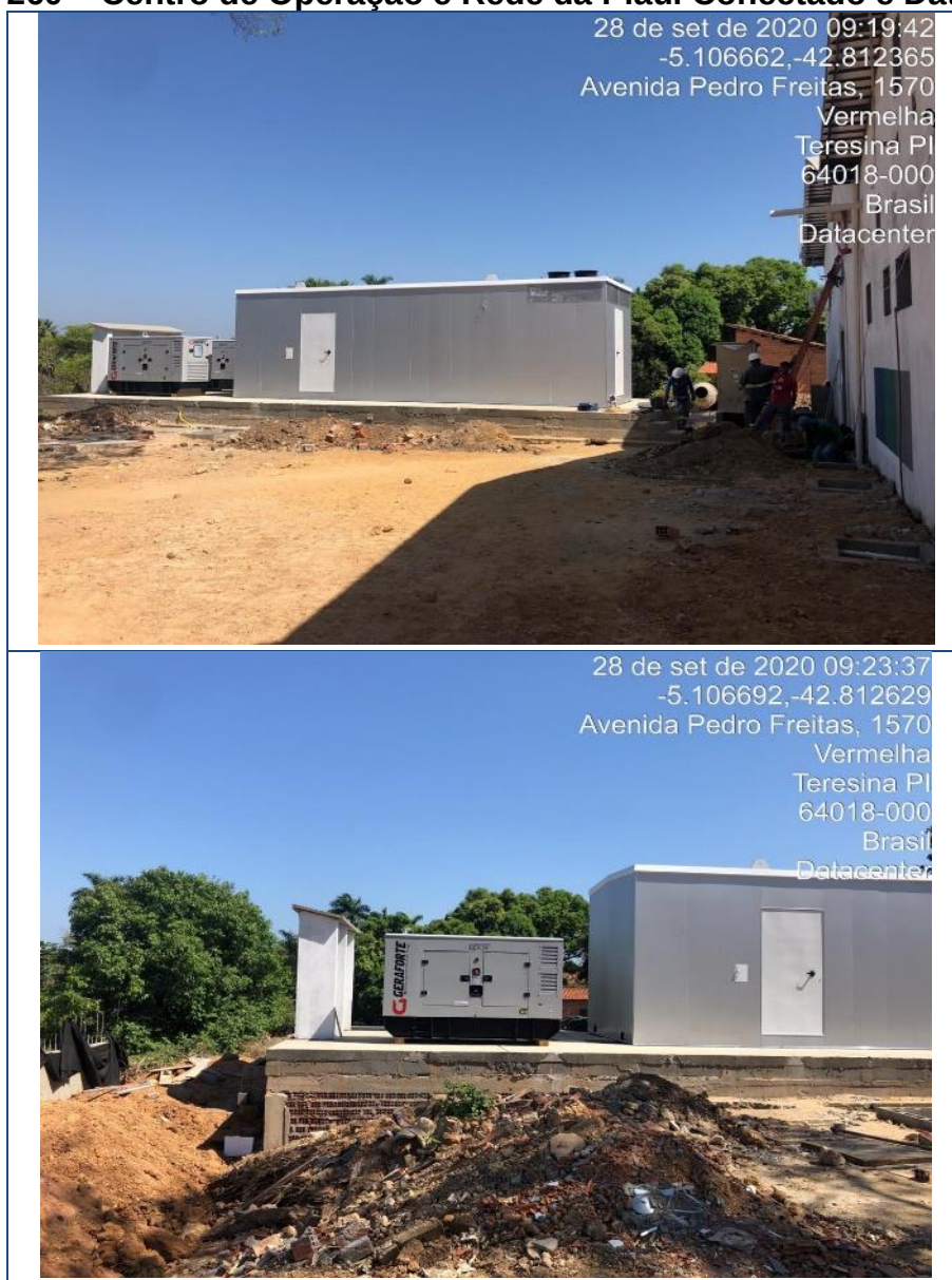
Figura 260 – Centro de Operação e Rede da Piauí Conectado e Datacenter
