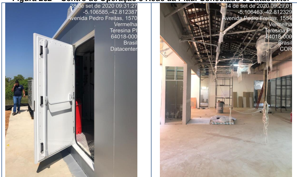
Figura 262 – Centro de Operação e Rede da Piauí Conectado e Datacenter
