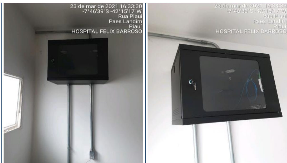
Figura 142 – PAG Hospital Felix Barroso: NÃO CONFORME – Ausência de adesivo com contato para suporte e identificação do rack – Paes Landim
