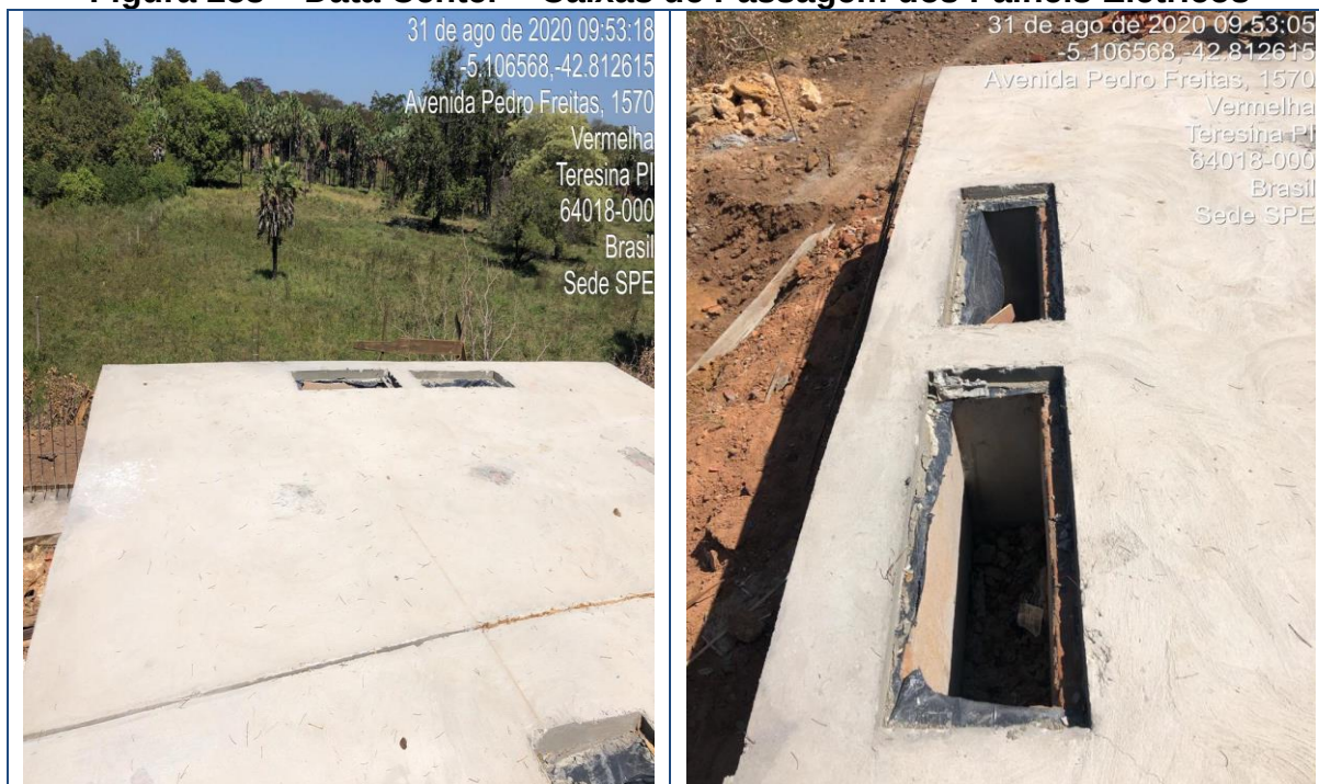
Figura 258 – Data Center – Caixas de Passagem dos Painéis Elétricos
