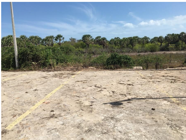
Figura 4 - Vaga de estacionamento de ônibus sem barreira de contenção
