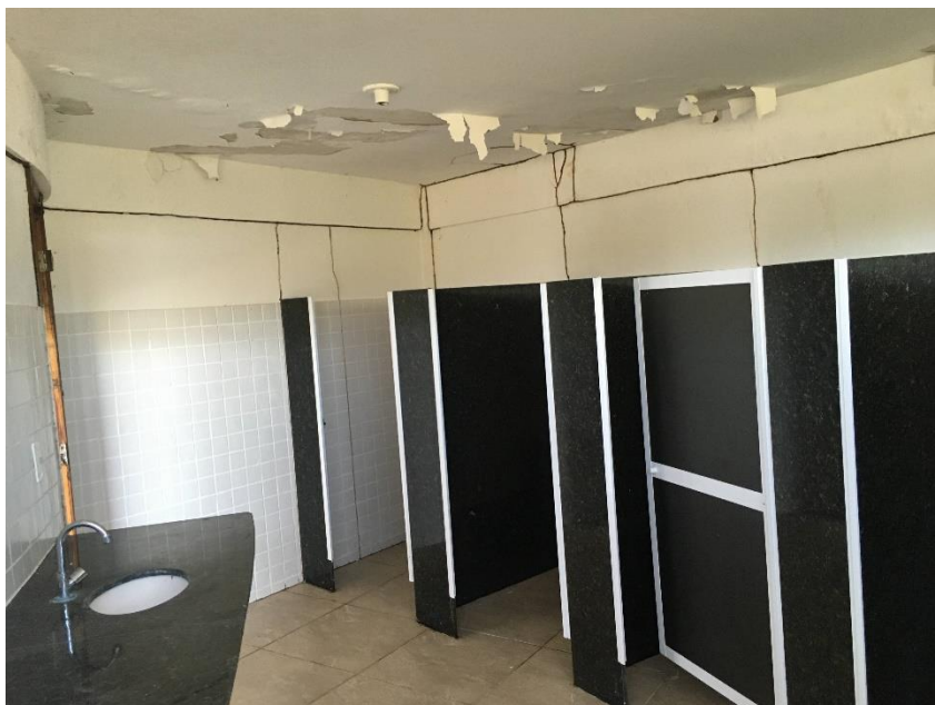
Figura 3 - Teto do banheiro com infiltração
