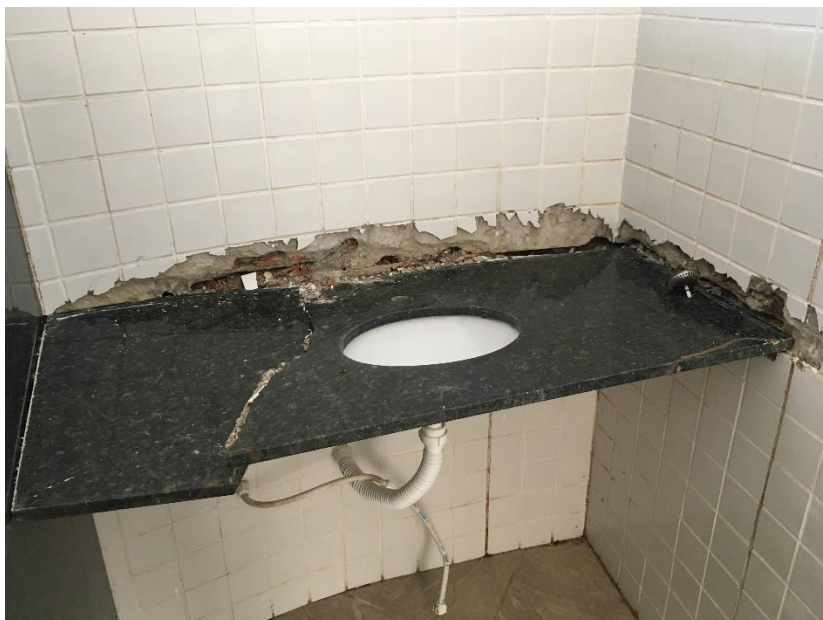
Figura 7 - Banheiro com bancada danificada por ação de vandalismo
