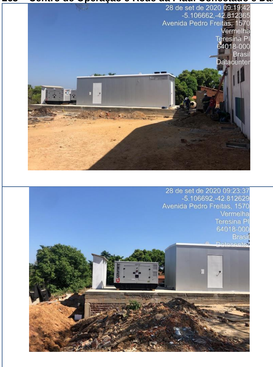
Figura 263 – Centro de Operação e Rede da Piauí Conectado e Datacenter
