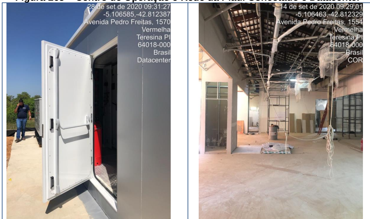
Figura 265 – Centro de Operação e Rede da Piauí Conectado e Datacenter
