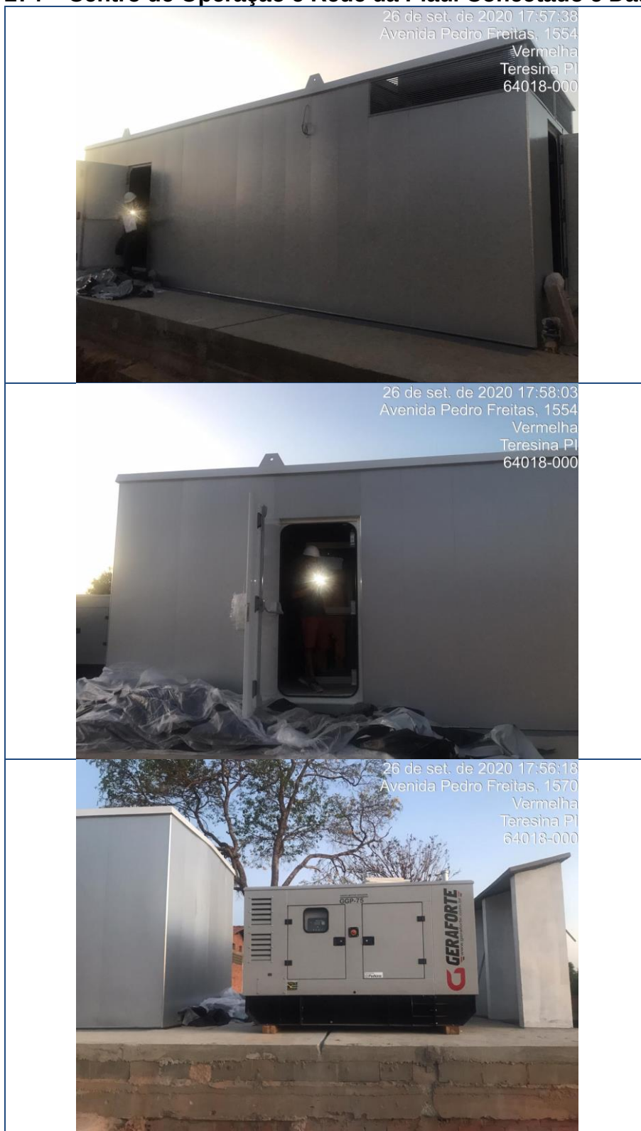
Figura 274 – Centro de Operação e Rede da Piauí Conectado e Datacenter
