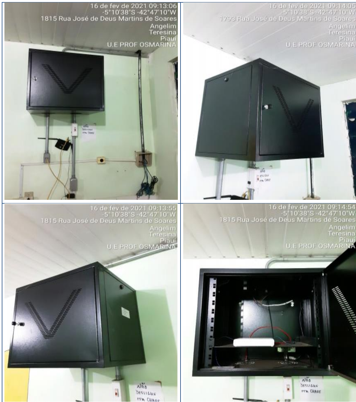
Figura 145 – PAG U.E Prof Osmarina: NÃO CONFORME – Ausência de adesivo com contato para suporte no rack – Teresina
