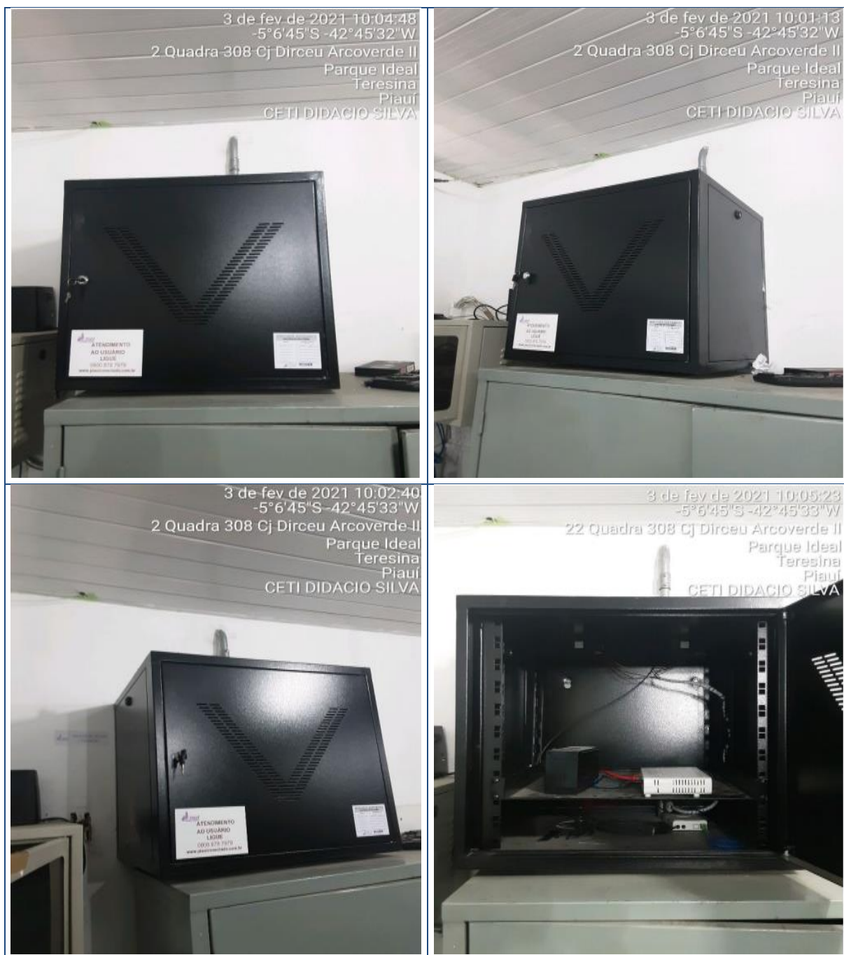
Figura 143 – PAG CETI Didacio Silva: NÃO CONFORME – Ausência de adesivo de identificação do rack e de disjuntor de proteção elétrica – Teresina
