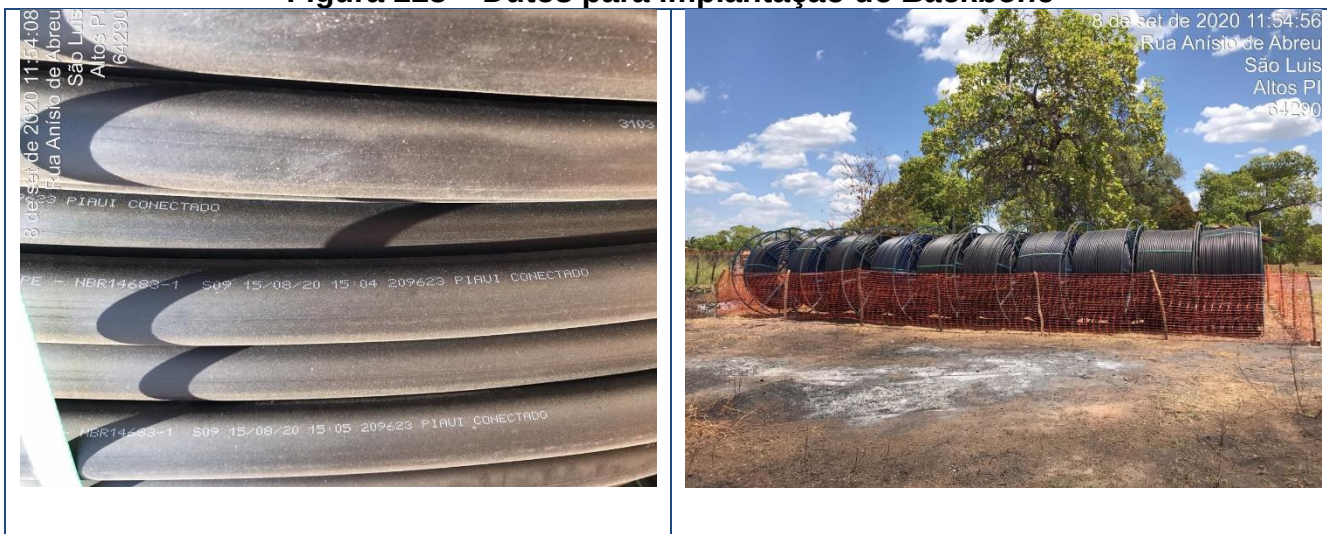
Figura 223 – Dutos para implantação do Backbone
