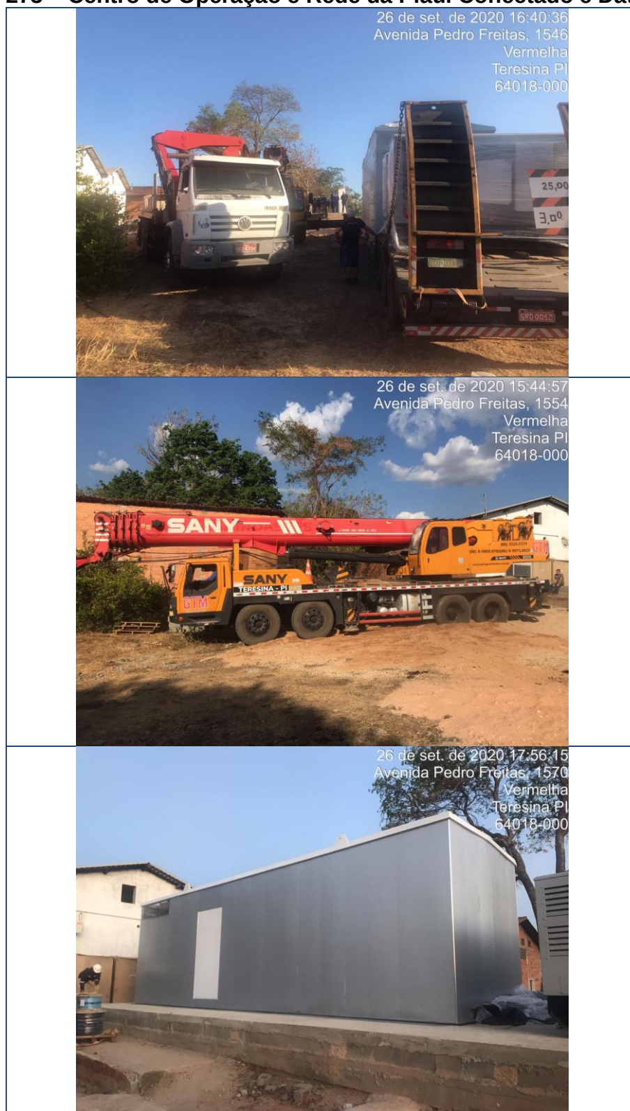
Figura 273 – Centro de Operação e Rede da Piauí Conectado e Datacenter
