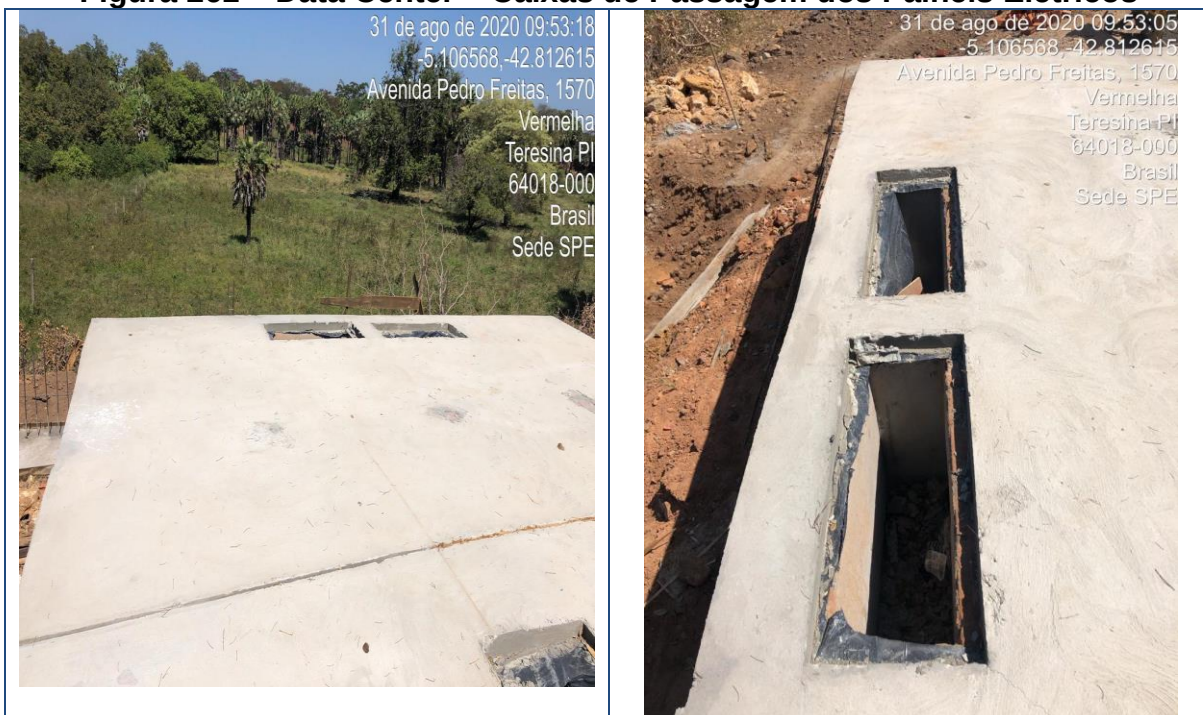
Figura 261 – Data Center – Caixas de Passagem dos Painéis Elétricos
