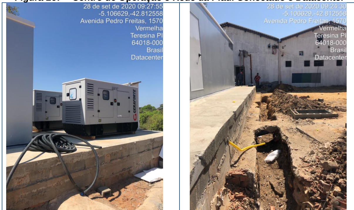
Figura 267 – Centro de Operação e Rede da Piauí Conectado e Datacenter
