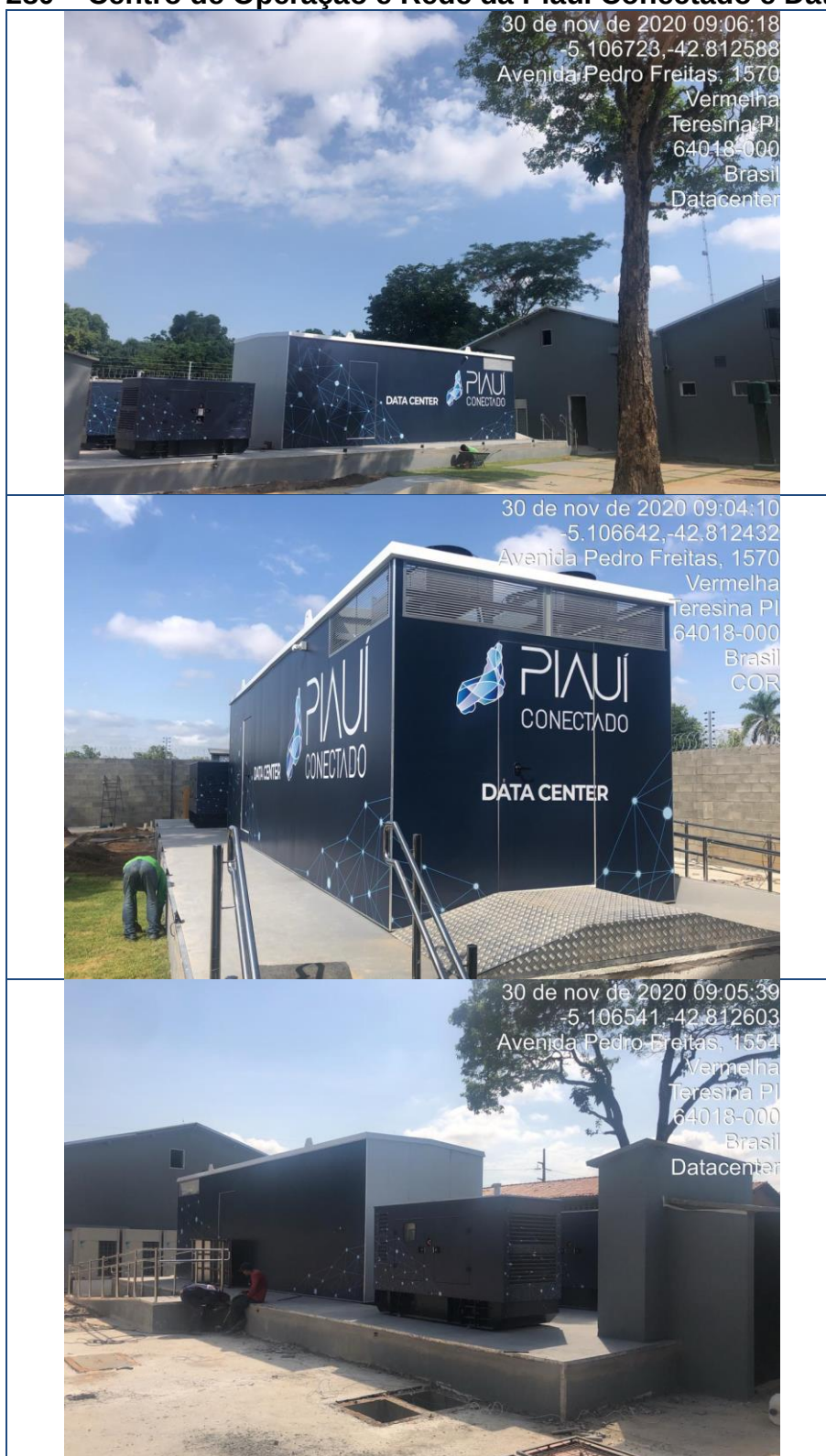
Figura 280 – Centro de Operação e Rede da Piauí Conectado e Datacenter
