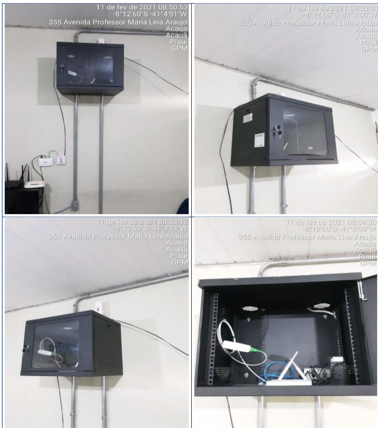
Figura 144 – PAG GPM: NÃO CONFORME – Ausência de adesivo com contato para suporte no rack – Acauã
