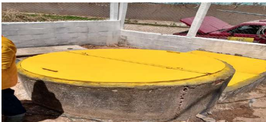
Tampas do poço de sucção
