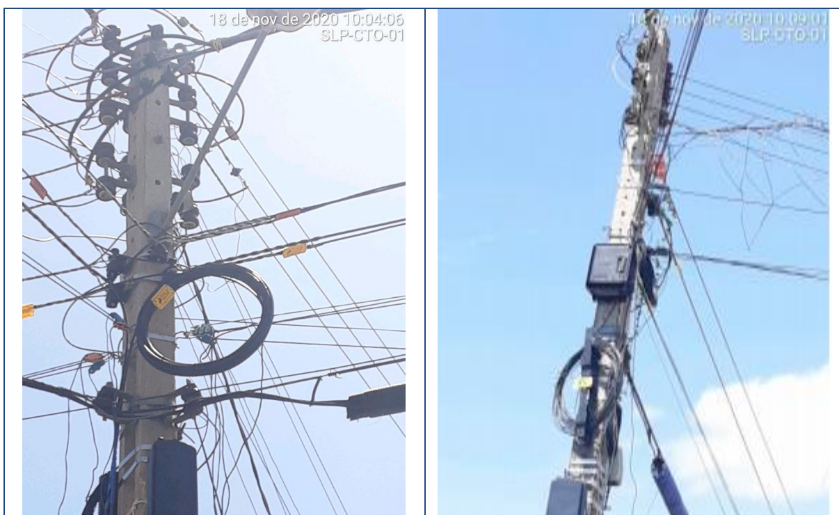
Figura 52 – SLP-CTO-01 – Reserva técnica não aplicada corretamente – São Luís do Piauí
