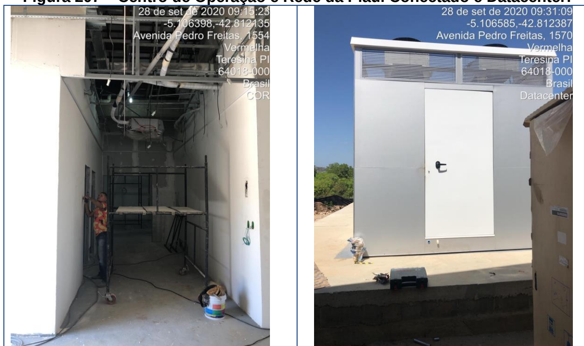
Figura 207 – Centro de Operação e Rede da Piauí Conectado e Datacenter.
