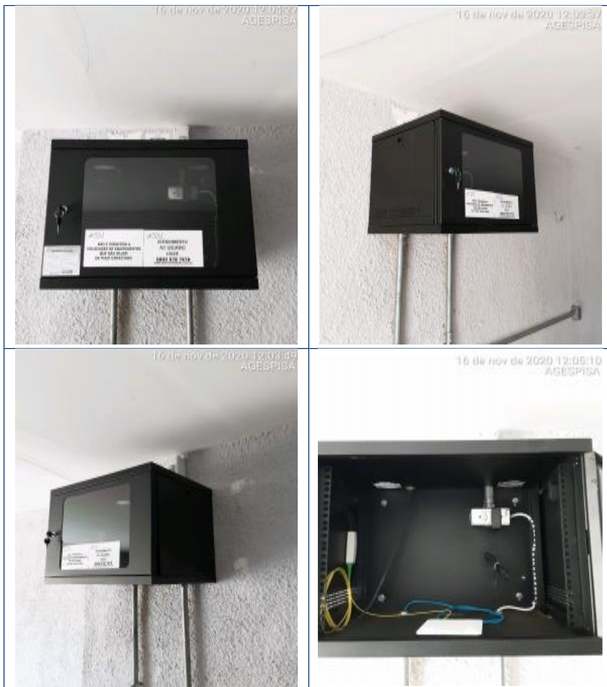
Figura 114 – PAG AGESPISA: NÃO CONFORME – Ausência de adesivo com identificação do rack – Dom Expedito Lopes
