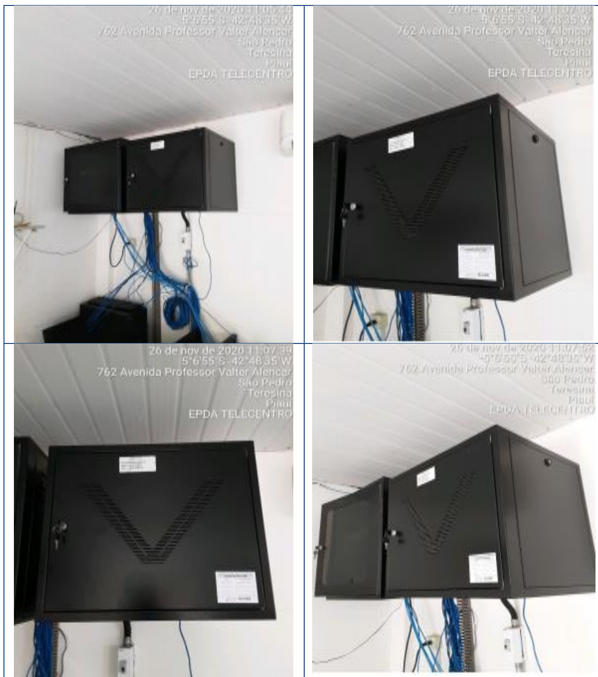
Figura 106 – PAG EPDA Telecentro: NÃO CONFORME – Ausência de adesivo com contato para suporte e identificação do rack – Teresina
