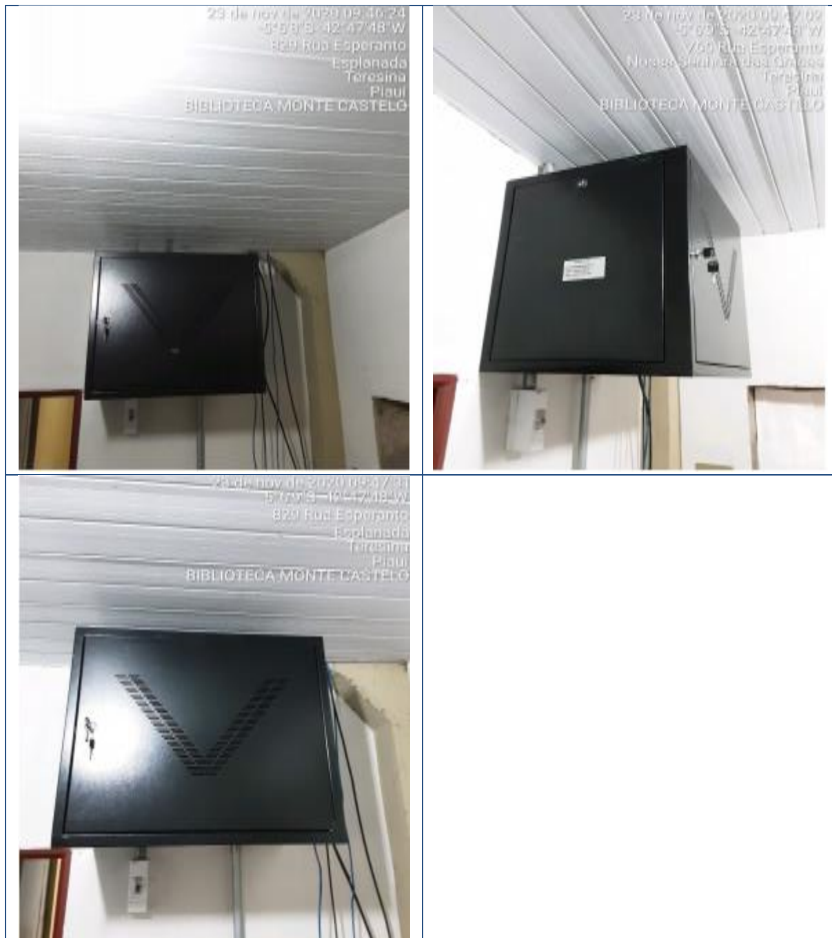
Figura 110 – PAG Biblioteca Monte Castelo: NÃO CONFORME – Ausência de adesivo com contato para suporte – Teresina
