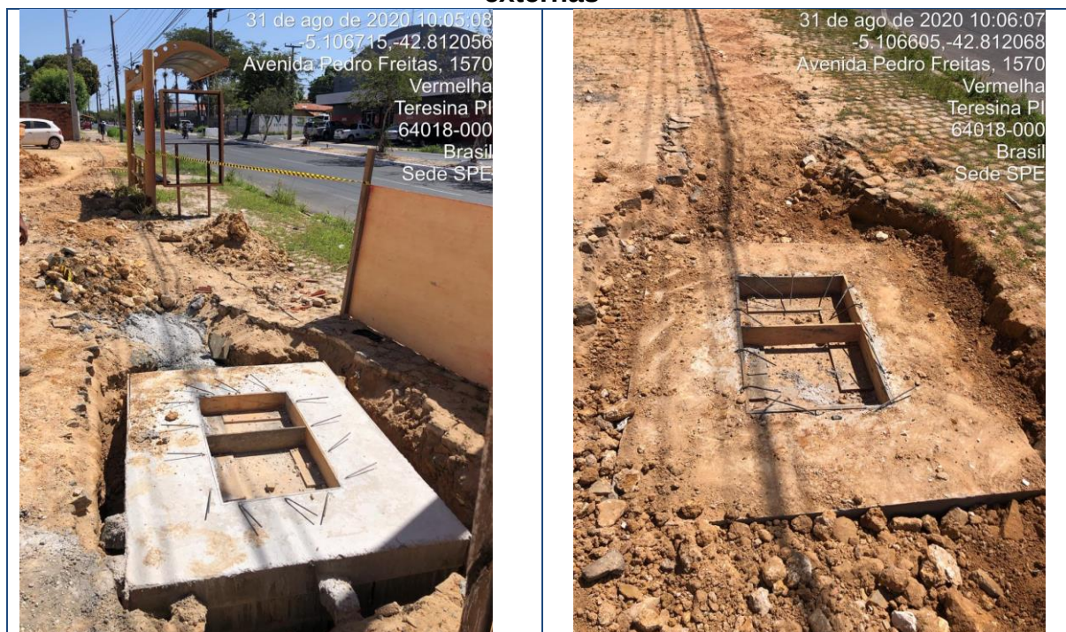
Figura 203 – Data Center – Caixas de passagem de telecomunicações - externas
