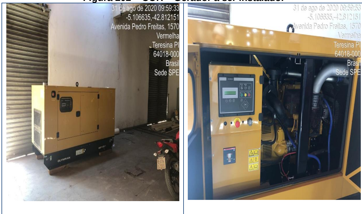
Figura 202 – COR – Gerador a ser instalado.
