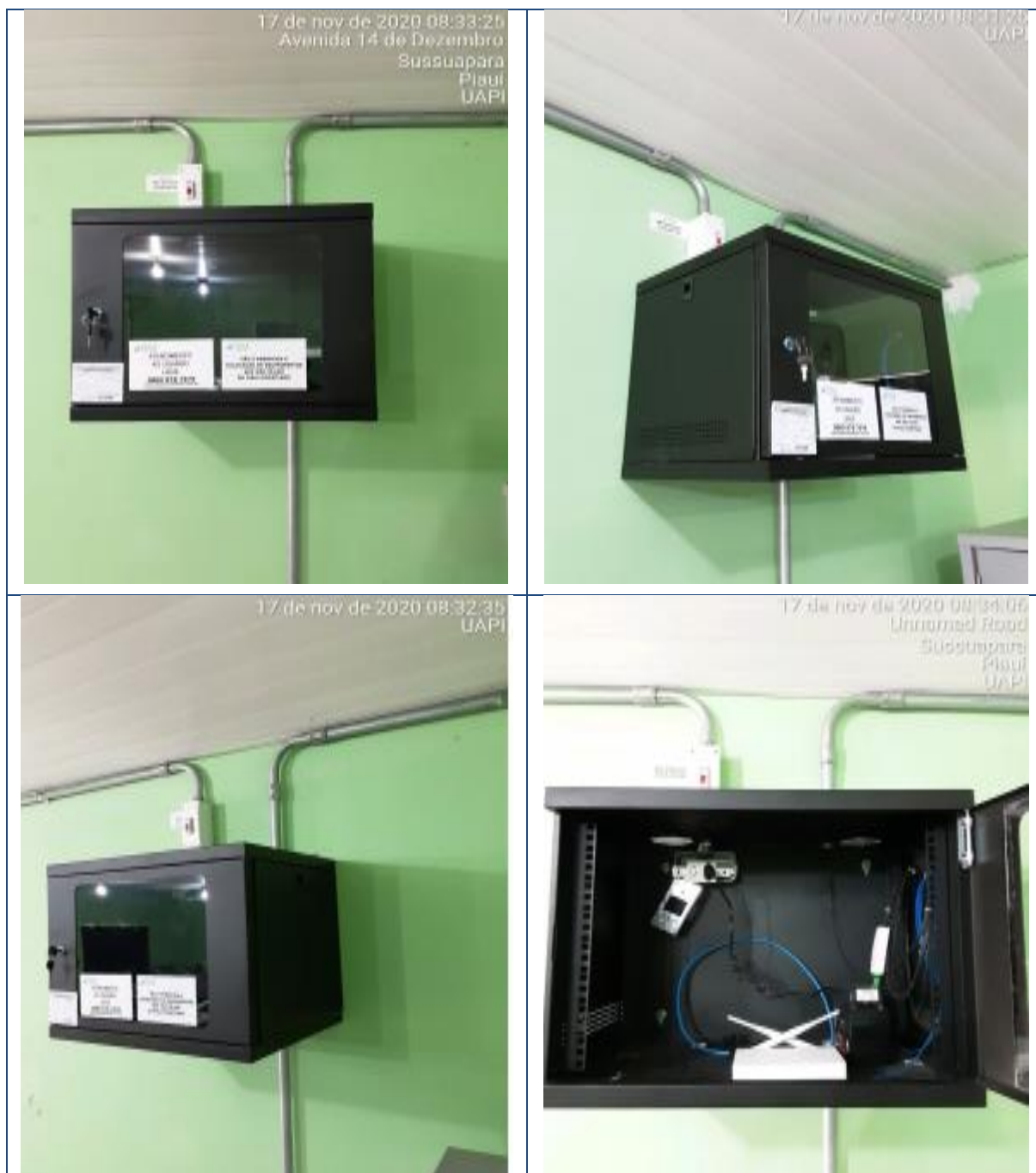
Figura 113 – PAG UAPI: NÃO CONFORME – Ausência de adesivo com identificação do rack – Sussuapara
