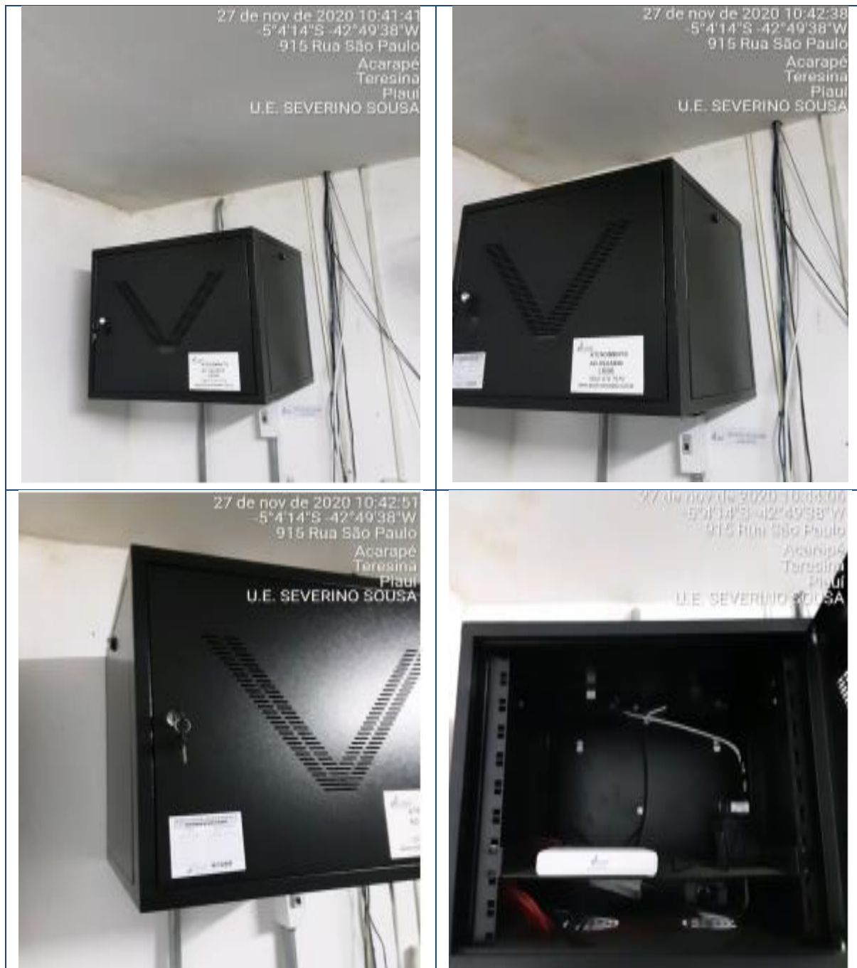
Figura 103 – PAG U.E. SEVERINO SOUSA: NÃO CONFORME – Ausência de adesivo de identificação do rack - Teresina
