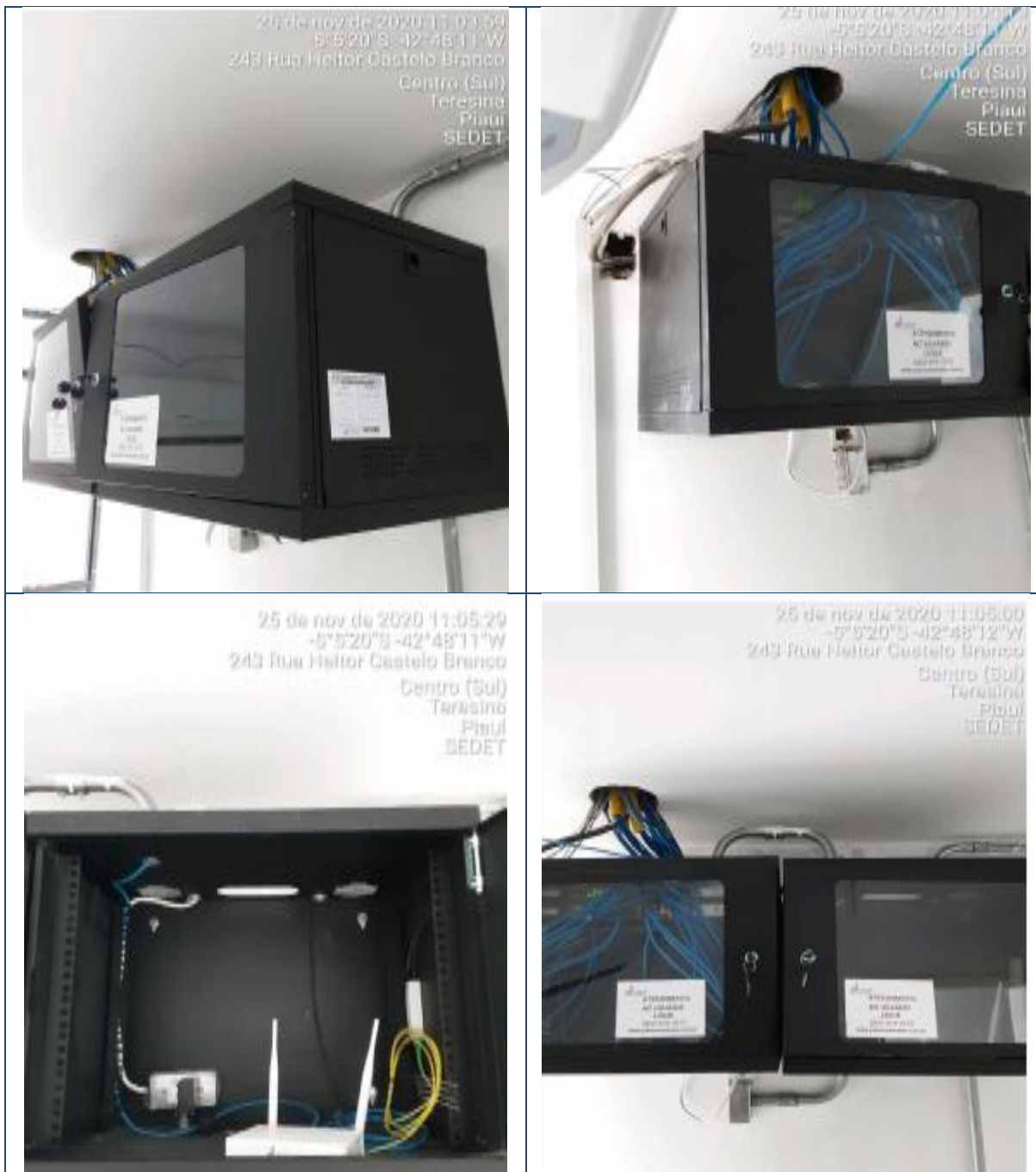
Figura 108 – PAG SEDET: NÃO CONFORME – Ausência de adesivo com identificação do rack – Teresina
