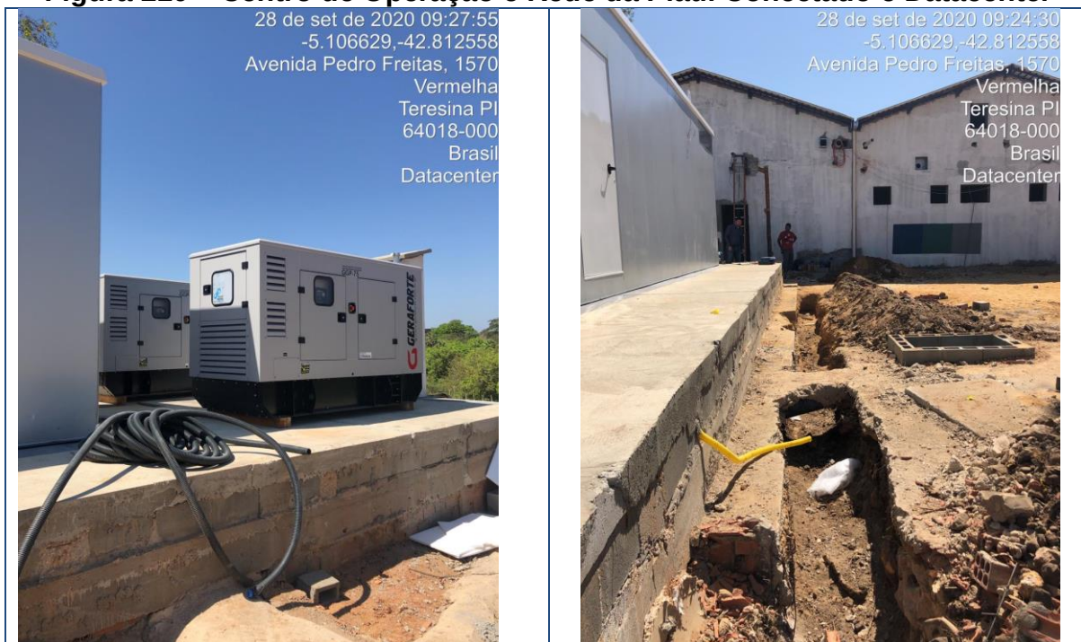
Figura 210 – Centro de Operação e Rede da Piauí Conectado e Datacenter
