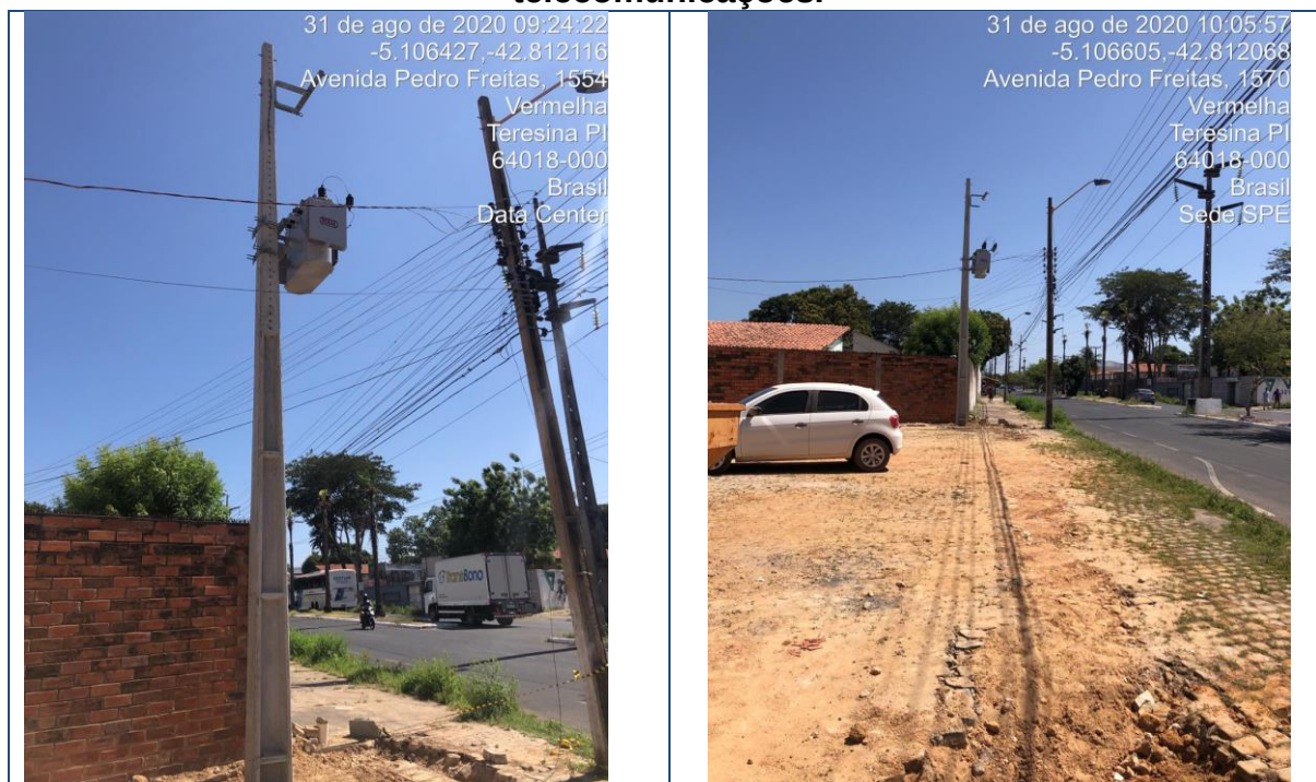
Figura 204 – Data Center – Subestação Aérea e duto subterrâneo de telecomunicações.
