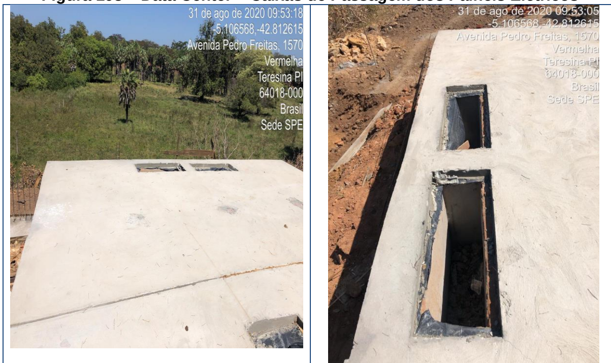
Figura 198 – Data Center – Caixas de Passagem dos Painéis Elétricos
