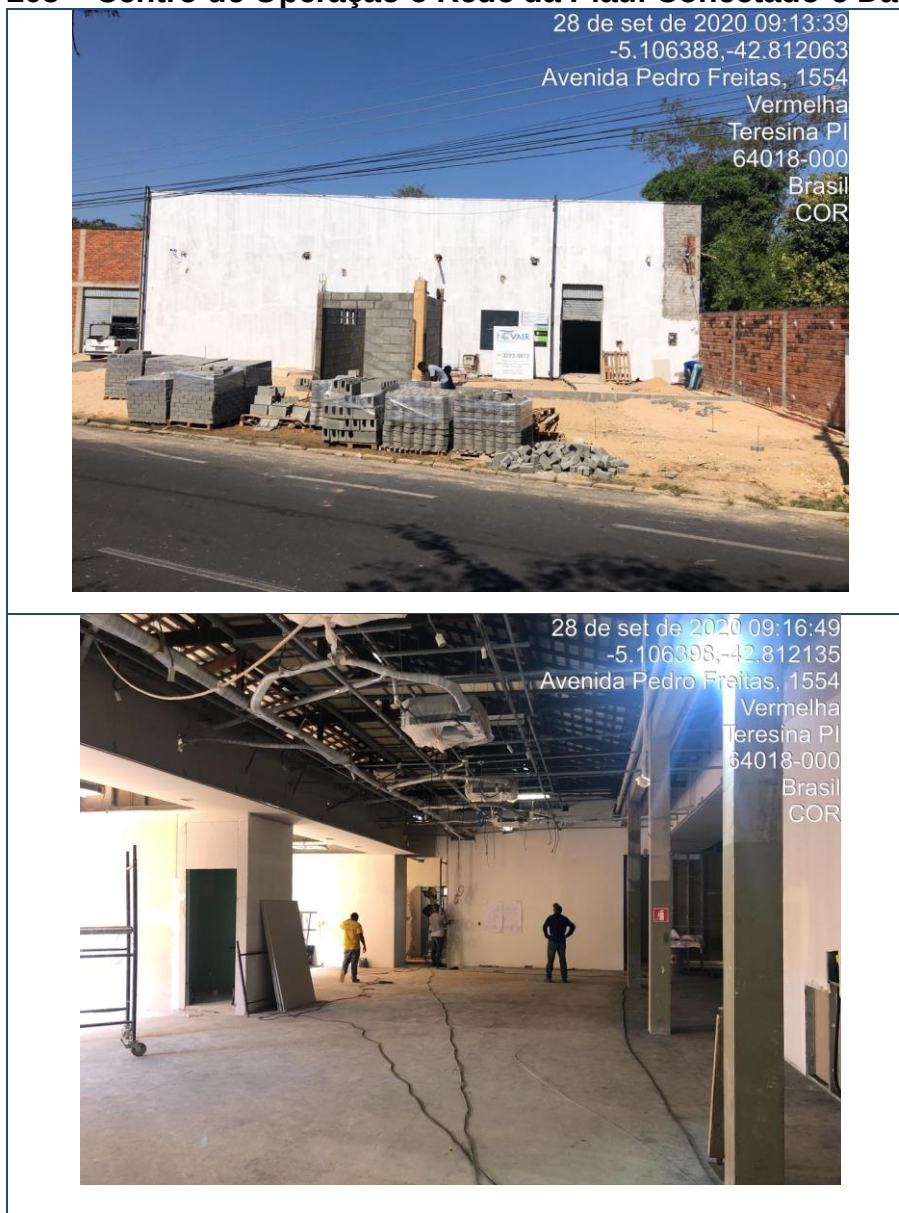
Figura 205 – Centro de Operação e Rede da Piauí Conectado e Datacenter
