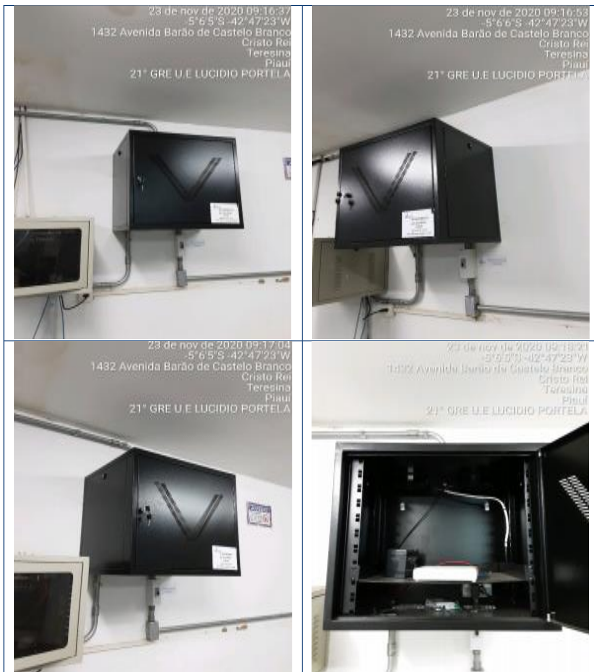
Figura 128 – PAG 21° GRE U.E Lucidio Portela: NÃO CONFORME – Ausência de adesivo de identificação do rack - Teresina
