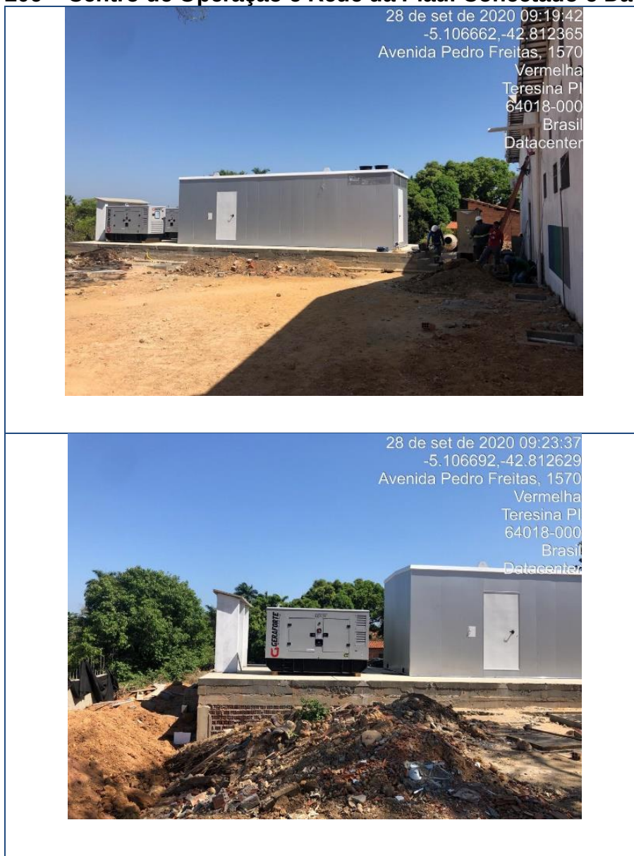
Figura 206 – Centro de Operação e Rede da PiauÍ Conectado e Datacenter
