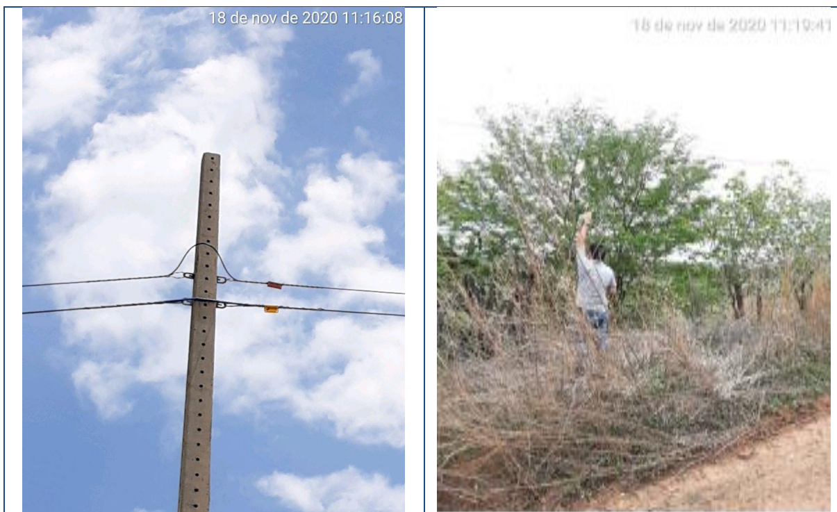
Figura 54 – SUS/SJS-CEO-01 – Lançamento padrão em não conformidade com o projeto e Altura do lançamento do cabo óptico não conforme – Sussuapara/São José do Piauí
