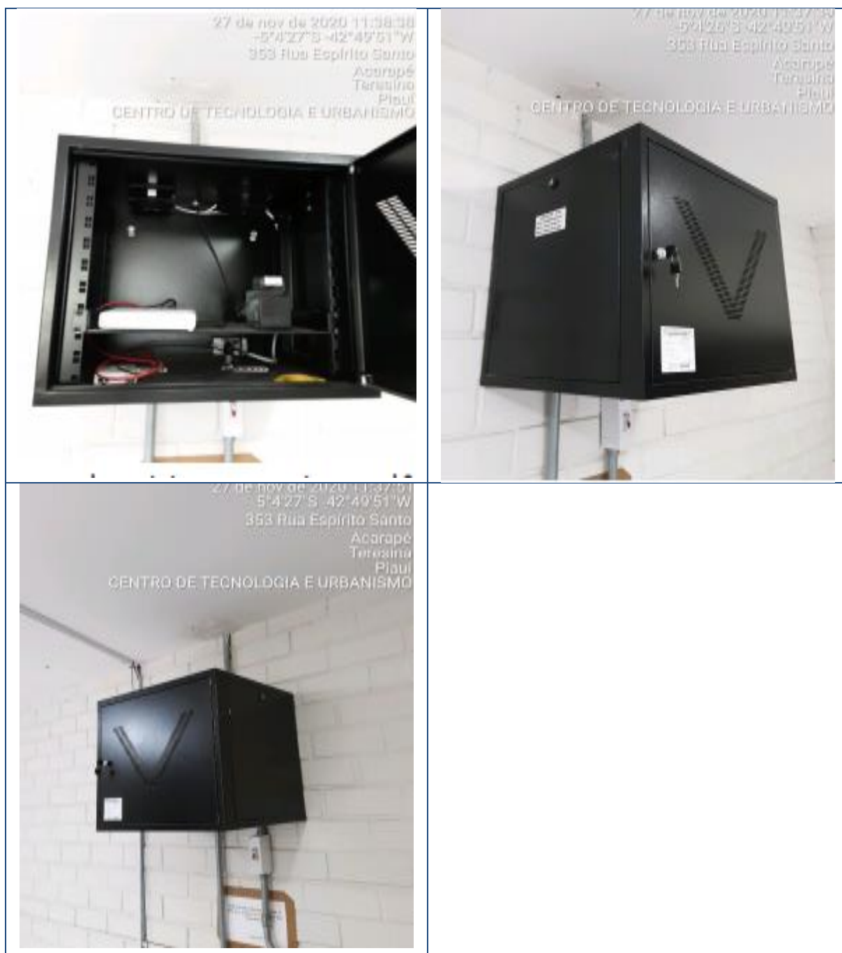
Figura 104 – PAG Centro de Tecnologia e Urbanismo: NÃO CONFORME – Ausência de adesivo com contato para suporte e identificação do rack – Teresina
