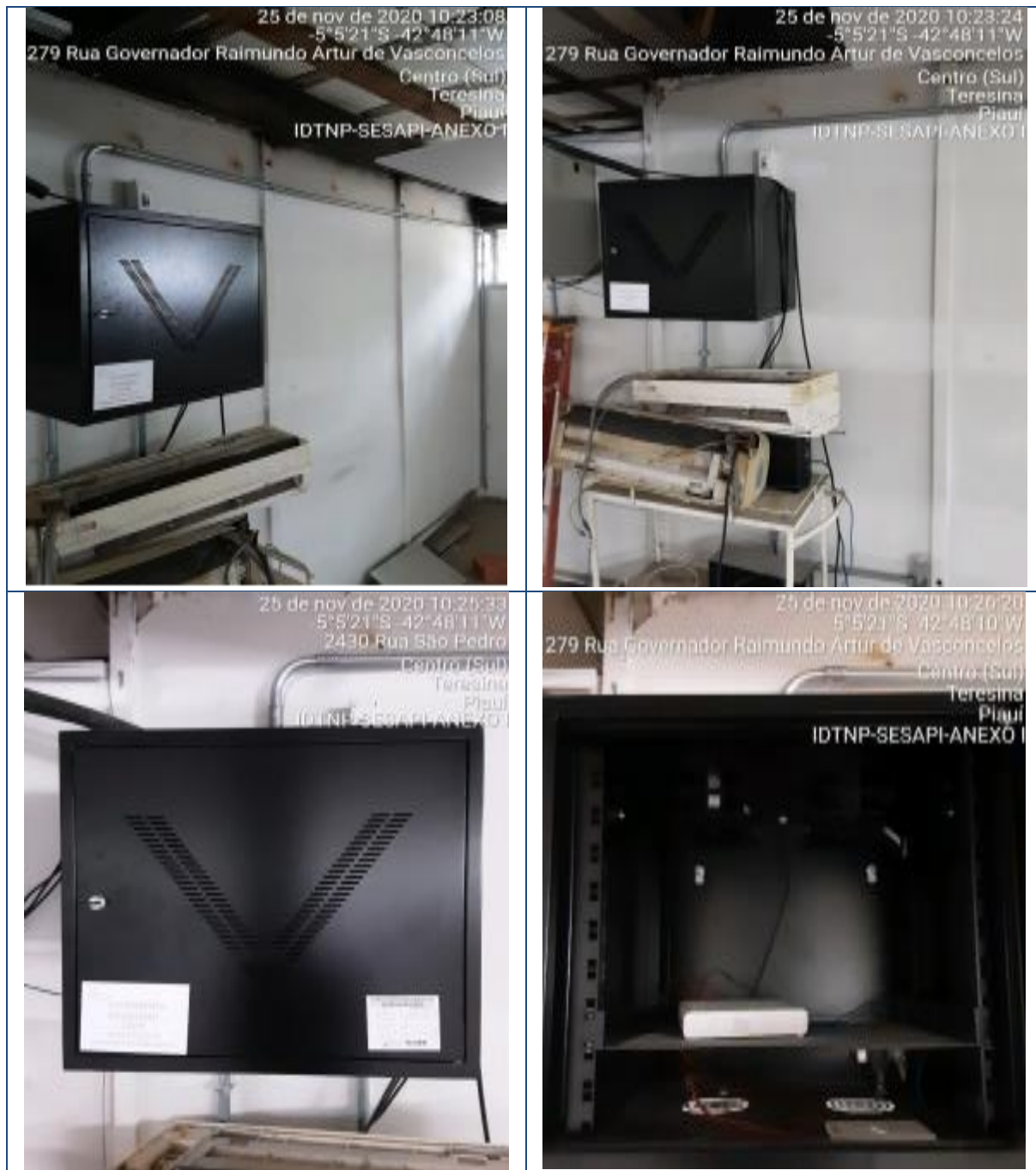
Figura 107 – PAG IDTNP-SESAPI-ANEXO I: NÃO CONFORME – Ausência de adesivo com identificação do rack – Teresina
