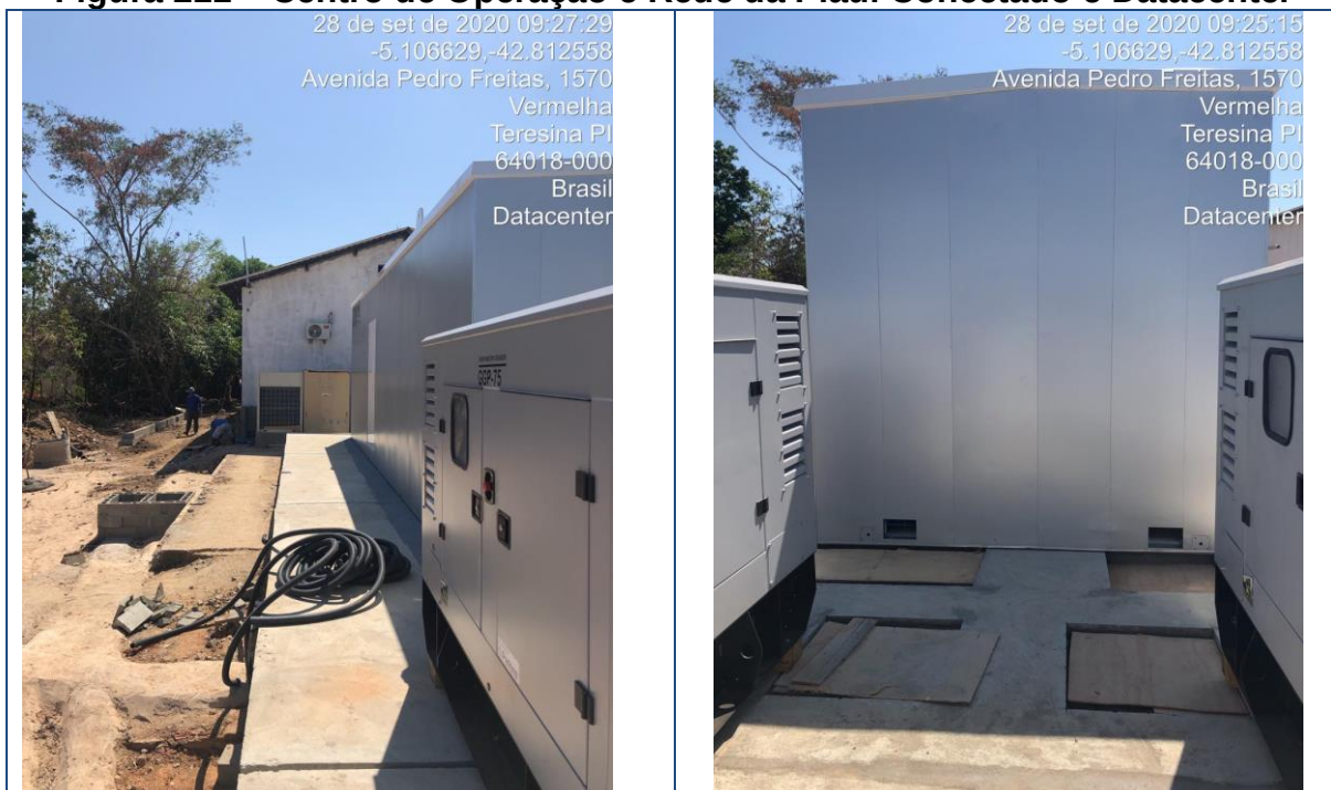
Figura 211 – Centro de Operação e Rede da Piauí Conectado e Datacenter
