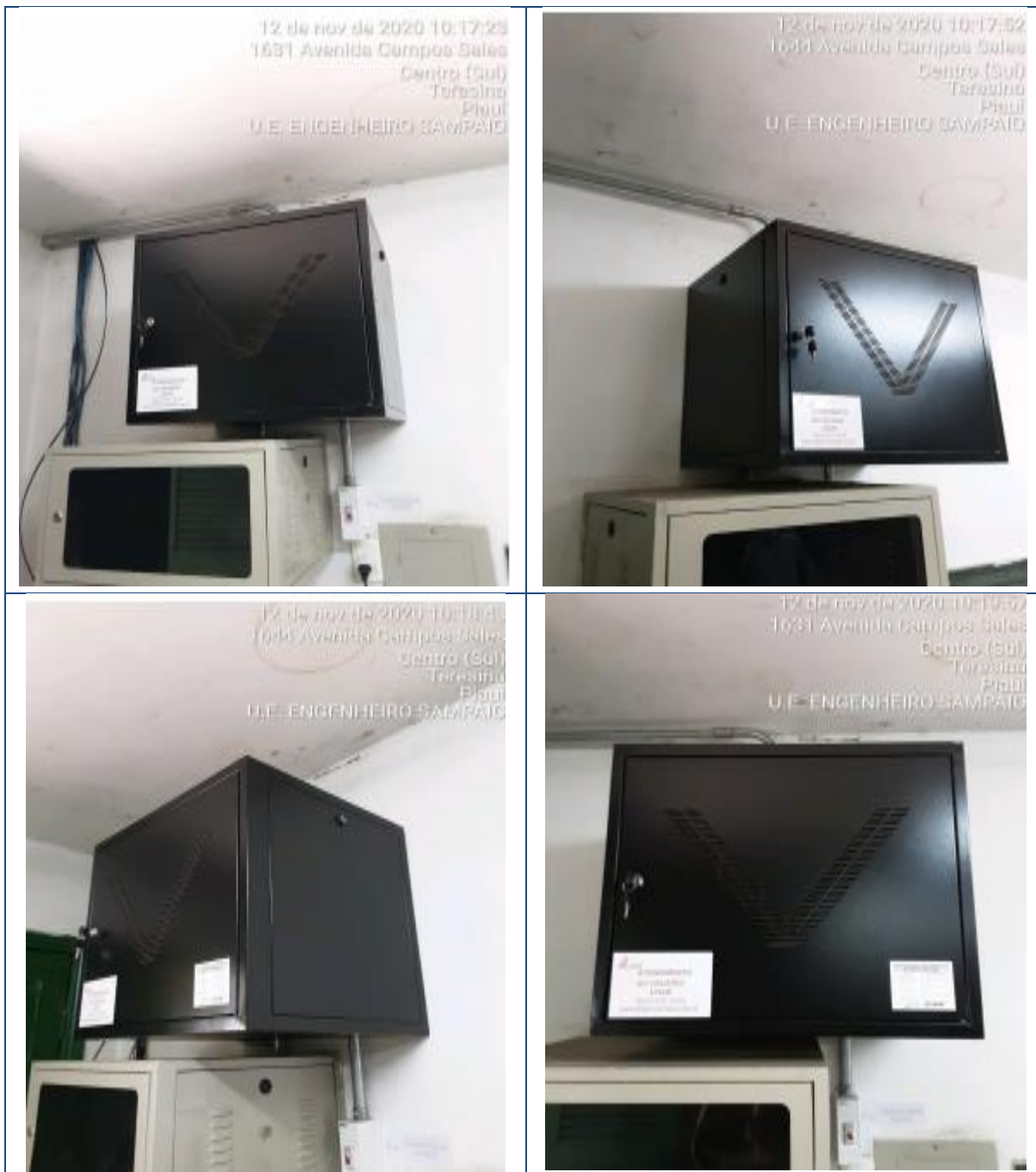
Figura 127 – PAG U.E. Engenheiro Sampaio: NÃO CONFORME – Ausência de adesivo de identificação do rack - Teresina
