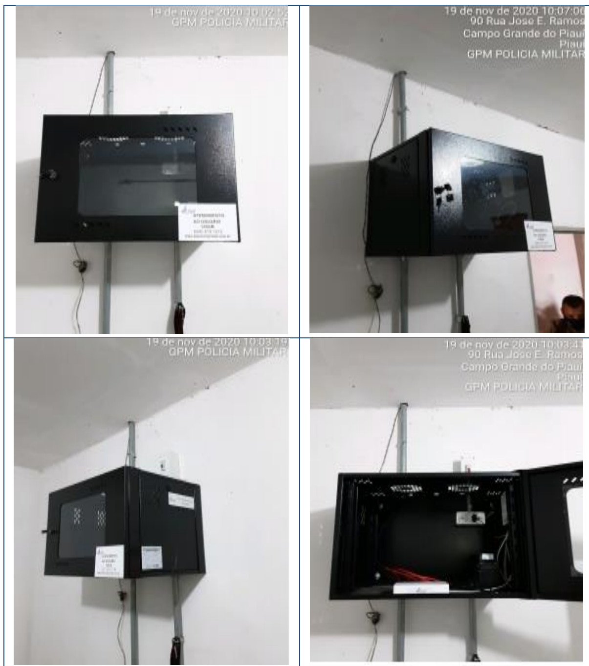
Figura 111 – PAG GPM POLÍCIA MILITAR: NÃO CONFORME – Ausência de adesivo com identificação do rack – Campo Grande do Piauí
