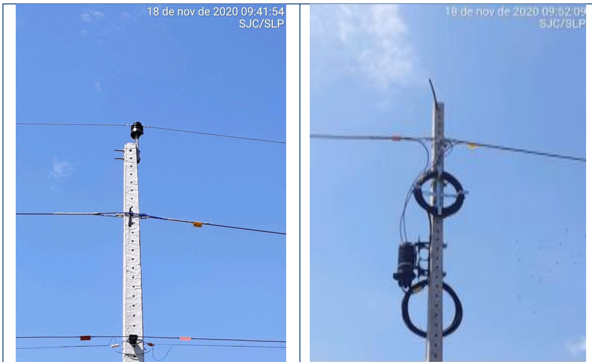
Figura 51 – SJC/SLP-CEO-01 – Lançamento padrão em não conformidade com o projeto – São João da Canabrava/ São Luís do Piauí
