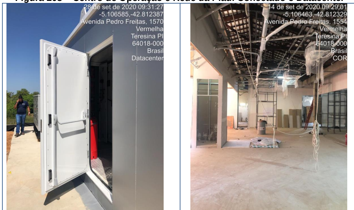
Figura 208 – Centro de Operação e Rede da Piauí Conectado e Datacenter
