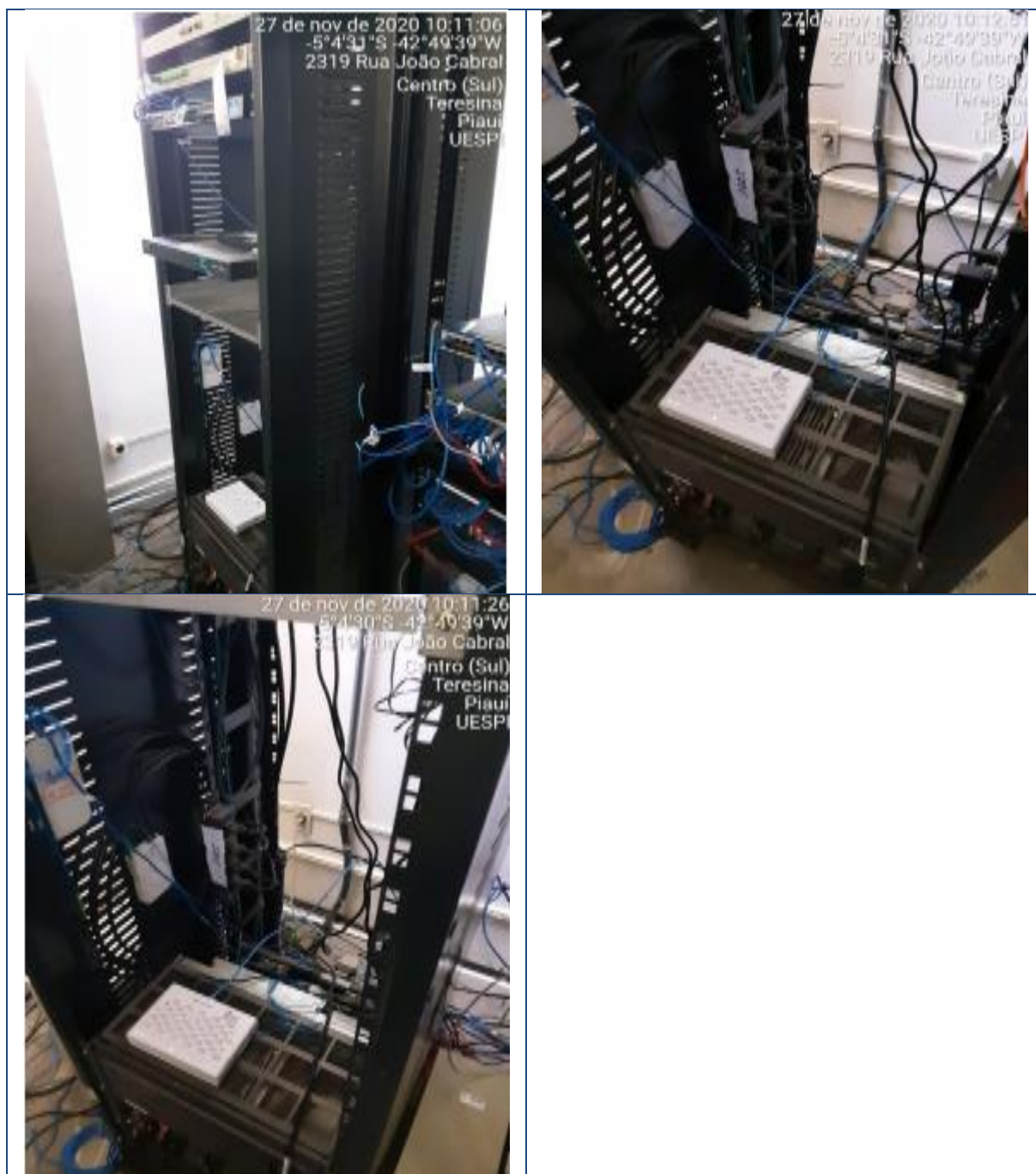
Figura 102 – PAG UESPI: NÃO CONFORME – Ausência de adesivo de identificação do rack e contato para suporte - Teresina
