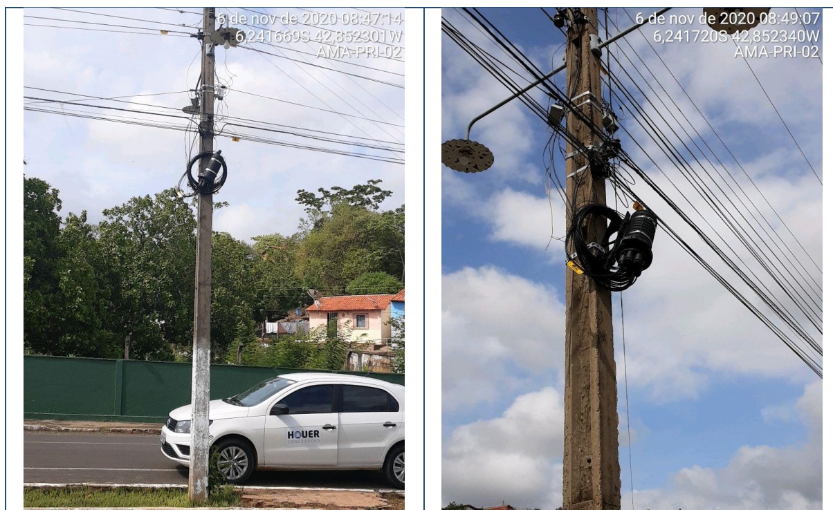
Figura 69 – AMA-PRI-02 – Suporte para fixação para caixa de emenda (CEO e CTO) aplicado incorretamente – Amarante
