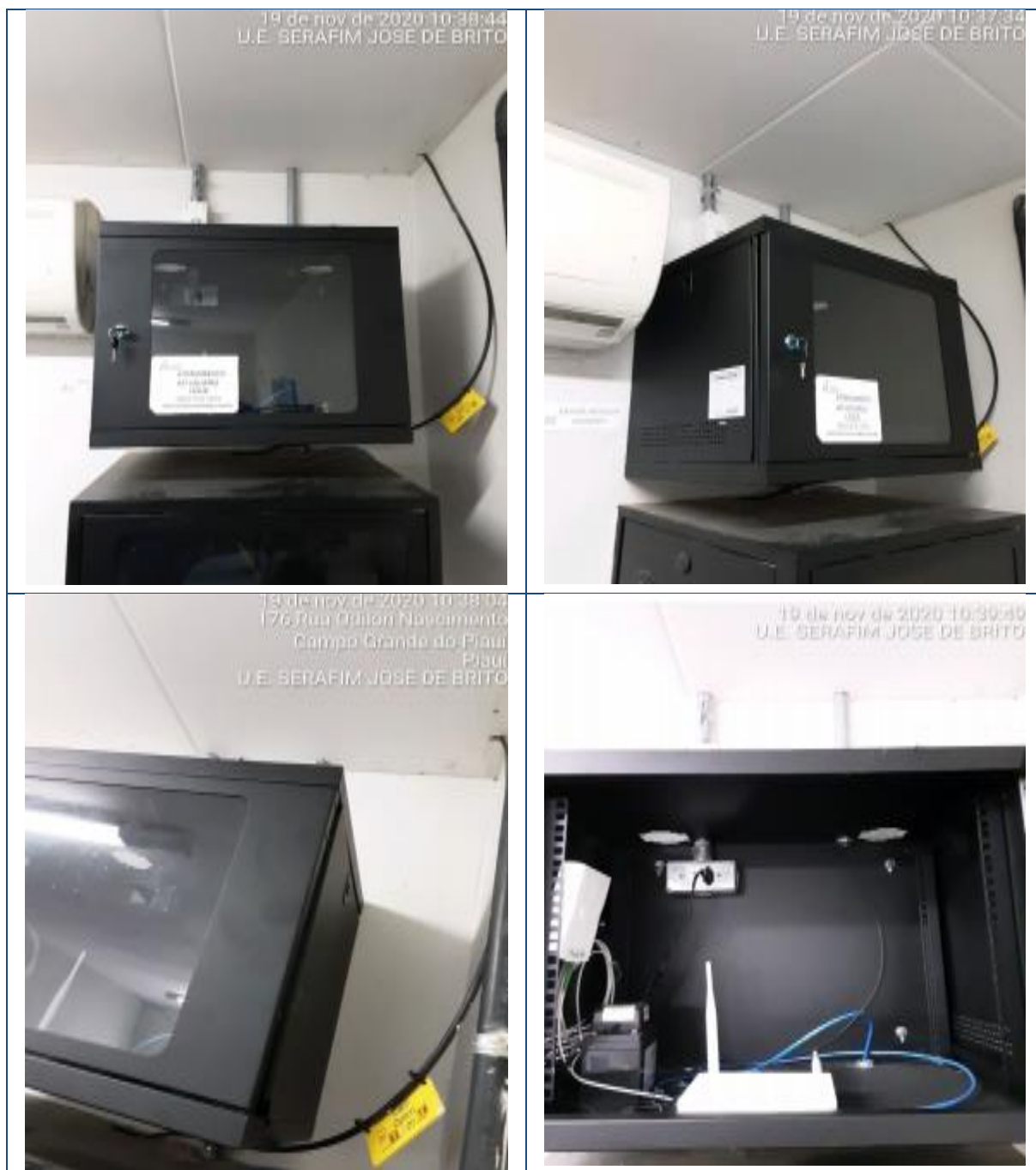
Figura 112 – PAG U.E. SERAFIM JOSE DE BRITO: NÃO CONFORME – Ausência de adesivo com identificação do rack – Campo Grande do Piauí
