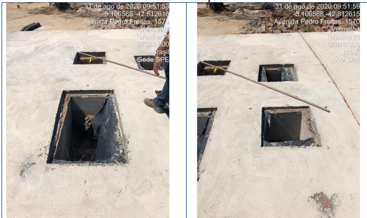
Figura 199 – Data Center - Caixas de passagem de aterramento e de telecomunicações
