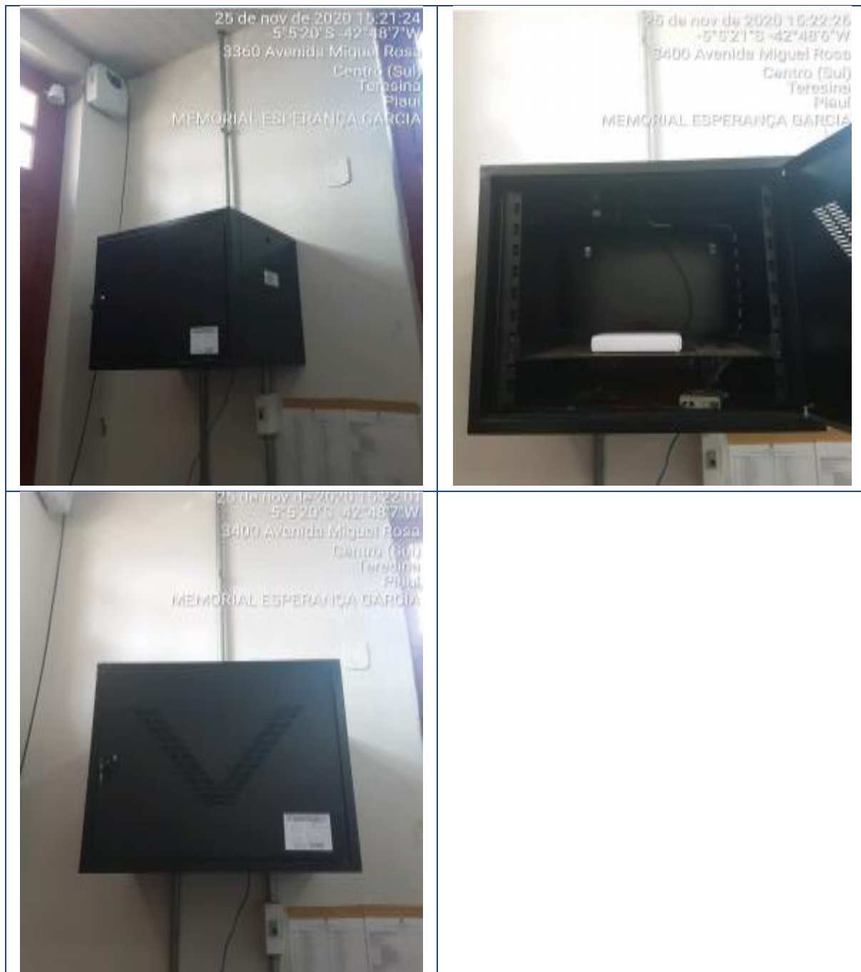
Figura 109 – PAG Memorial Esperança Garcia: NÃO CONFORME – Ausência de adesivo com contato para suporte e identificação do rack – Teresina
