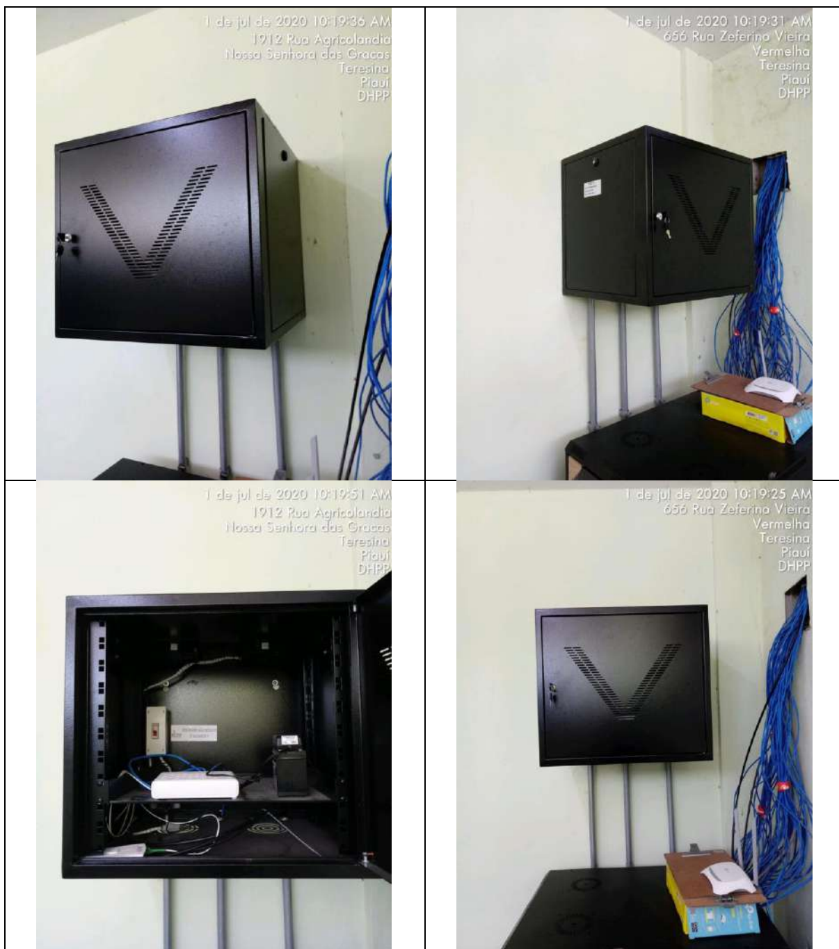
Figura 185 – PAG DHPP: NÃO CONFORME – Ausência de adesivo com contato para suporte – Teresina
