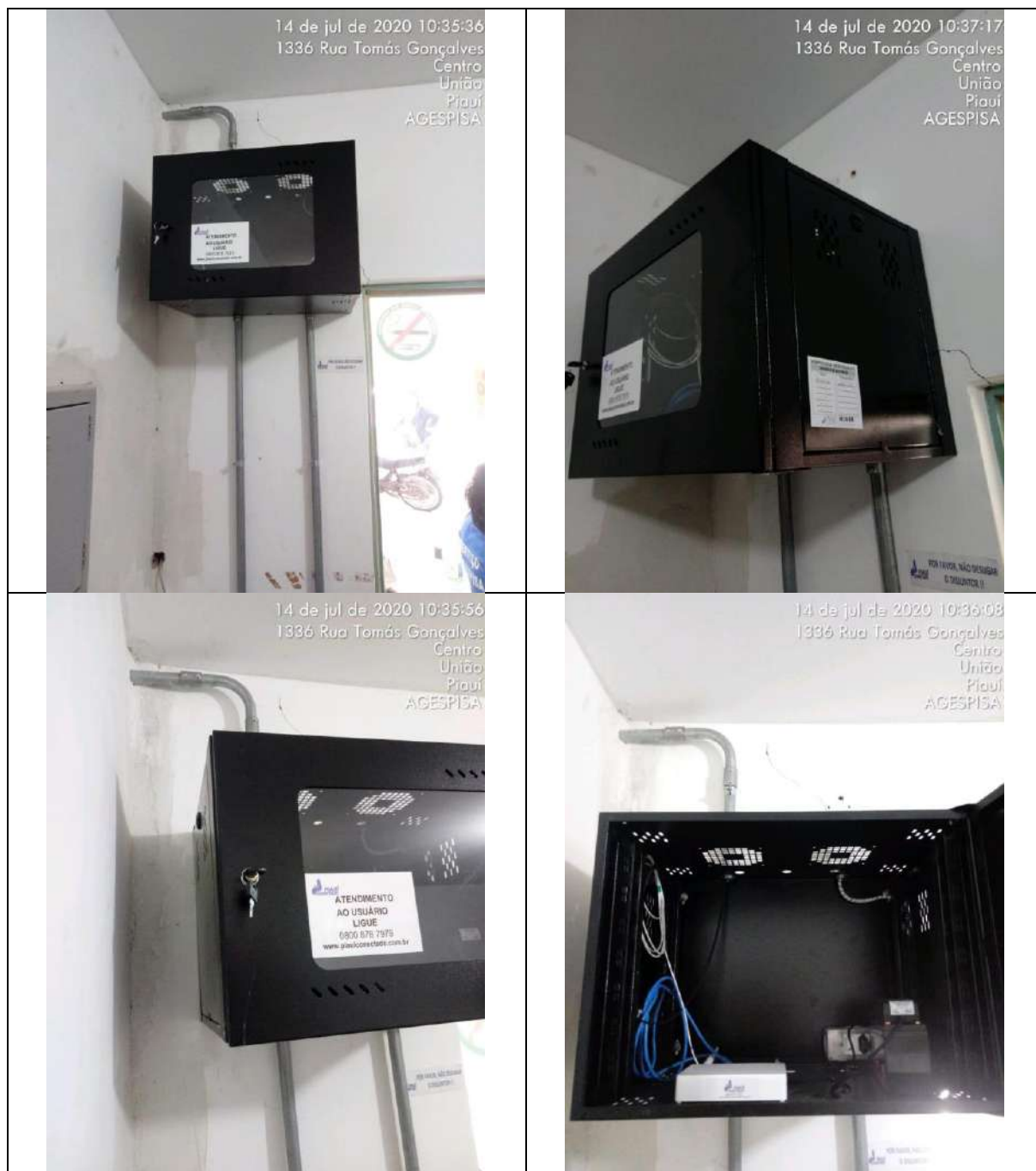
Figura 170 – PAG AGESPISA: NÃO CONFORME – Ausência de adesivo com identificação do rack – União
