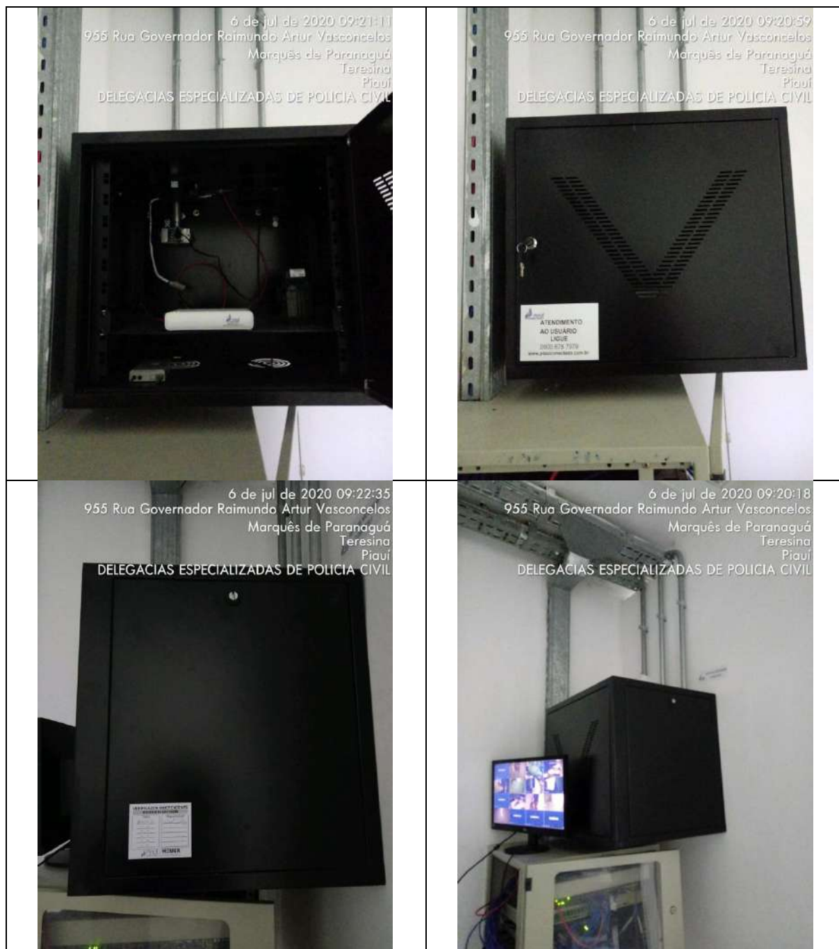
Figura 159 – PAG Delegacia Especializada de Polícia Civil: NÃO CONFORME – Ausência de adesivo com identificação do rack – Teresina
