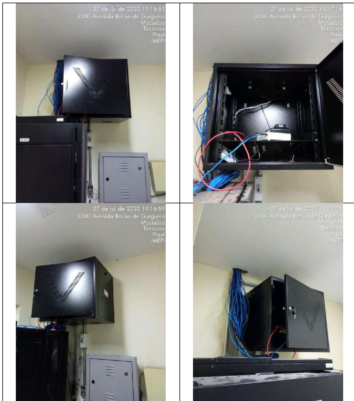
Figura 203 – PAG IMEPI: NÃO CONFORME – Ausência de adesivo com contato para suporte – Teresina
