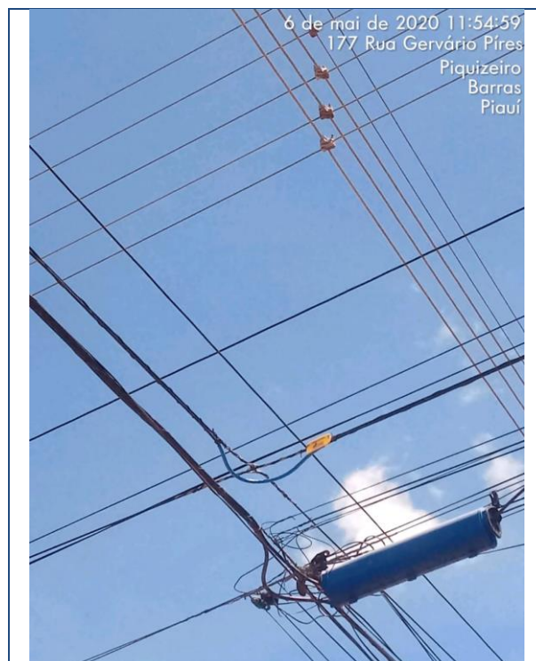
Figura 71 – Rede Óptica Aérea – Barras
