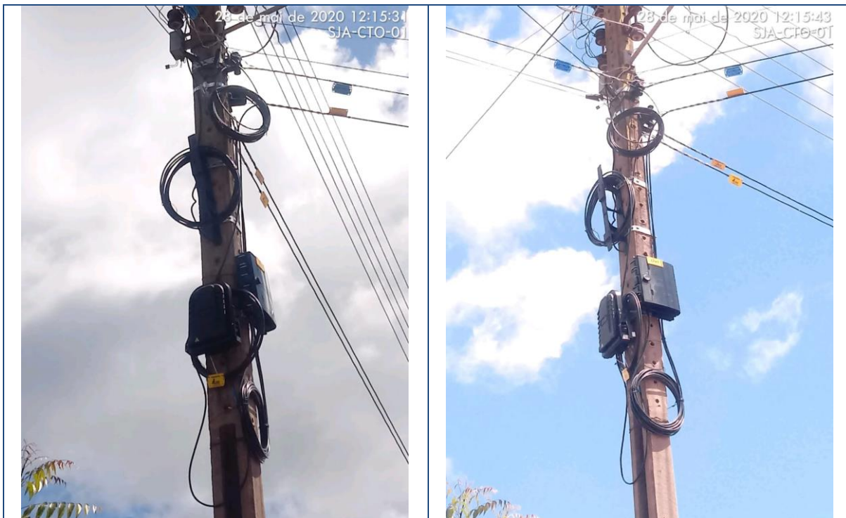
Figura 37 – SJA – CTO – 01 – Reserva técnica não foi aplicada corretamente – São João do Arraial
