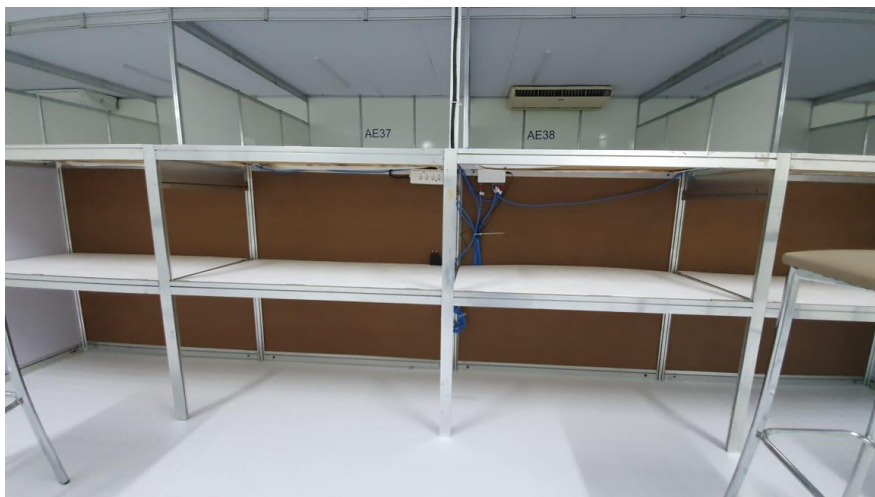
Cabeamento Piauí Conectado - Figura 61
