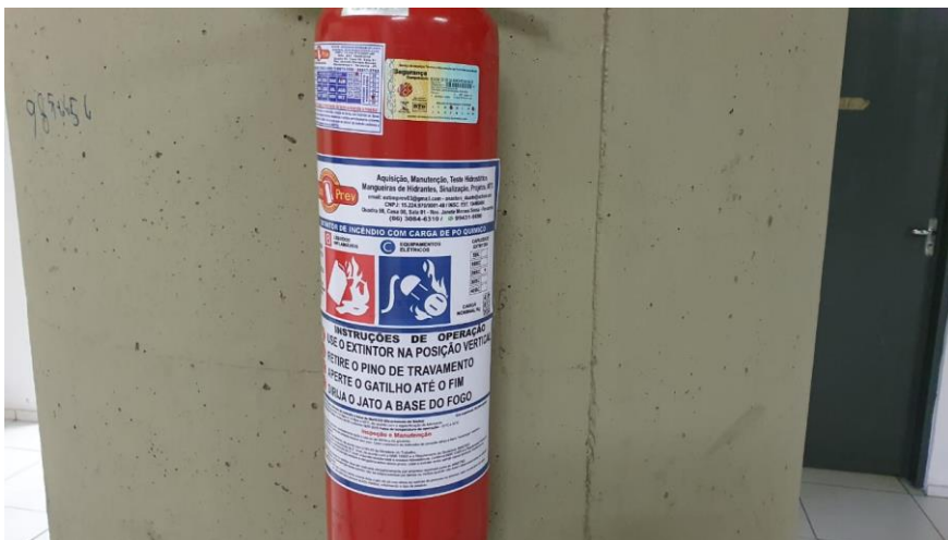
Sistema de Combate à Incêndio - Figura 213
