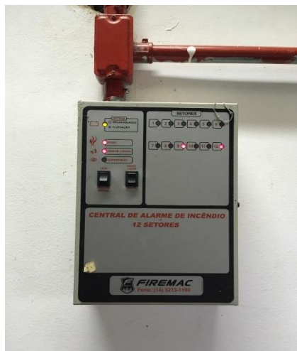
Sistema de Combate à Incêndio - Figura 209
