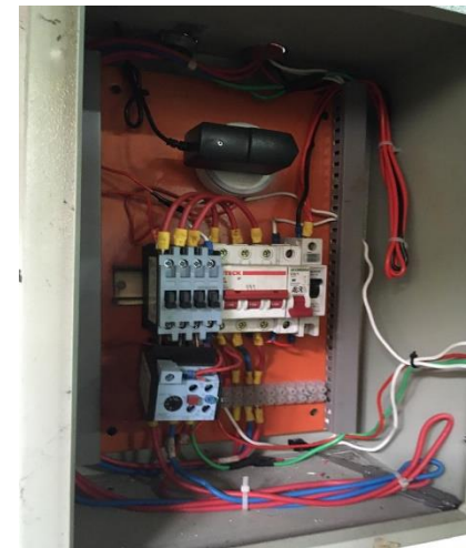
Sistema de Combate à Incêndio - Figura 208
