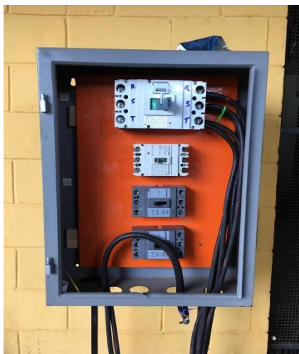
Quadro dos geradores de energia - Figura 85
