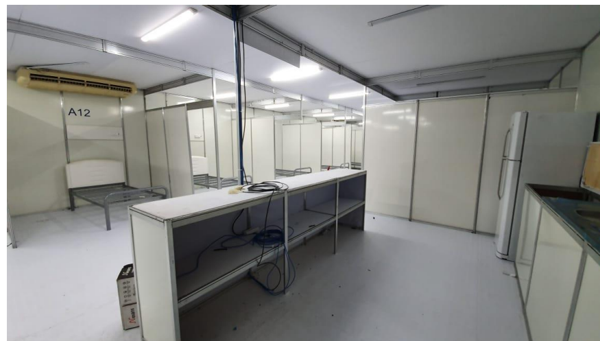
Cabeamento Piauí Conectado - Figura 58
