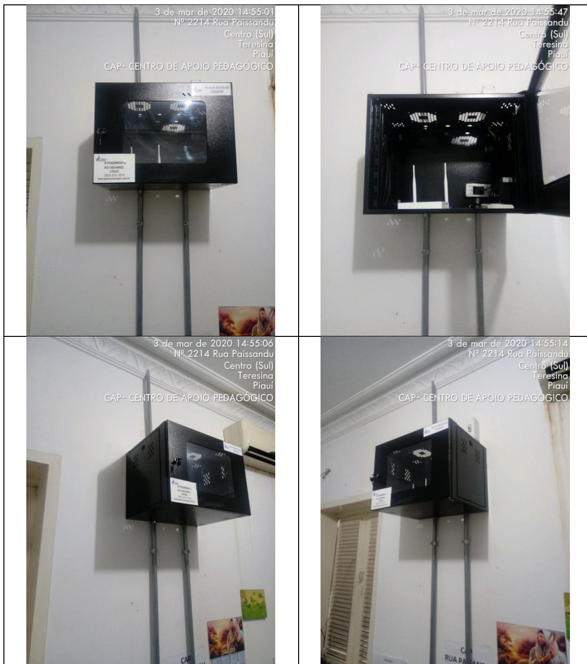
Figura 288 – PAG CENTRO DE APOIO PEDAGÓGICO – TERESINA. NÃO CONFORMIDADE: AUSÊNCIA DE IDENTIFICAÇÃO DO RACK.
