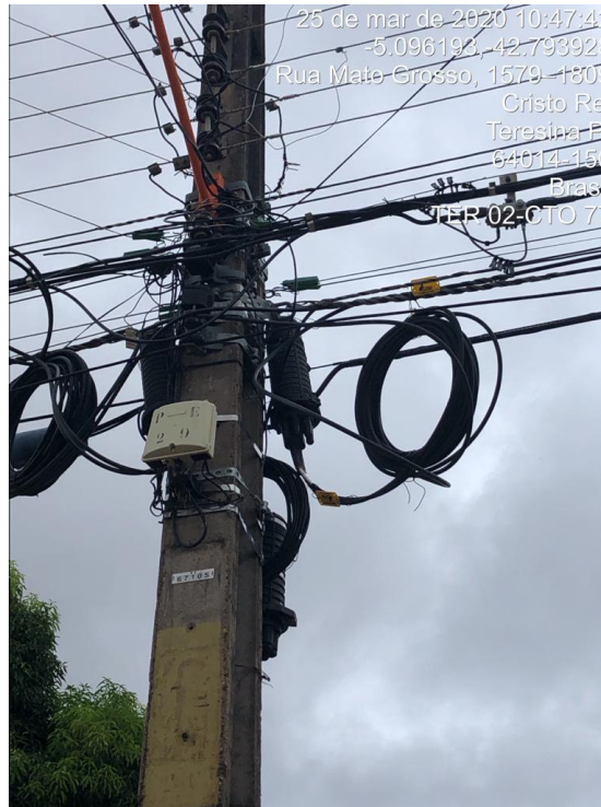
Figura 114 - TER 02-CTO 77 – falta cruzeta para reserva técnica.
