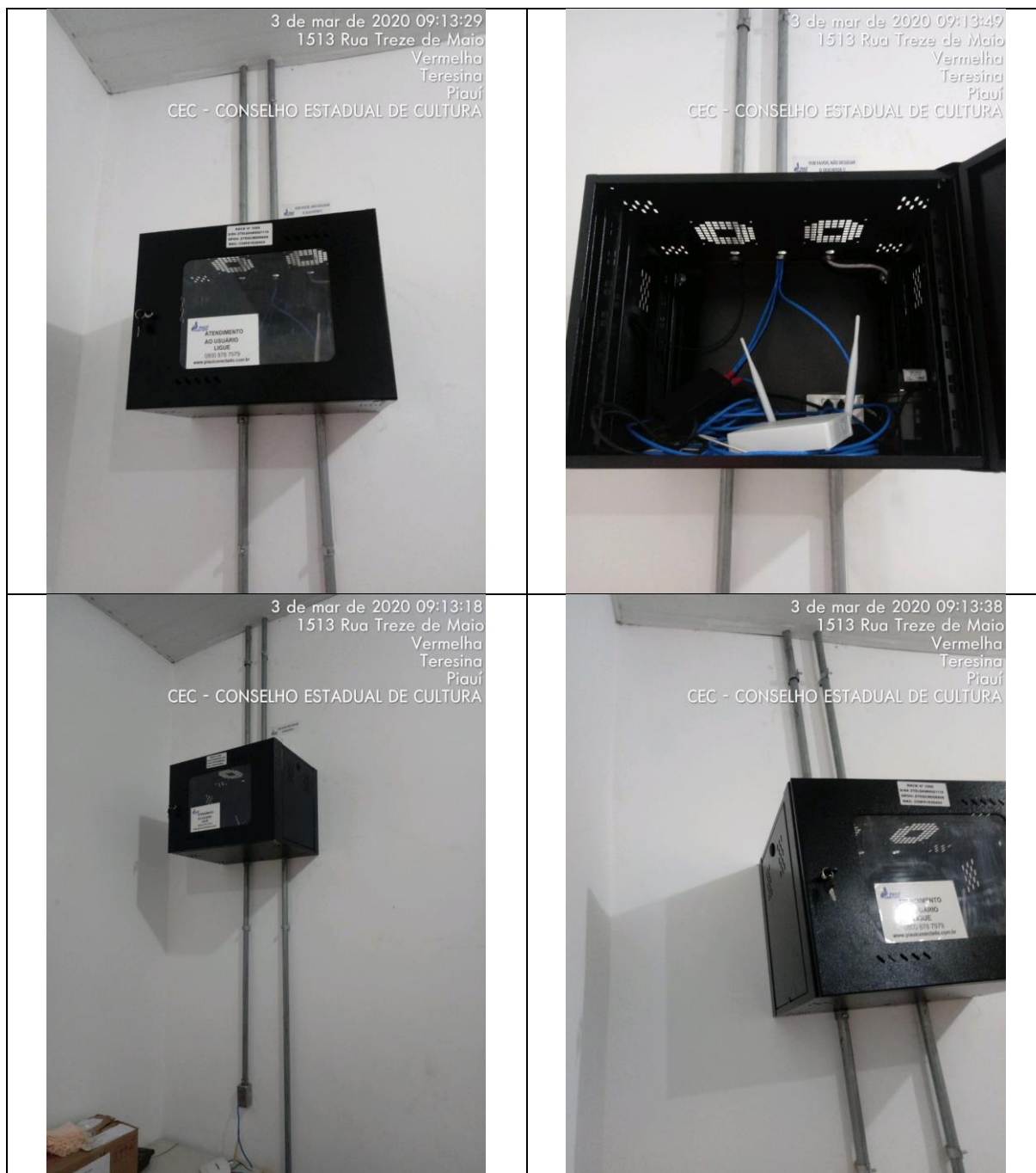
Figura 289 – PAG CONSELHO ESTADUAL DE CULTURA – TERESINA. NÃO CONFORMIDADE: AUSÊNCIA DE IDENTIFICAÇÃO DO RACK.
