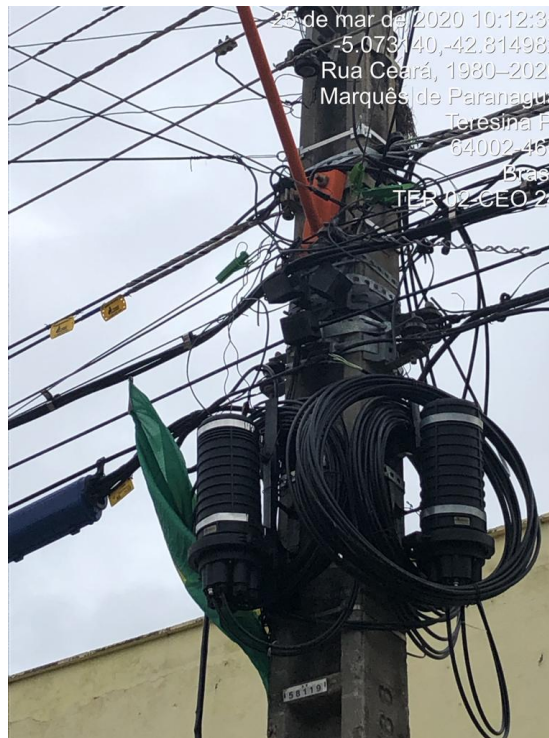
Figura 146 – TER 02-CEO 24 – ceo sem plaqueta de identificação
