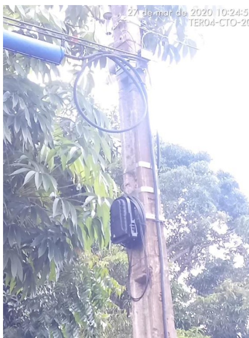
Figura 121 - TER 04-CTO 20 – cto sem plaquetas de identificação.
