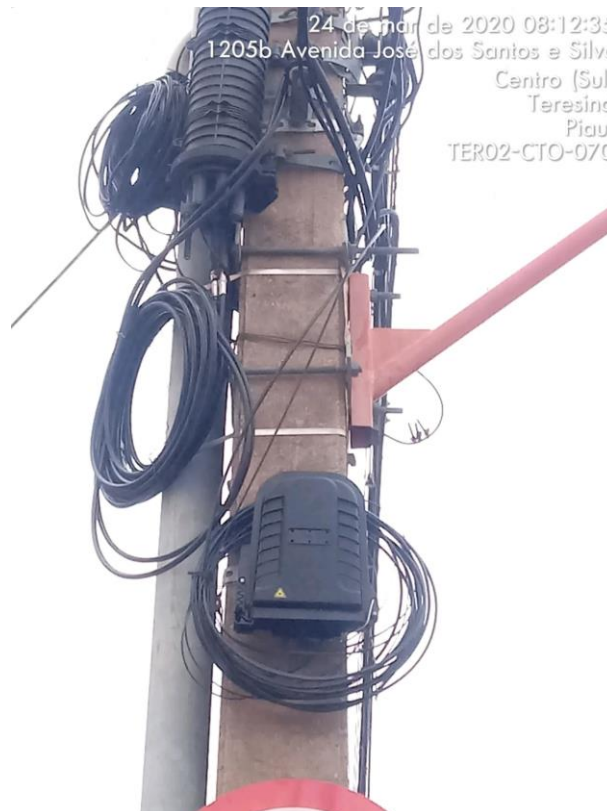
Figura 152 - TER 02-CTO 70 – sem plaqueta de identificação.
