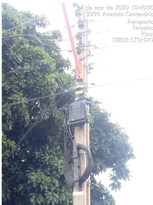
Figura 150 - TER 02-CTO 72 – sem plaqueta de identificação.
