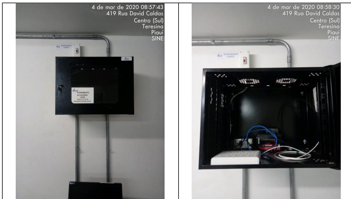
Figura 291 – PAG SINE BOULEVARD CENTER – TERESINA. NÃO CONFORMIDADE ENCONTRADA: AUSÊNCIA DE IDENTIFICAÇÃO DO RACK.
