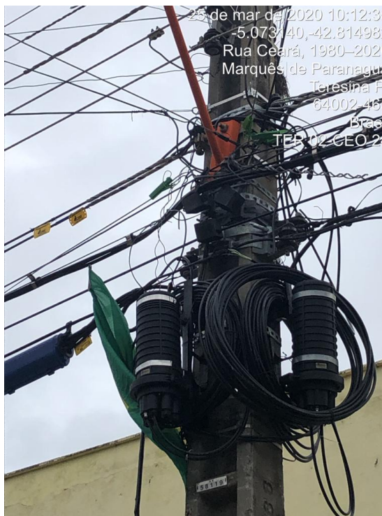
Figura 111 – TER 02-CEO 24 – ceo sem plaqueta de identificação
