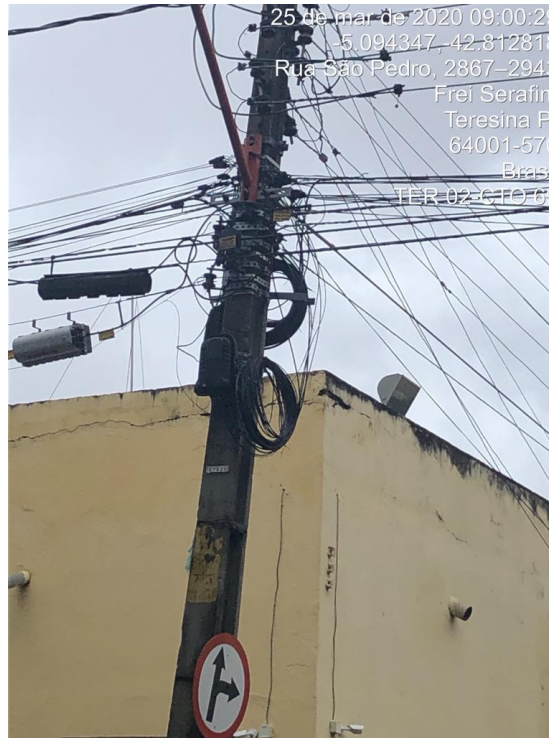
Figura 145 – TER 02-CEO 32 – ceo sem cruzeta para reserva técnica e sem plaqueta de identificação.
