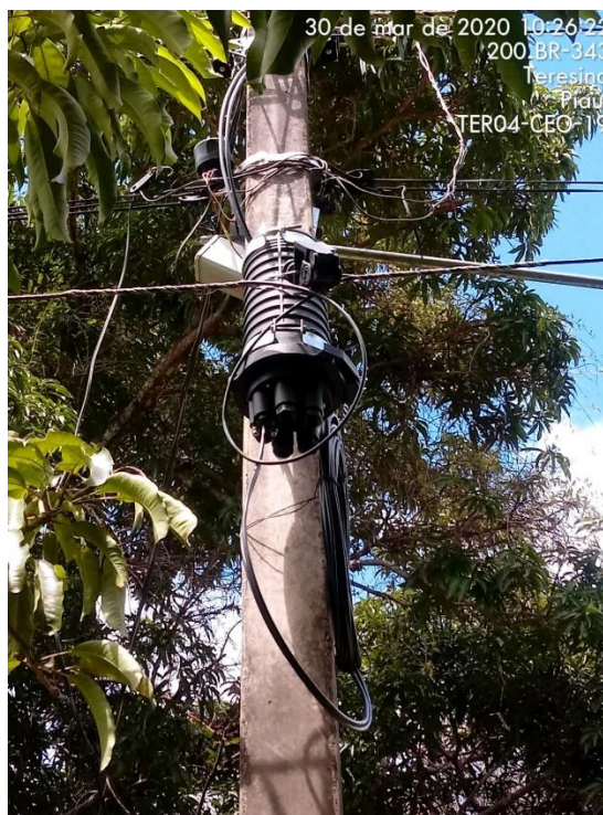
Figura 122 - TER 04-CEO 19 – ceo sem plaquetas de identificação e sem cruzeta pra reserva técnica.
