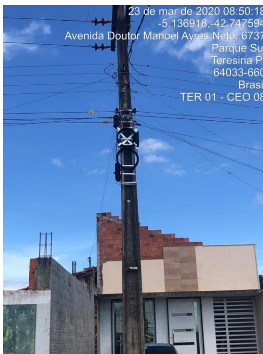
Figura 106 – TER 01-CEO 08 – ceo sem plaqueta de identificação.
