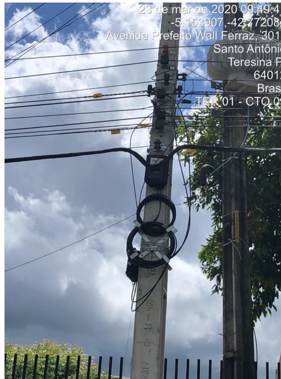
Figura 108 – TER 01-CTO 09 – cto sem plaqueta de identificação.
