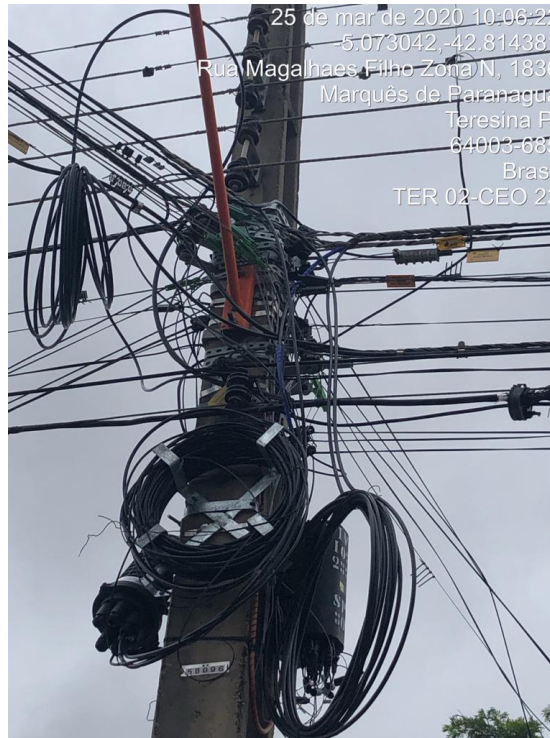
Figura 112 - TER 02-CEO 23 – ceo sem plaqueta de identificação
