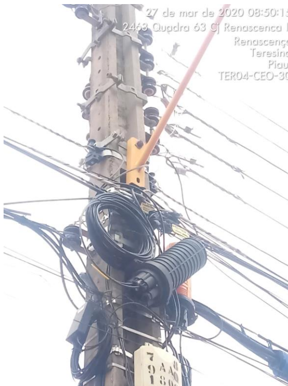
Figura 120 - TER 04-CEO 30 – ceo sem suporte e sem cruzeta para reserva tecnica.
