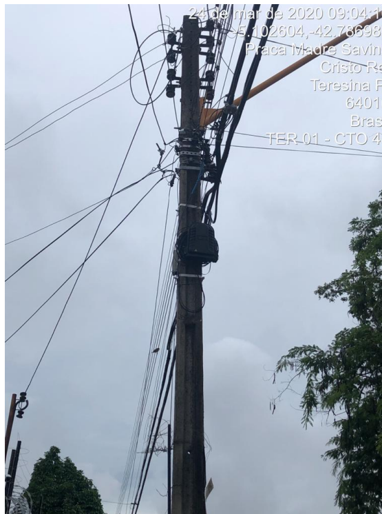
Figura 144 – TER 01-CTO 48 – cto sem plaqueta de identificação.
