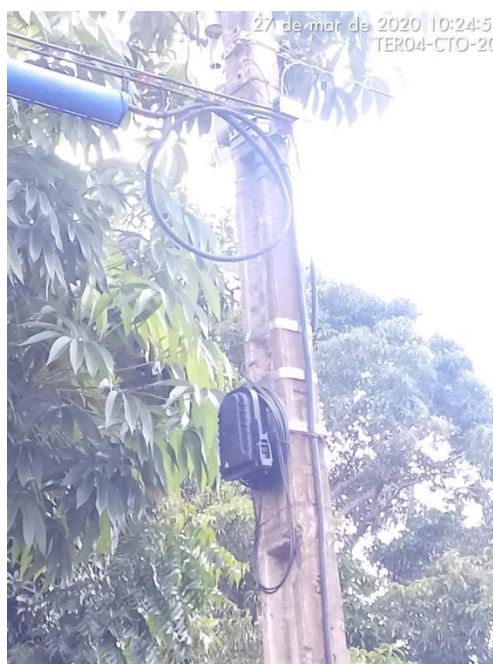
Figura 156 - TER 04-CTO 20 – cto sem plaquetas de identificação.
