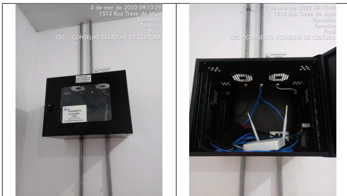
Figura 199 – PAG CONSELHO ESTADUAL DE CULTURA – TERESINA. NÃO CONFORMIDADE: AUSÊNCIA DE IDENTIFICAÇÃO DO RACK.
