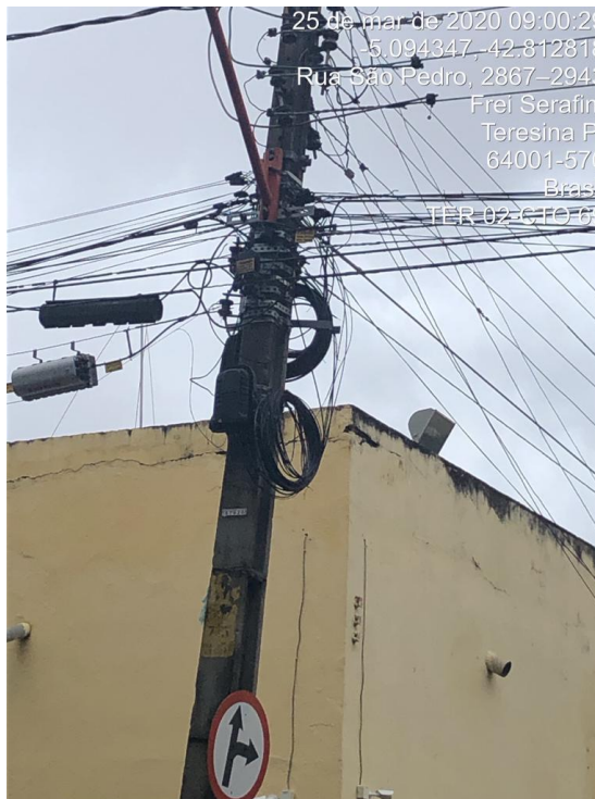
Figura 110 – TER 02-CEO 32 – ceo sem cruzeta para reserva técnica e sem plaqueta de identificação.
