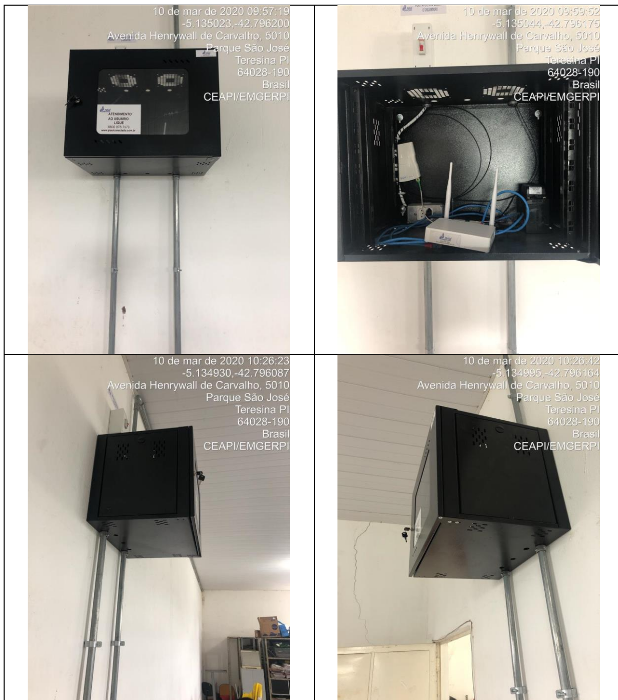
Figura 287 – PAG CEAPI/EMGERPI – TERESINA. Não conformidade encontrada: ausência de identificação do rack.
