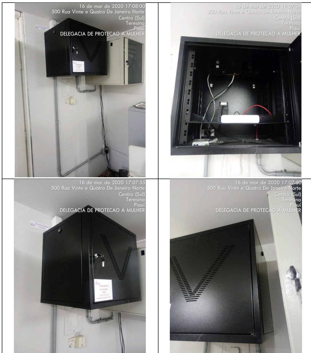
Figura 295 – PAG Delegacia de Proteção dos Direitos da Mulher-Centro – Teresina | Não Conformidade: Ausência de adesivo com identificação do rack
