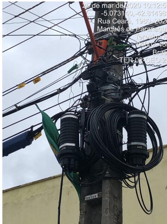
Figura 113 - TER 02-CEO 25 – ceo sem plaqueta de identificação
