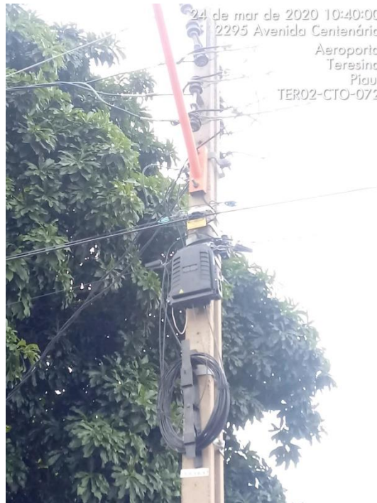
Figura 115 - TER 02-CTO 72 – sem plaqueta de identificação.
