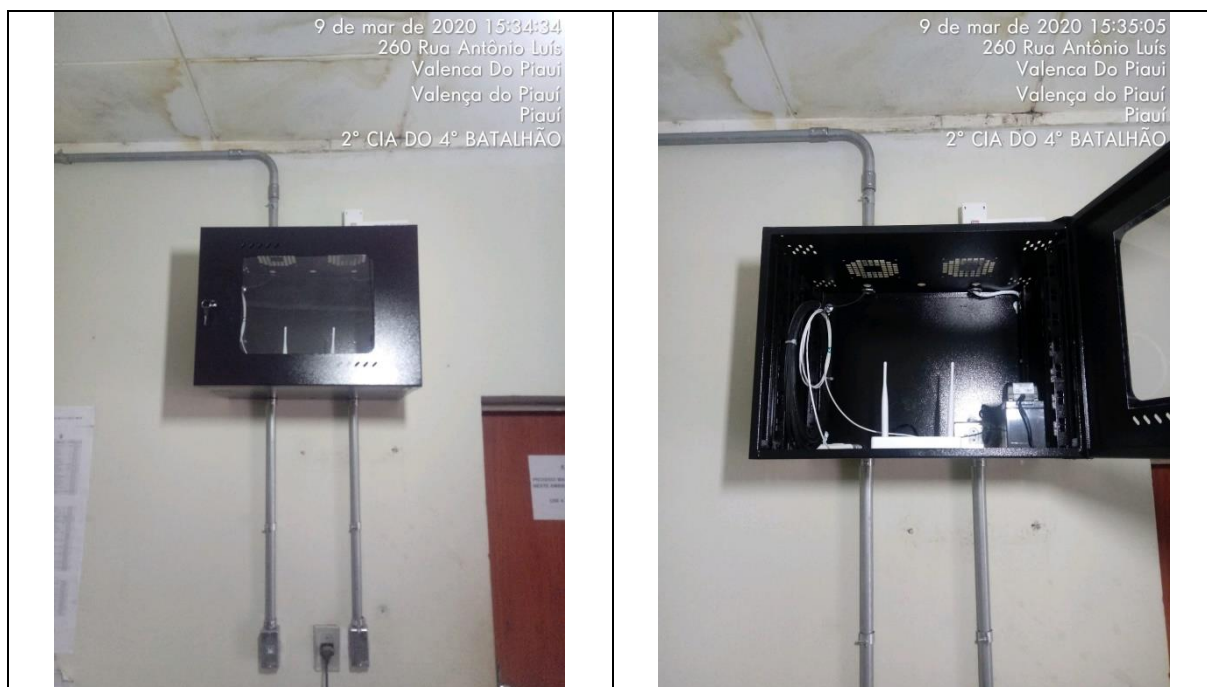
Figura 307 – PAG 2ª COMPANHIA DO 4º BATALHÃO DA POLÍCIA MILITAR – VALENÇA DO PIAUÍ. NÃO CONFORMIDADE ENCONTRADA: AUSÊNCIA DE ADESIVO COM CONTATO PARA SUPORTE.
