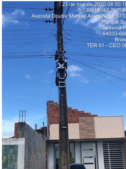
Figura 141 – TER 01-CEO 08 – ceo sem plaqueta de identificação.
