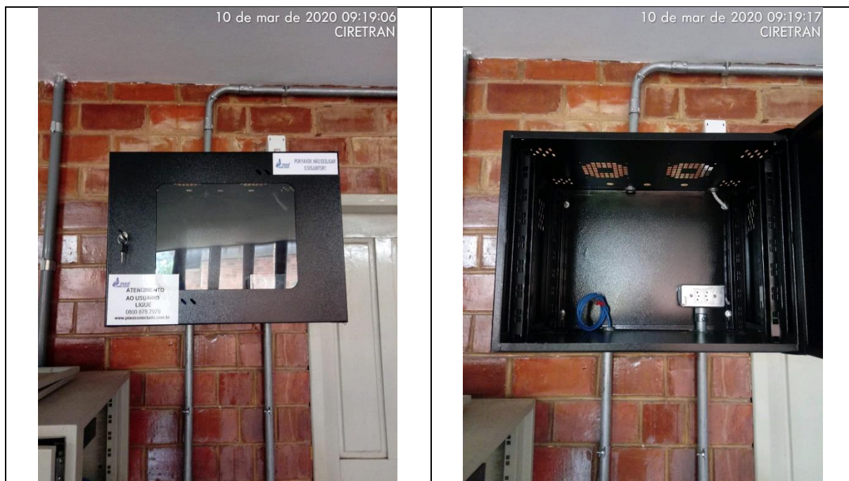
Figura 313 – PAG CIRETRAN – VALENÇA DO PIAUÍ. NÃO CONFORMIDADES: AUSÊNCIA DE PONTO DE TERMINAÇÃO ÓPTICA E AUSÊNCIA DE ONU.
