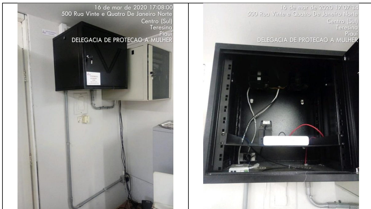
Figura 205 – PAG Delegacia de Proteção dos Direitos da Mulher-Centro – Teresina | Não Conformidade: Ausência de adesivo com identificação do rack
