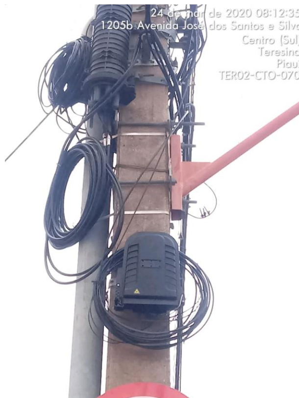
Figura 117 - TER 02-CTO 70 – sem plaqueta de identificação.
