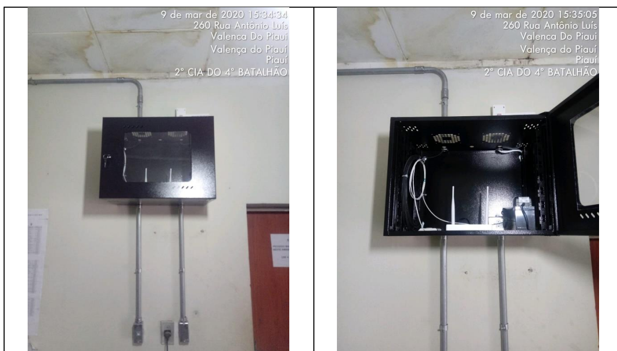
Figura 217 – PAG 2ª COMPANHIA DO 4º BATALHÃO DA POLÍCIA MILITAR – VALENÇA DO PIAUÍ. NÃO CONFORMIDADE ENCONTRADA: AUSÊNCIA DE ADESIVO COM CONTATO PARA SUPORTE.
