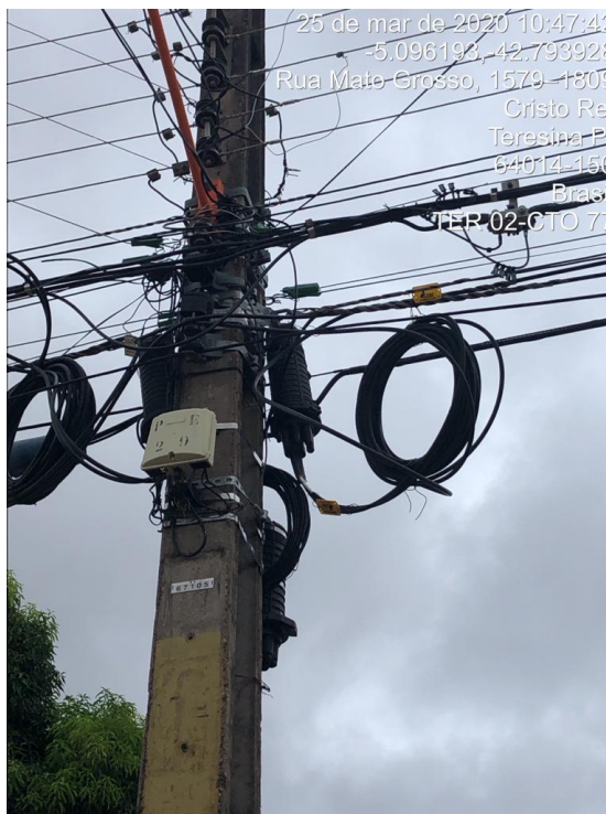
Figura 149 - TER 02-CTO 77 – falta cruzeta para reserva técnica.
