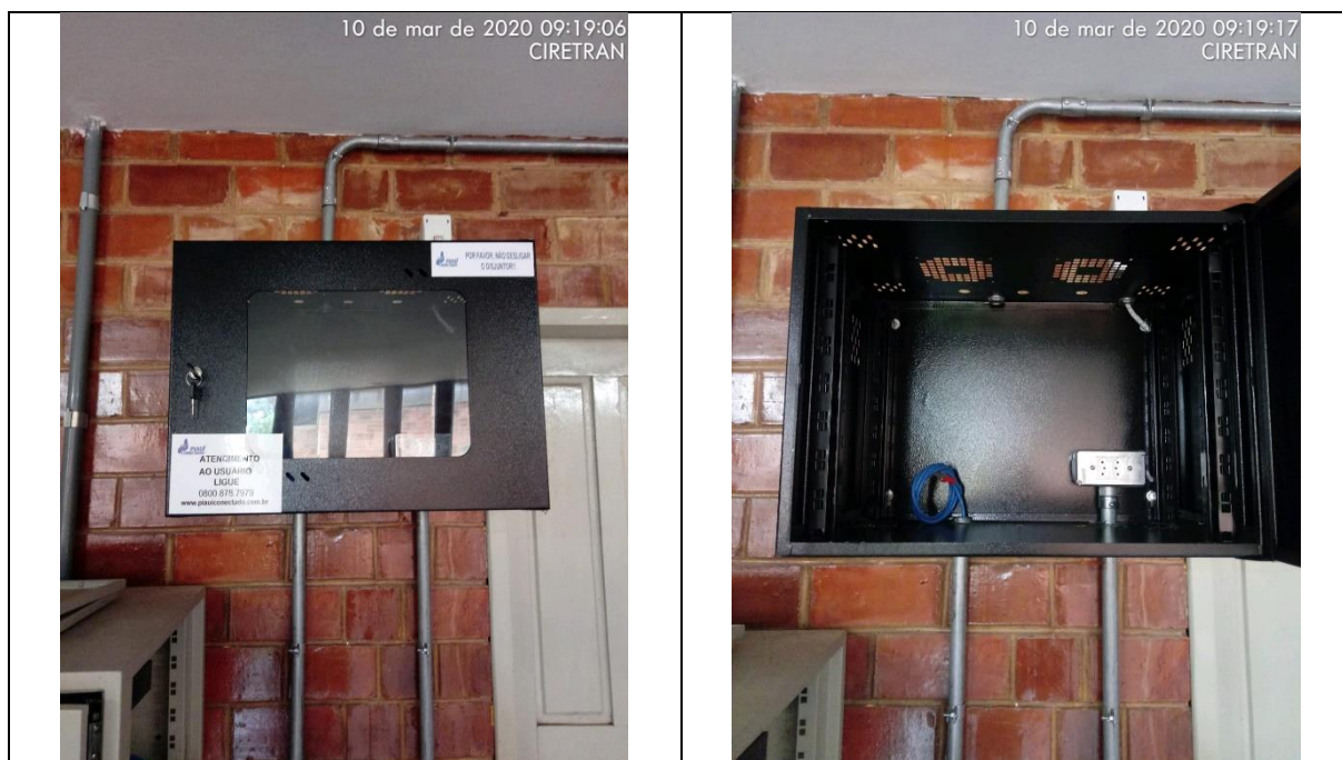
Figura 223 – PAG CIRETRAN – VALENÇA DO PIAUÍ. NÃO CONFORMIDADES: AUSÊNCIA DE PONTO DE TERMINAÇÃO ÓPTICA E AUSÊNCIA DE ONU.
