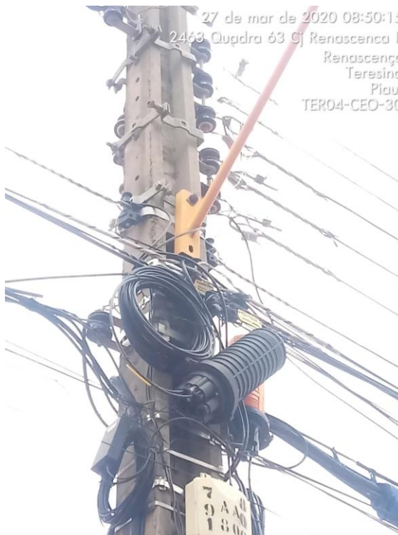
Figura 155 - TER 04-CEO 30 – ceo sem suporte e sem cruzeta para reserva tecnica.
