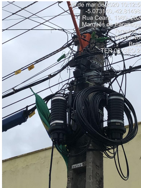
Figura 148 - TER 02-CEO 25 – ceo sem plaqueta de identificação
