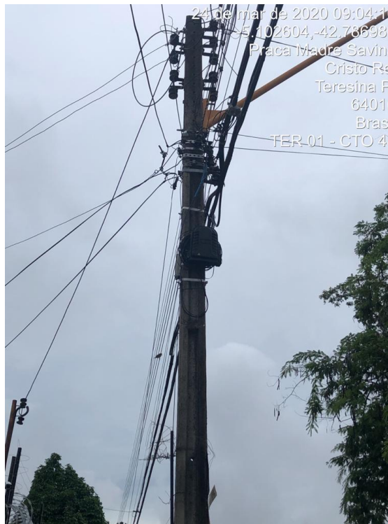
Figura 109 – TER 01-CTO 48 – cto sem plaqueta de identificação.
