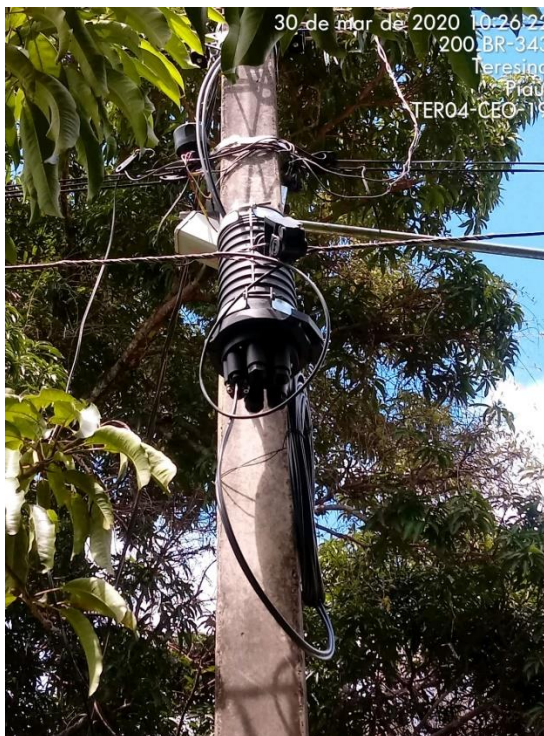
Figura 157 - TER 04-CEO 19 – ceo sem plaquetas de identificação e sem cruzeta para reserva técnica.
