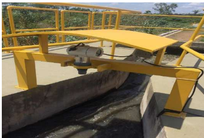
Medidor de vazão instalado
