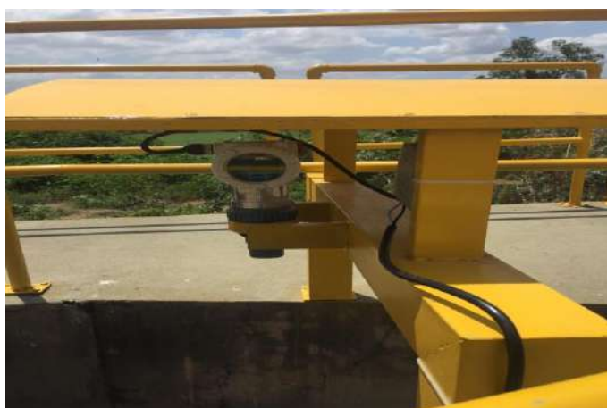
Medidor de vazão Instalado
