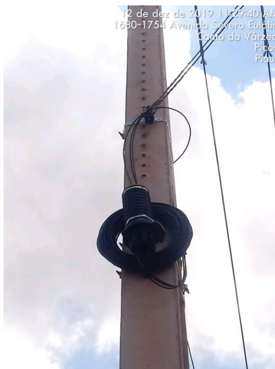
Imagem 24 – PIC-PRI-06 – Ausência de placa de identificação
