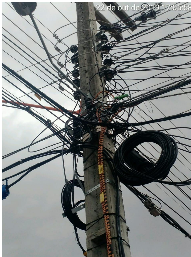
Imagem 30 – TER 03 – CTO – 021 – Ausência de Placa de Identificação do cabo Lançado
