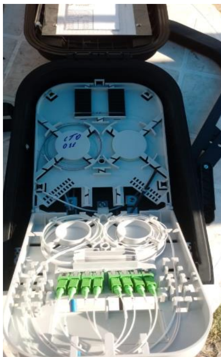
Imagem 5 – Caixa de Terminação Óptica (CTO)
