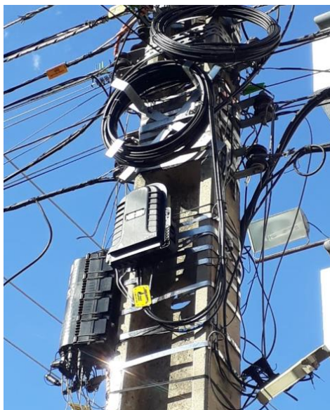
Imagem 6 – CTO já instalada fazendo a junção dos cabos de Backbone com os cabos DROP
