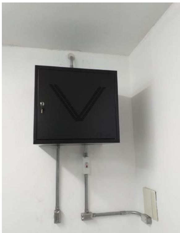
Imagem 2 – Rack interno acomodando um ponto de Terminação Óptica, ponto de tomada dupla, um disjuntor de proteção elétrica e uma ONU
