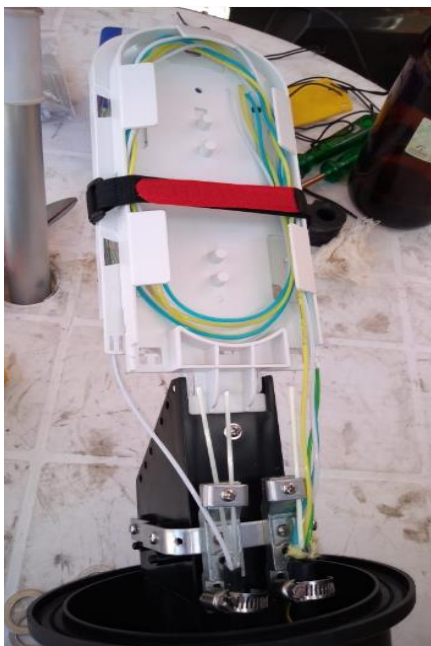
Imagem 3 – Caixa de Emenda Óptica (CEO)
