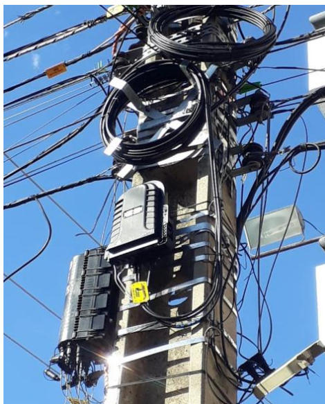
Imagem 6 – CTO já instalada fazendo a junção dos cabos de backhone com os cabos DROP
