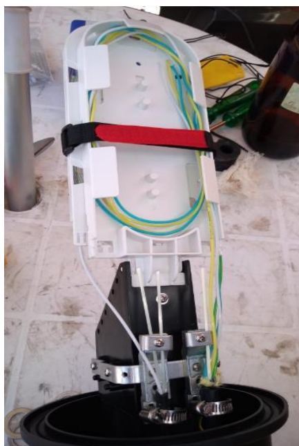
Imagem 3 – Caixa de Emenda Óptica (CEO)
