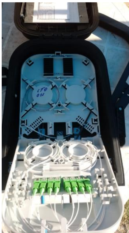
Imagem 5 – Caixa de Terminação Óptica (CTO)
