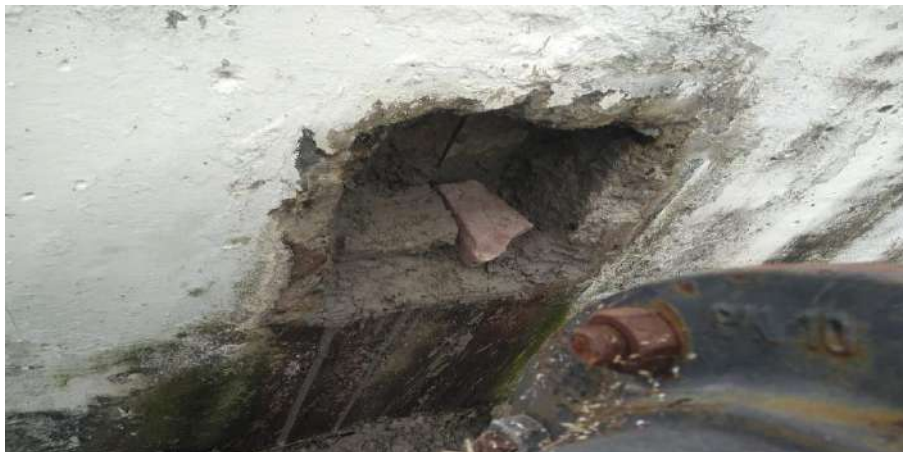
Local do vazamento no reator da ETE Torquato Neto
