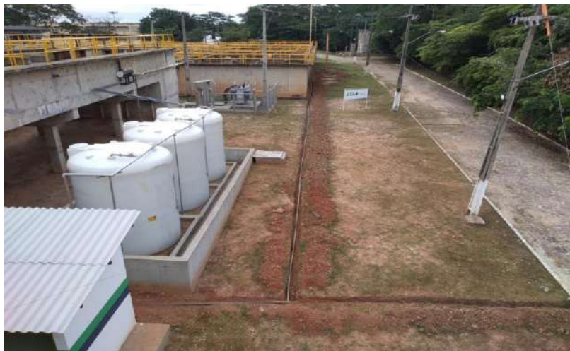
Nova linha de Cloração para os Canais de Água Decantada da ETA IV
