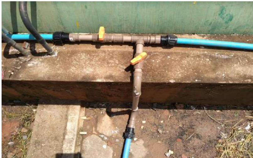
Derivação para a nova linha de cloração para o canal de água decantada na ETA III
