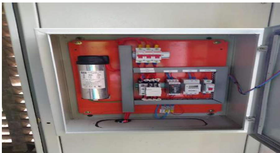
Banco de capacitores EEAT Parque da Cidade
