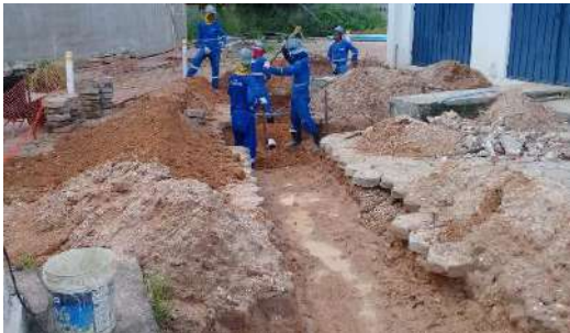
Reservatório Parque Piauí - vala para passagem de tubulação dos cabos do painel que será instalado para as bombas do reservatório.
