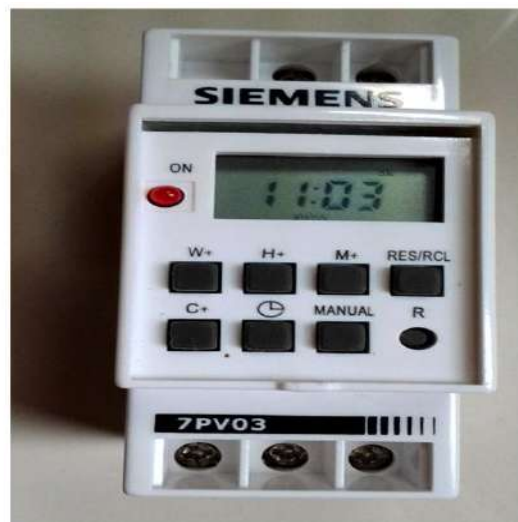
Dispositivos temporizadores instalados
