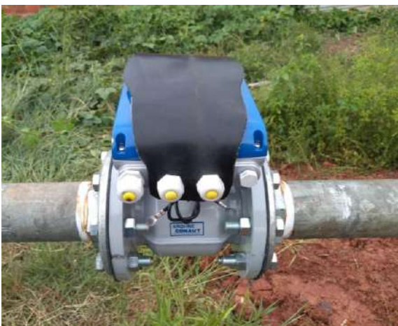
Macromedidor Instalado com proteção
