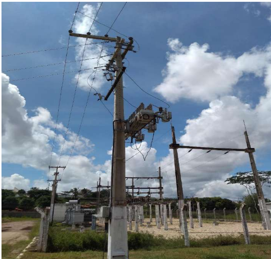
Banco de capacitores ETA SUL
