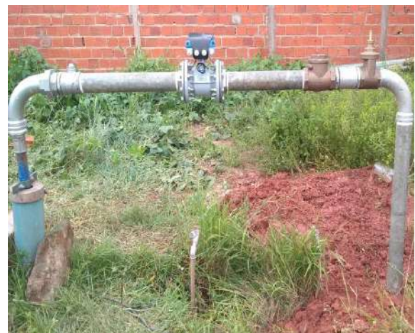
Barrilete com o macromedidor já instalados
