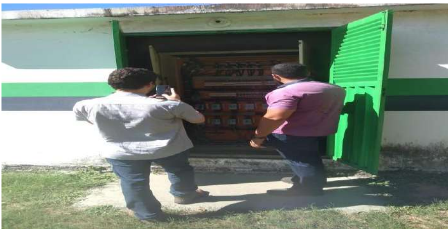
Durante a visita da ARSETE foi explicado sobre o funcionamento da elevatória e as melhorias realizadas
