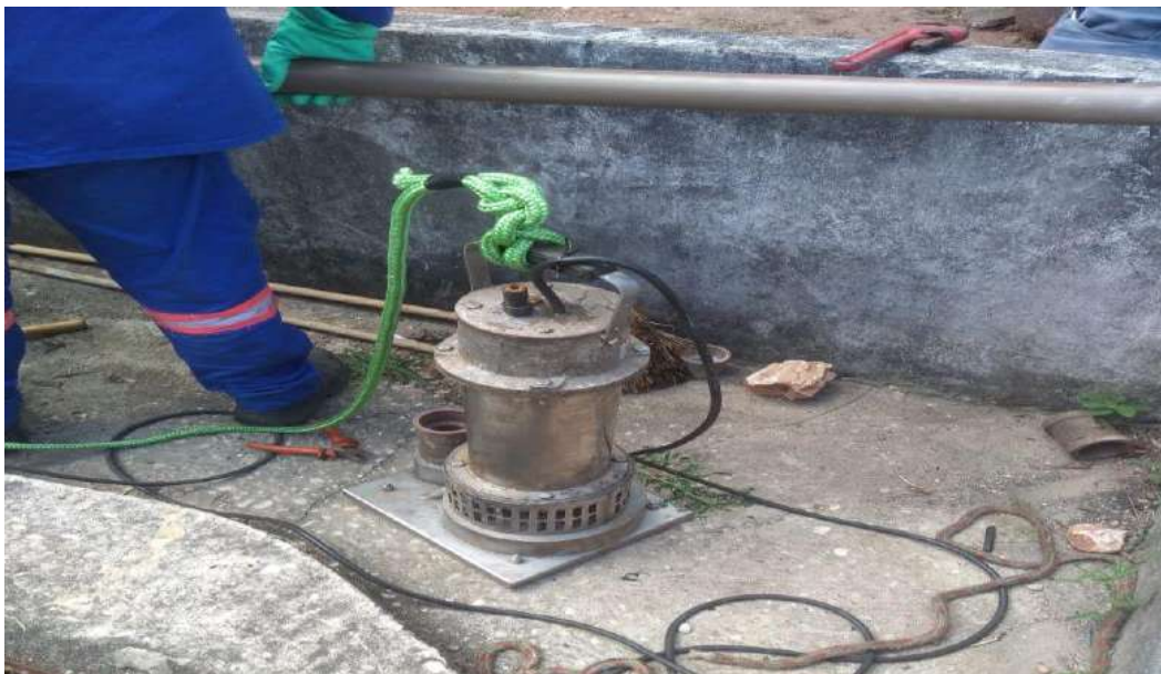
Bomba reserva da ETE Bosque Residencial
