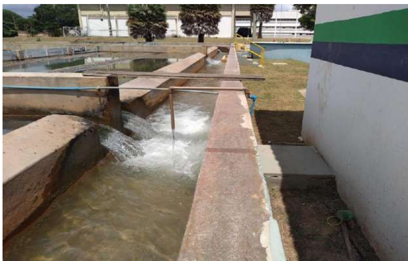
Ponto de cloração no canal de água decantada ETA III
