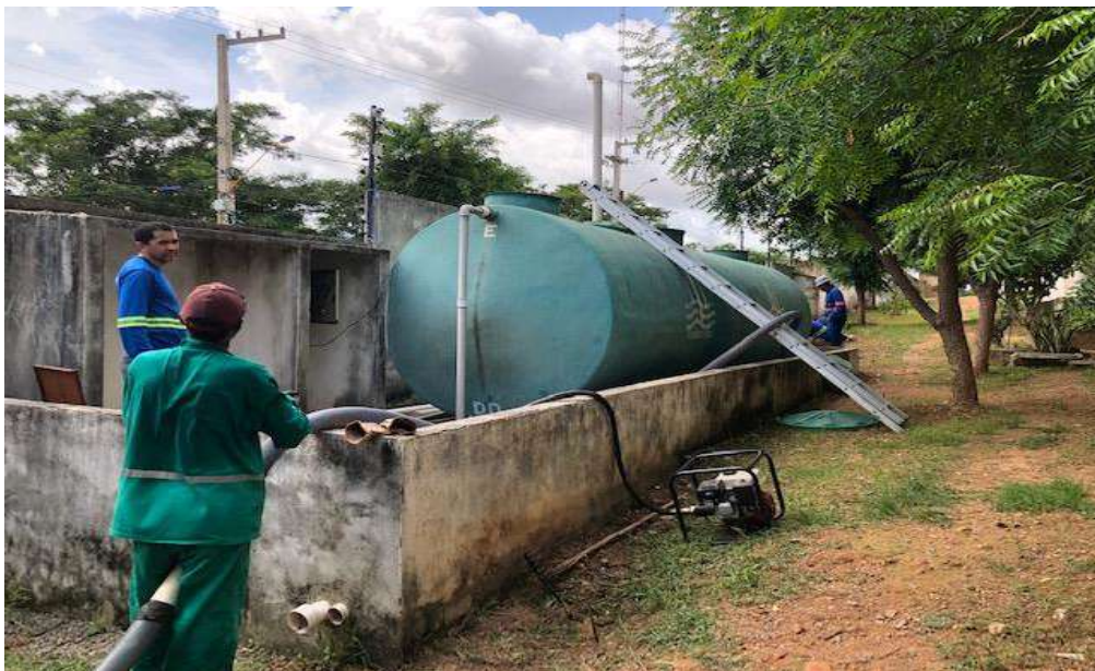
ETE do Condomínio Bosque Residencial Durante processo de limpeza e manutenção para início da operação.
