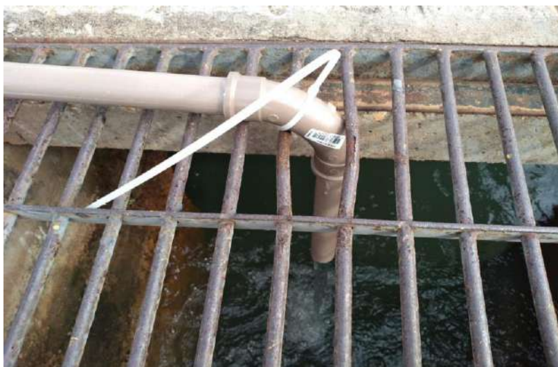
Um ponto de Cloração nos Canais de Água Decantada da ETA IV
