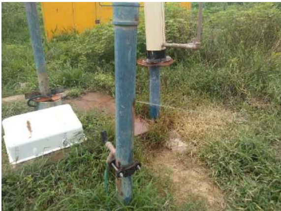
Barrilete apresentando vazamento (Antes)
