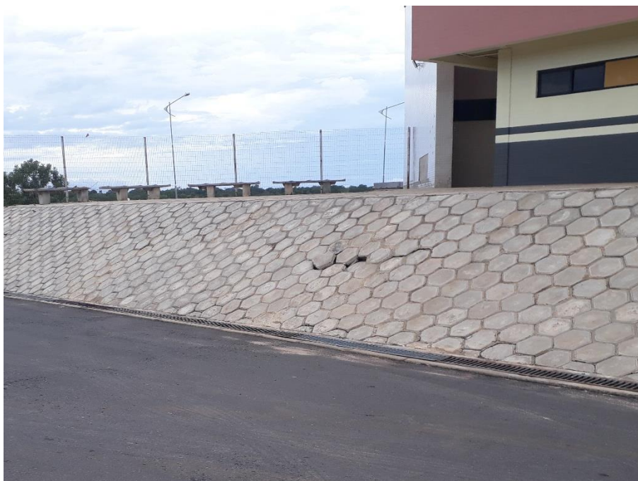
Figura 11: Bloquete do talude recalcado
