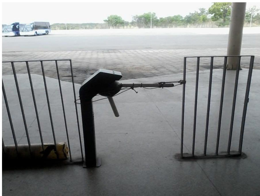
Figura 13: Catracas com defeito
