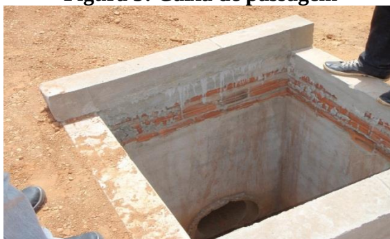
Figura 5: Caixa de passagem
