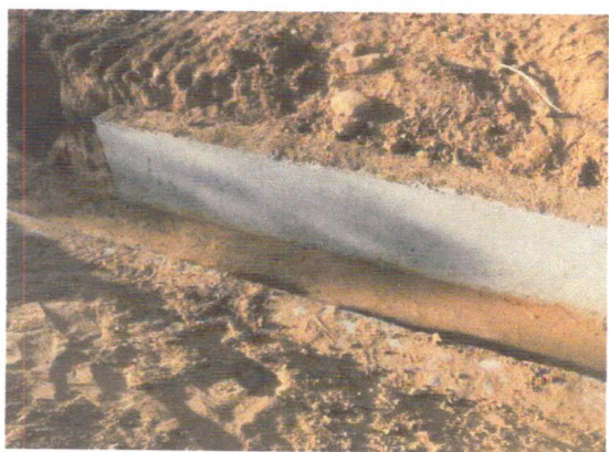
Dissipador de energia
