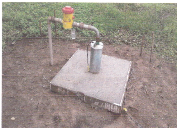
Proteção do poço tubular.
